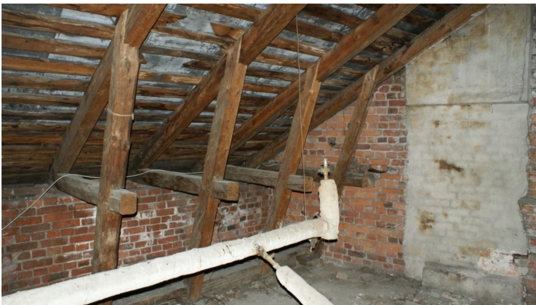
22. «Жилой дом А.В. Шушина», Ленинградская область, Выборгский район, г. Выборг, ул. Красноармейская, д. 9. Чердак. Фрагмент. Фото 30.11.2021г.
