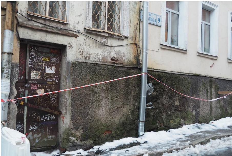
8. «Жилой дом А.В. Шушина», Ленинградская область, Выборгский район, г. Выборг, ул. Красноармейская, д. 9. Северо-западный фасад. Фрагмент. Фото 30.11.2021г.
