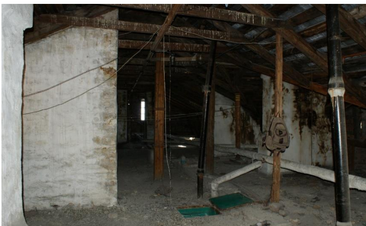
18. «Жилой дом А.В. Шушина», Ленинградская область, Выборгский район, г. Выборг, ул. Красноармейская, д. 9. Чердак. Общий вид. Фото 30.11.2021г.
