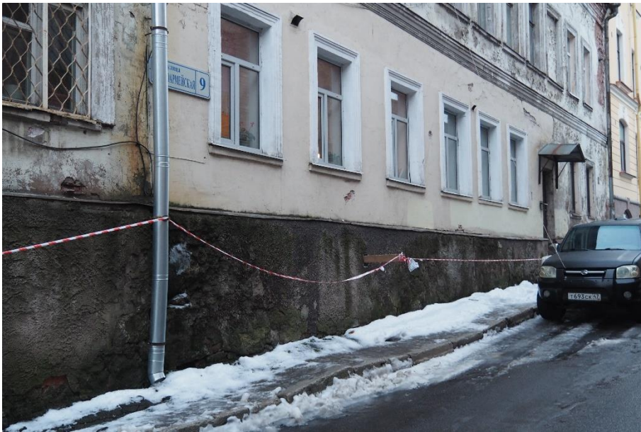
3. «Жилой дом А.В. Шушина», Ленинградская область, Выборгский район, г. Выборг, ул. Красноармейская, д. 9. Северо-западный фасад. Фрагмент. Фото 30.11.2021г.
