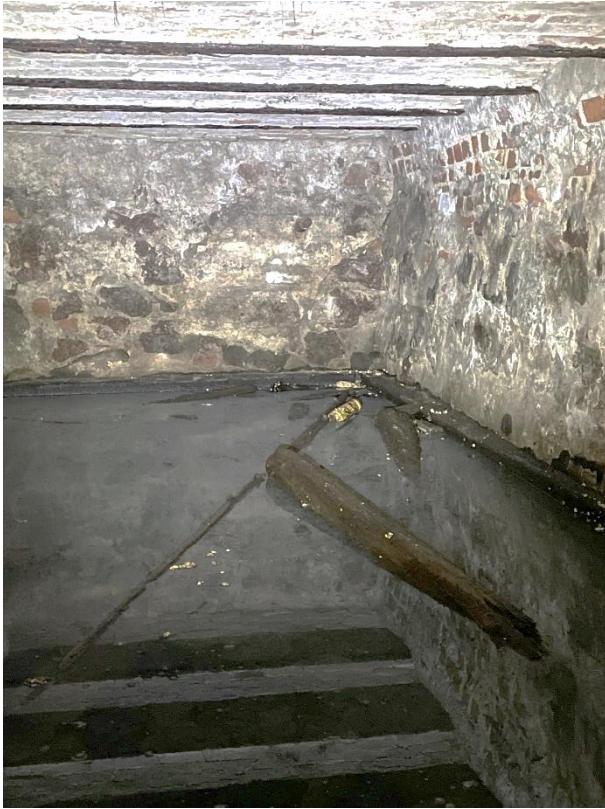
16. «Жилой дом б.М. Хакман», Ленинградская область, Выборгский район, г. Выборг, ул. Красноармейская, д. 14. Подвал. Фрагмент. Фото 30.11.2021г.
