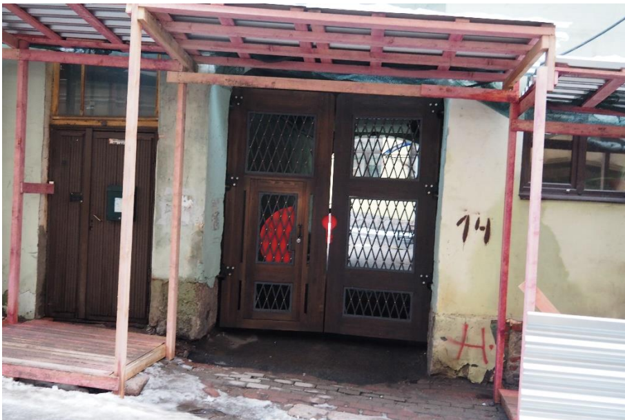
4. «Жилой дом б.М. Хакман», Ленинградская область, Выборгский район, г. Выборг, ул. Красноармейская, д. 14. Юго-восточный фасад. Фрагмент. Фото 30.11.2021г.
