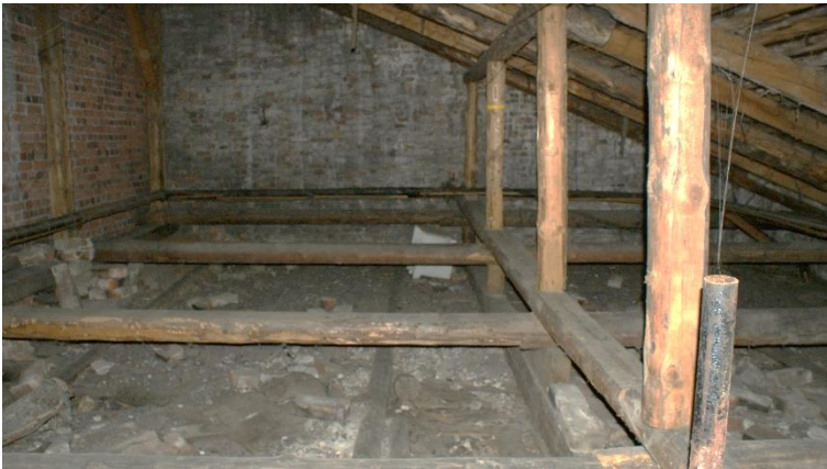
28. «Жилой дом б.М. Хакман», Ленинградская область, Выборгский район, г. Выборг, ул. Красноармейская, д. 14. Чердак. Фрагмент. Фото 30.11.2021г.
