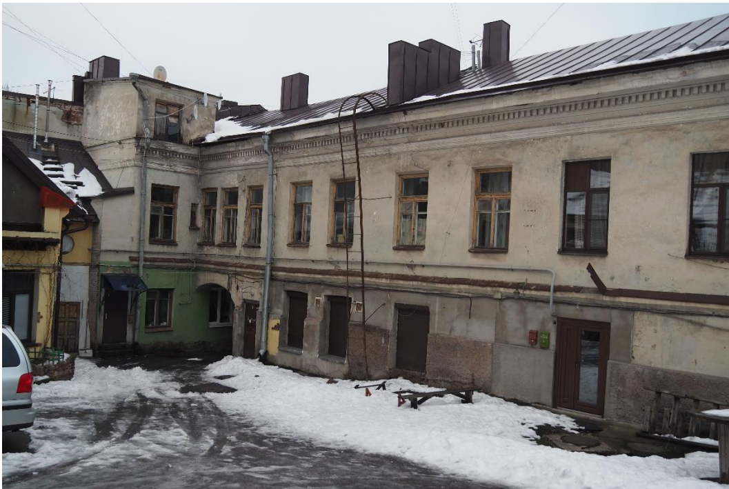
8. «Жилой дом б.М. Хакман», Ленинградская область, Выборгский район, г. Выборг, ул. Красноармейская, д. 14. Дворовый фасад. Общий вид. Фото 30.11.2021г.
