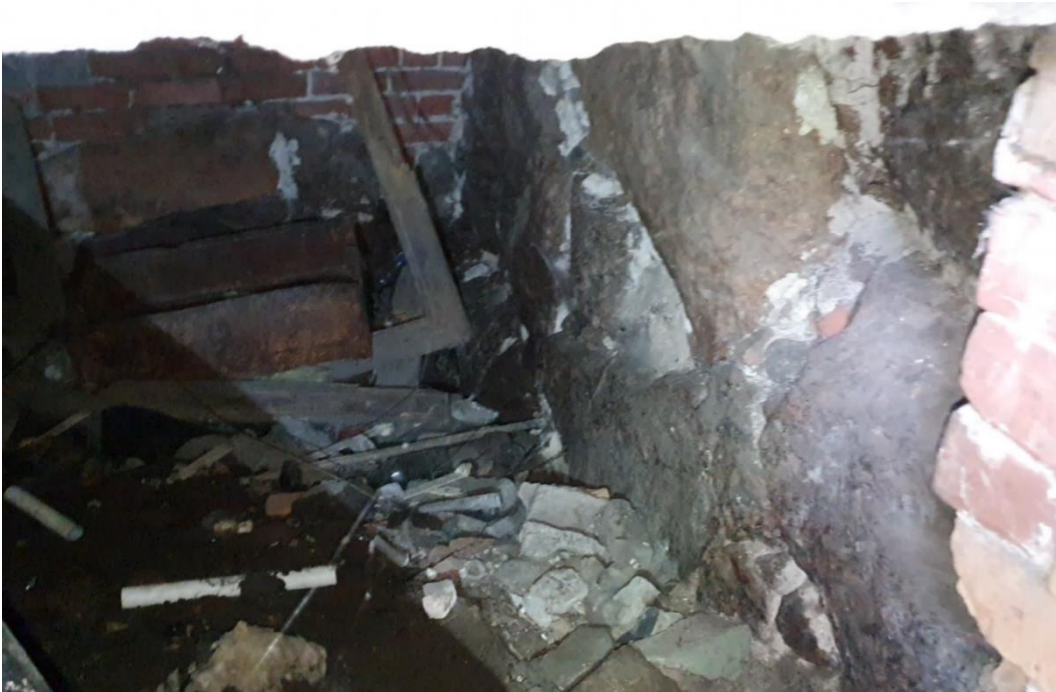
17. «Жилой дом б.М. Хакман», Ленинградская область, Выборгский район, г. Выборг, ул. Красноармейская, д. 14. Подвал. Фрагмент. Фото 30.11.2021г.
