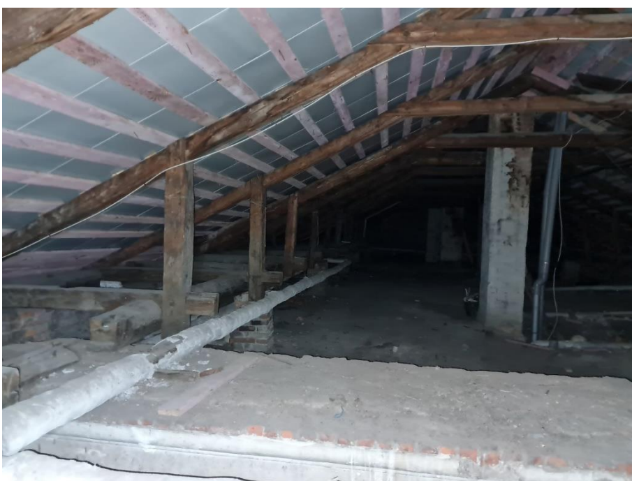
19. «Жилой дом б.М. Хакман», Ленинградская область, Выборгский район, г. Выборг, ул. Красноармейская, д. 14. Чердак. Общий вид. Фото 30.11.2021г.
