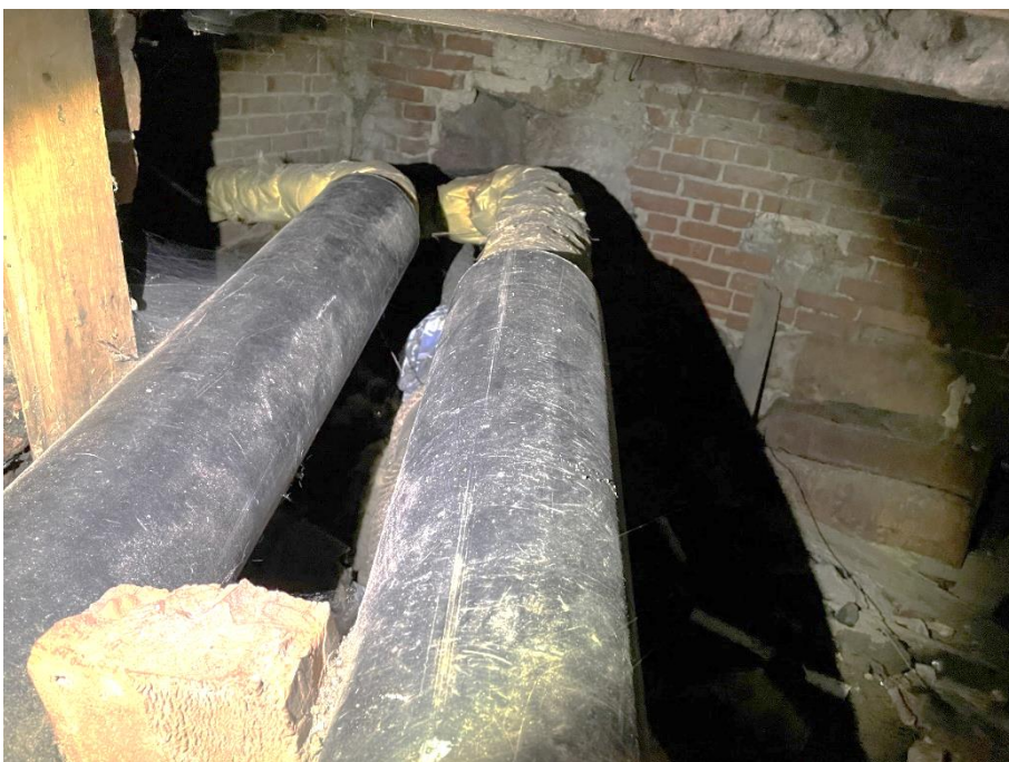
18. «Жилой дом б.М. Хакман», Ленинградская область, Выборгский район, г. Выборг, ул. Красноармейская, д. 14. Подвал. Фрагмент. Фото 30.11.2021г.
