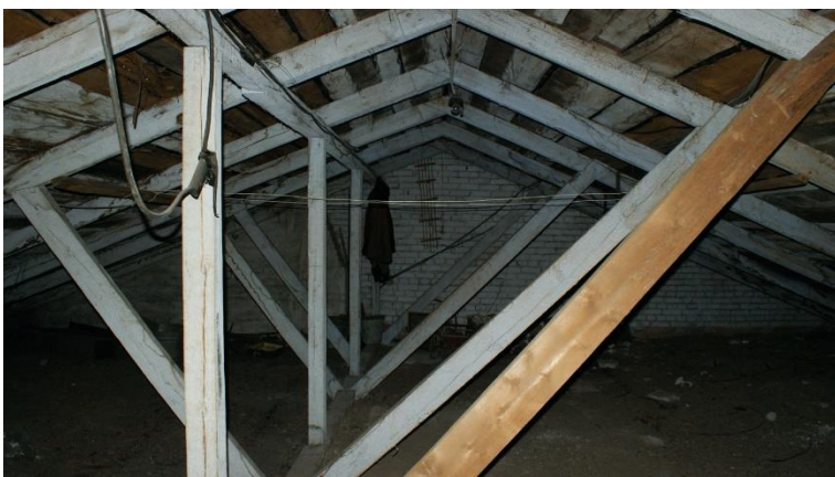
16. «Военно-сиротский дом», Ленинградская область, Выборгский район, г. Выборг, ул. Крепостная, д. 21. Чердак. Общий вид. Фото 30.11.2021г.
