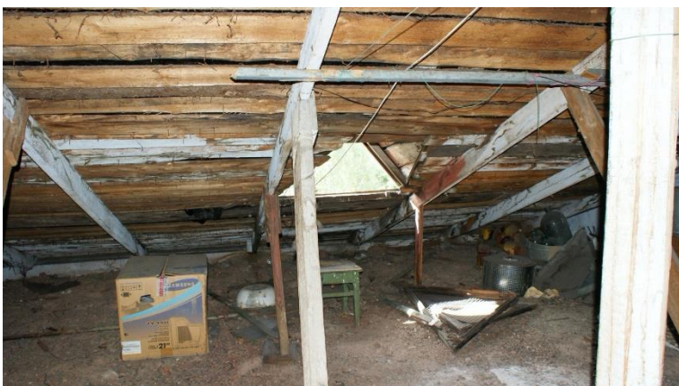
18. «Военно-сиротский дом», Ленинградская область, Выборгский район, г. Выборг, ул. Крепостная, д. 21. Чердак. Фрагмент. Фото 30.11.2021г.
