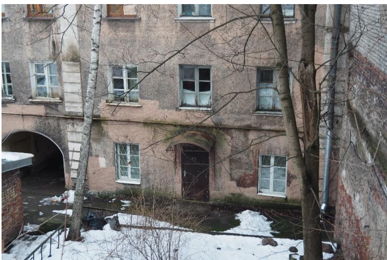
8. «Военно-сиротский дом», Ленинградская область, Выборгский район, г. Выборг, ул. Крепостная, д. 21. Дворовый фасад. Фрагмент. Фото 30.11.2021г.
