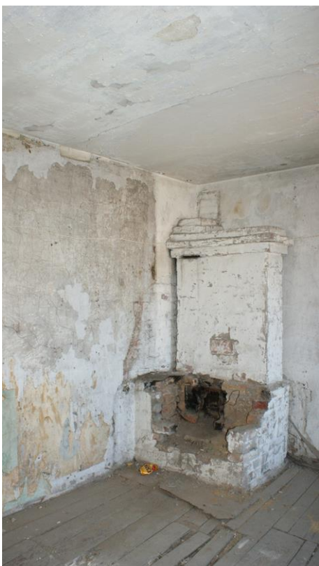
42. «Жилой дом И. Франкехаузера», Ленинградская область, Выборгский район, г. Выборг, ул. Сторожевой башни, д. 10. Чердак. Фрагмент. Фото 30.11.2021г.
