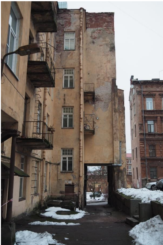
26. «Жилой дом И. Франкехаузера», Ленинградская область, Выборгский район, г. Выборг, ул. Сторожевой башни, д. 10. Дворовый фасад. Фрагмент. Фото 30.11.2021г.
