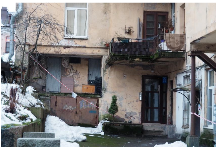
21. «Жилой дом И. Франкехаузера», Ленинградская область, Выборгский район, г. Выборг, ул. Сторожевой башни, д. 10. Дворовый фасад. Фрагмент. Фото 30.11.2021г.
