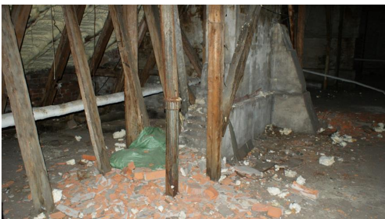
52. «Жилой дом И. Франкехаузера», Ленинградская область, Выборгский район, г. Выборг, ул. Сторожевой башни, д. 10. Чердак. Фрагмент. Фото 30.11.2021г.
