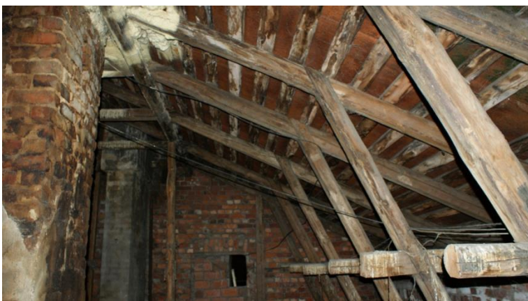
44. «Жилой дом И. Франкехаузера», Ленинградская область, Выборгский район, г. Выборг, ул. Сторожевой башни, д. 10. Чердак. Фрагмент. Фото 30.11.2021г.
