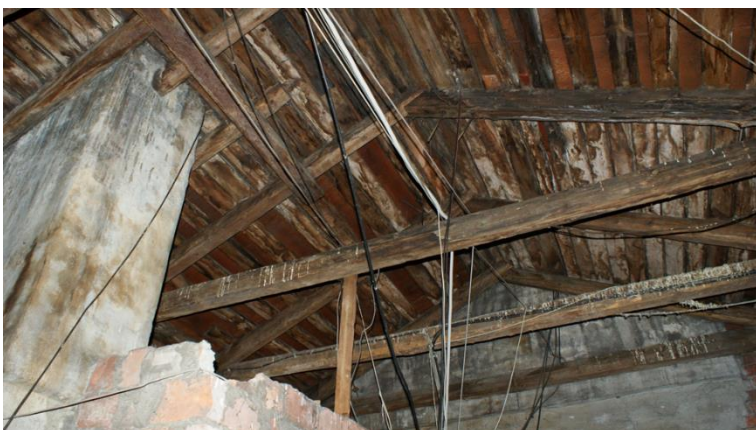
49. «Жилой дом И. Франкехаузера», Ленинградская область, Выборгский район, г. Выборг, ул. Сторожевой башни, д. 10. Чердак. Фрагмент. Фото 30.11.2021г.
