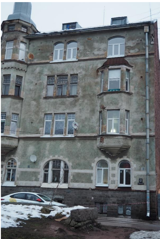
4. «Жилой дом», Ленинградская область, Выборгский район, г. Выборг, ул. Сторожевой башни, д. 12. Юго-западный фасад. Фрагмент. Фото 30.11.2021г.
