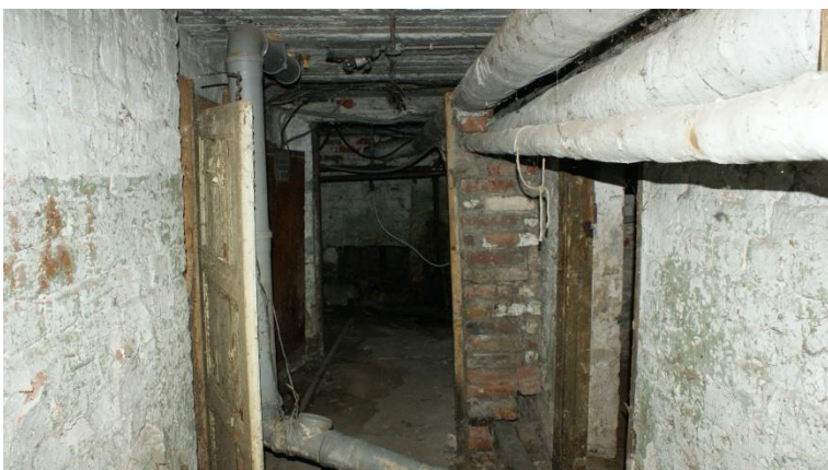
21. «Жилой дом», Ленинградская область, Выборгский район, г. Выборг, ул. Сторожевой башни, д. 12. Подвал. Общий вид. Фото 30.11.2021г.
