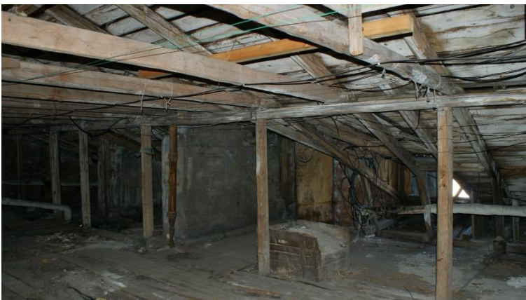
28. «Жилой дом», Ленинградская область, Выборгский район, г. Выборг, ул. Сторожевой башни, д. 12. Чердак. Общий вид. Фото 30.11.2021г.
