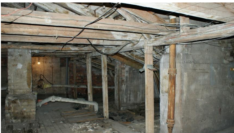
30. «Жилой дом», Ленинградская область, Выборгский район, г. Выборг, ул. Сторожевой башни, д. 12. Чердак. Общий вид. Фото 30.11.2021г.
