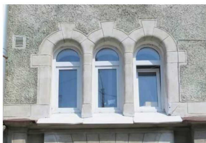
Оконные проемы 2-го яруса (1-го этажа) над аркой. Лицевой Ю-3 фасад, левая часть
