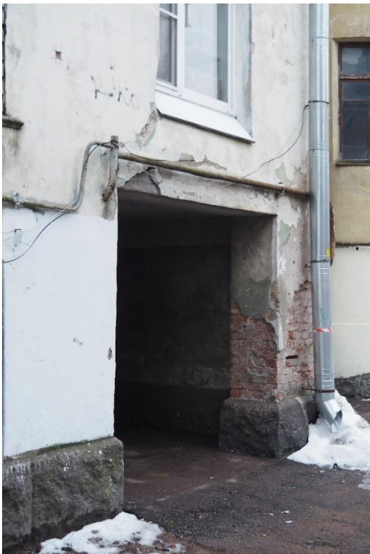
16. «Жилой дом», Ленинградская область, Выборгский район, г. Выборг, ул. Сторожевой башни, д. 12. Дворовый фасад. Фрагмент. Фото 30.11.2021г.
