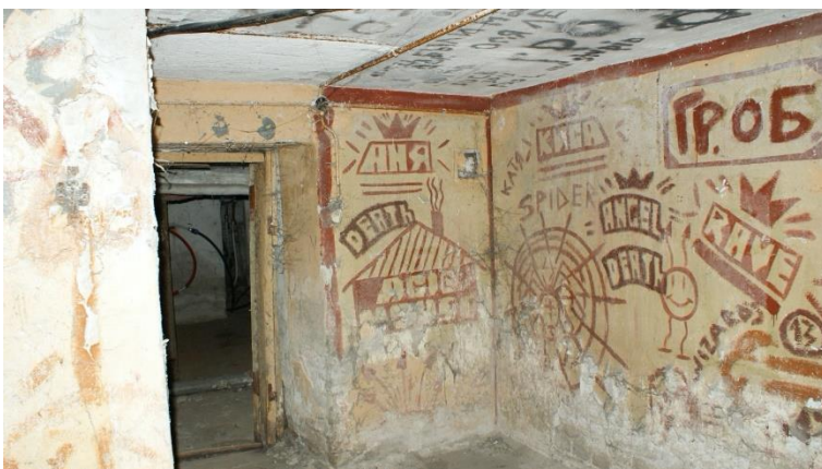
24. «Жилой дом», Ленинградская область, Выборгский район, г. Выборг, ул. Сторожевой башни, д. 12. Подвал. Общий вид. Фото 30.11.2021г.
