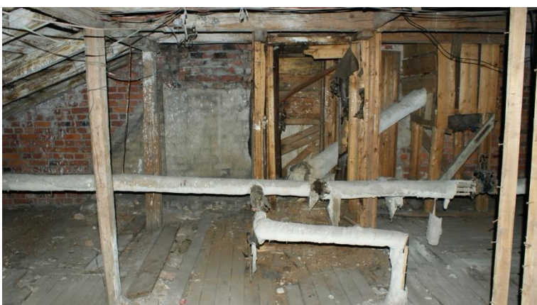
33. «Жилой дом», Ленинградская область, Выборгский район, г. Выборг, ул. Сторожевой башни, д. 12. Чердак. Фрагмент. Фото 30.11.2021г.
