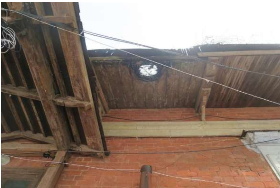
14. Караулка у Березовых ворот. Свес кровли бокового фасада. Видны резные кобылки, кронштейны под ними и место водосточной трубы. Примыкание крыши навеса к стене здания.
