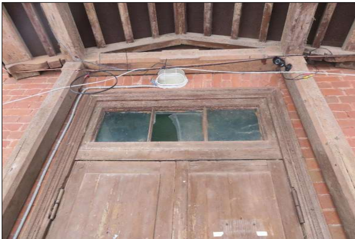
11. Караулка у березовых ворот. Навес над крыльцом и сохранившаяся входная дверь с остекленной фрамугой. Видны конструкции стропил, обрешетка, цветное решение.
