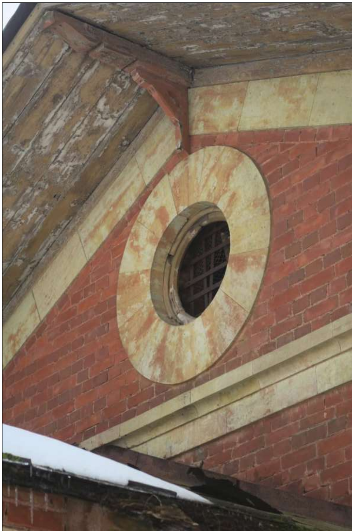
13. Караулка у Березовых ворот. Архитектурное решение фронтона основного объема: Каменный карниз, облицовка круглого оконного проема, карниз фронтона из известняка. Видна деревянная резная кобылка и кронштейн свеса кровли в коньковой зоне. Сохранились остатки изначального красочного слоя –красной охры.
