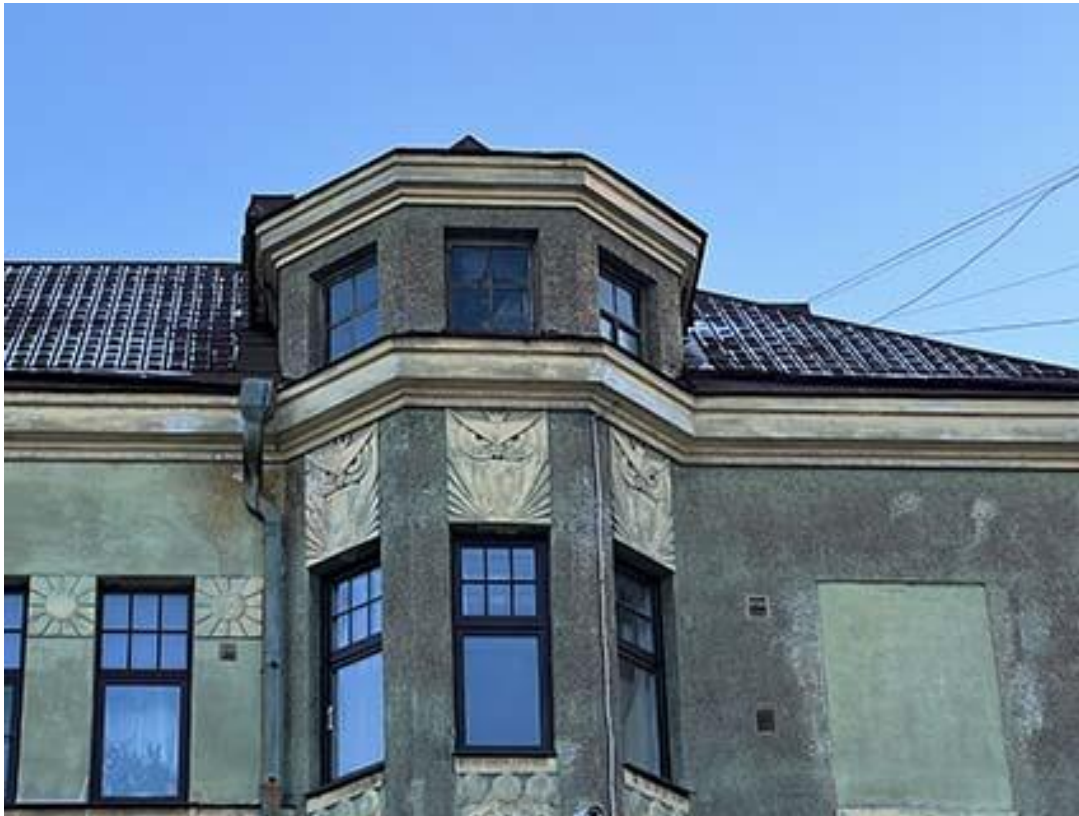
Фото 5. Фрагмент лицевого фасада здания. Башнеобразная надстройка эркера. Дата съемки: 01.02.2022 г. Автор съемки: Куваева Ю.П.
