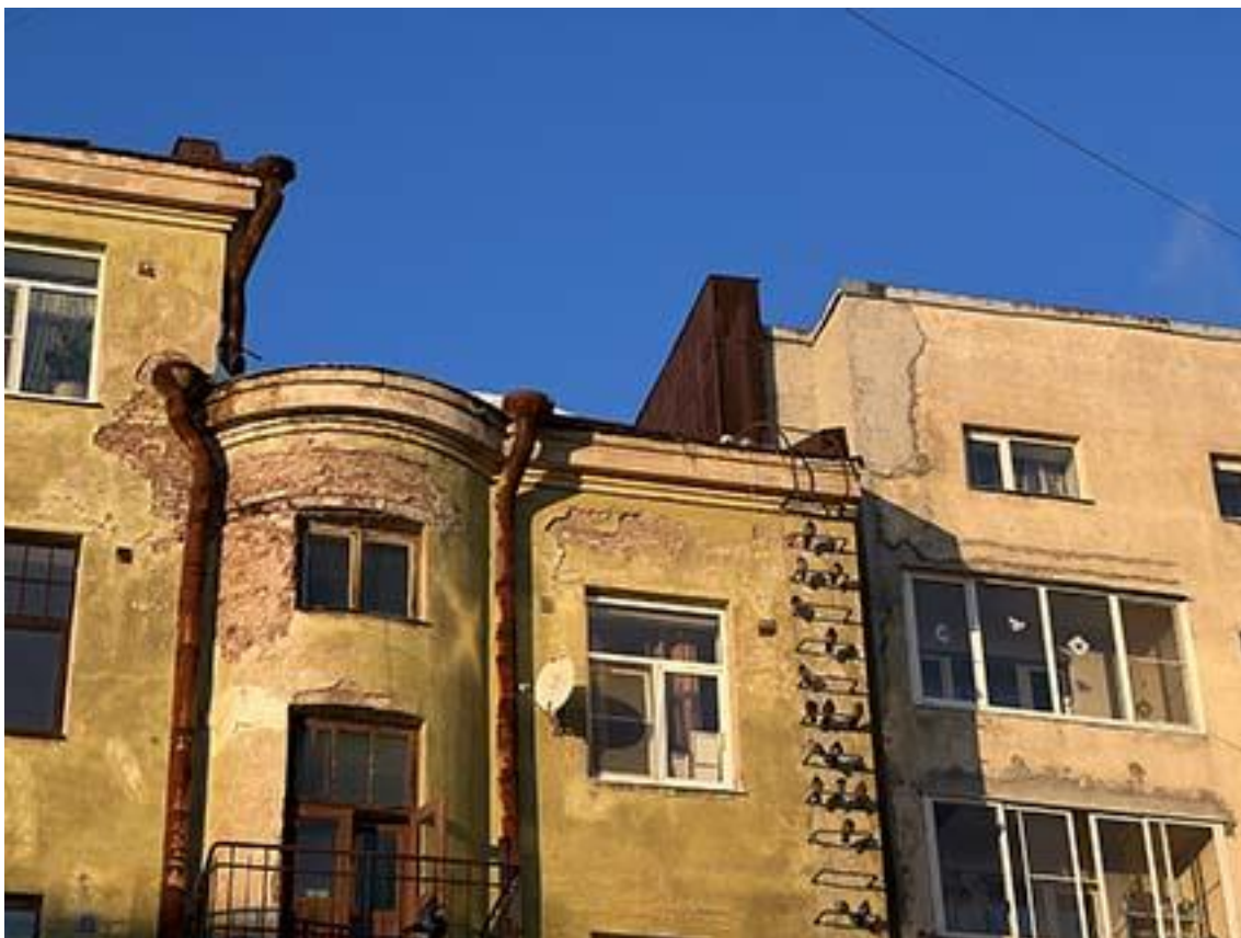
Фото 8. Фрагмент правой части дворового фасада здания. Дата съемки: 01.02.2022 г. Автор съемки: Куваева Ю.П.
