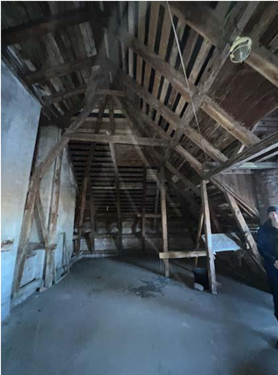
Фото 15. Чердак. Общий вид юго-западной части помещения. Фото с северо-востока. Дата съемки: 01.02.2022 г. Автор съемки: Куваева Ю.П.
