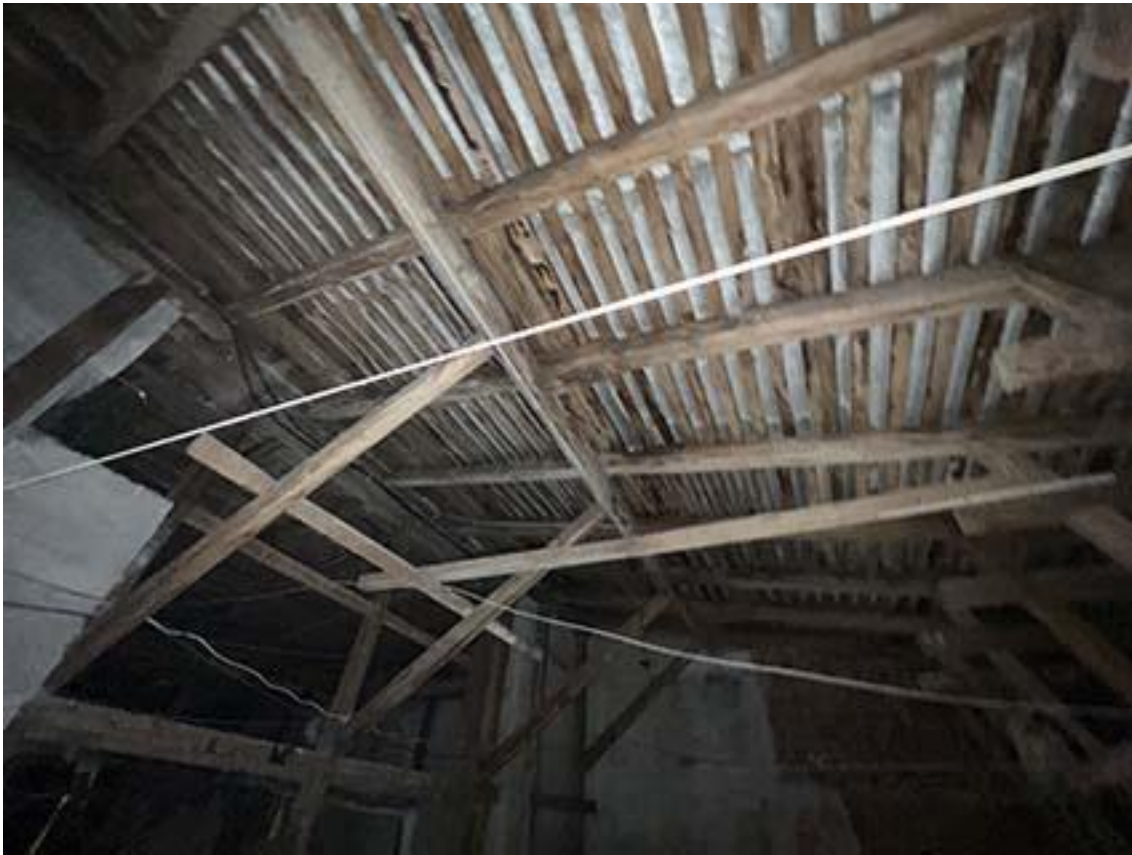
Фото 18. Чердак. Фрагмент стропильной системы в юго-восточной части помещения уличного корпуса здания. Дата съемки: 01.02.2022 г. Автор съемки: Куваева Ю.П.
