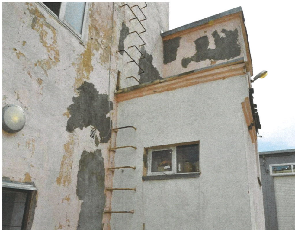
Фото 3. Утраты отделочных слоев фасада.
