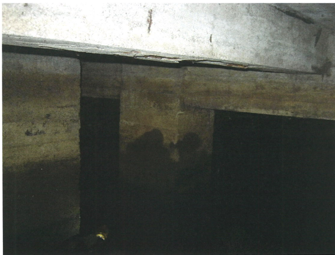
Фото 12. Отслоение защитного слоя рабочей арматуры.
