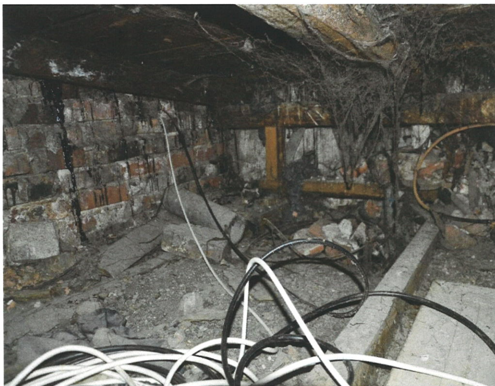
Фото 8. Биопоражение стропильной системы.
