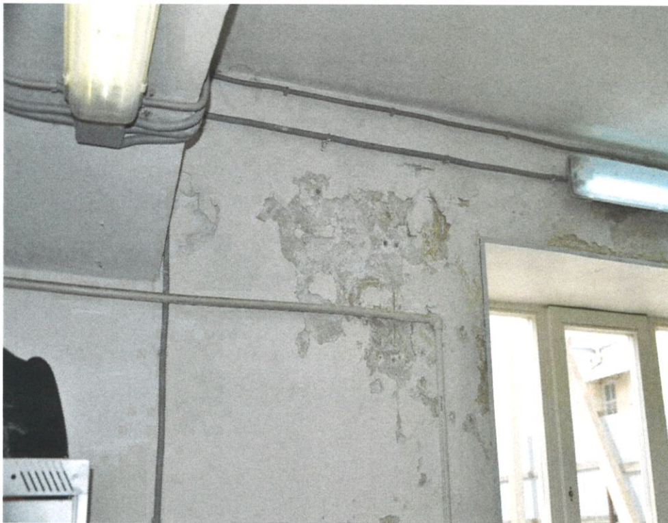
Фото 5. Утраты отделочных слоев помещения первого этажа.
