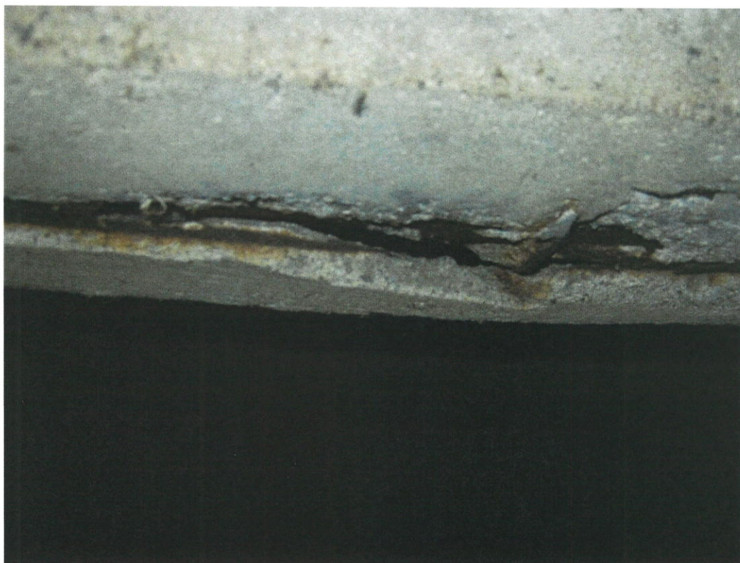
Фото 14. Отслоение защитного слоя и коррозия арматуры.
