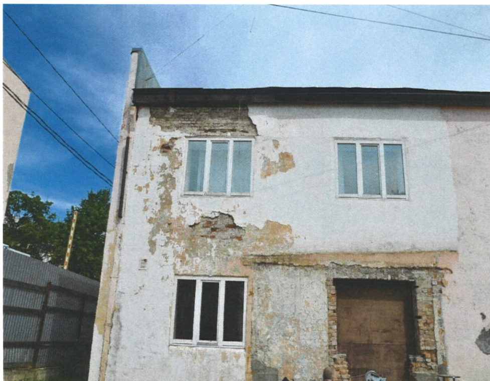
Фото 4. Утраты отделочных слоев фасада. Деструкция кирпичной кладки.
