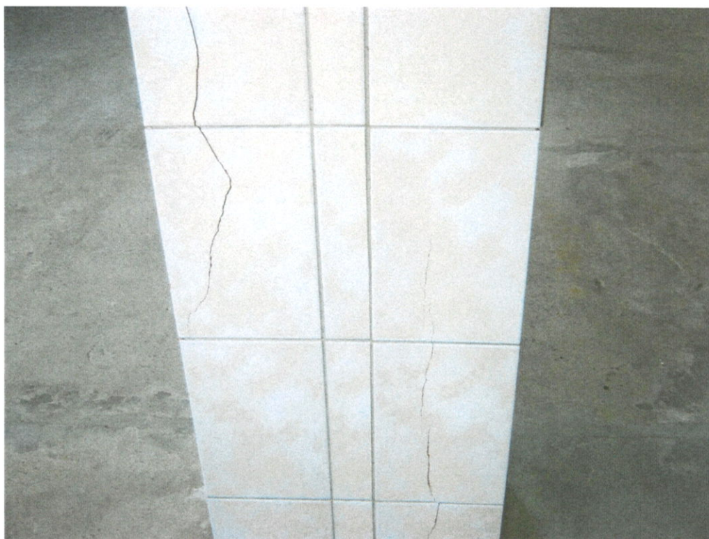
Фото 9. Трещины в отделочном слое колонны. Раскрытие до 5мм.
