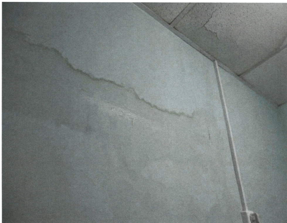
Фото 6. Следы протечек стен и потолка в помещении санузла.
