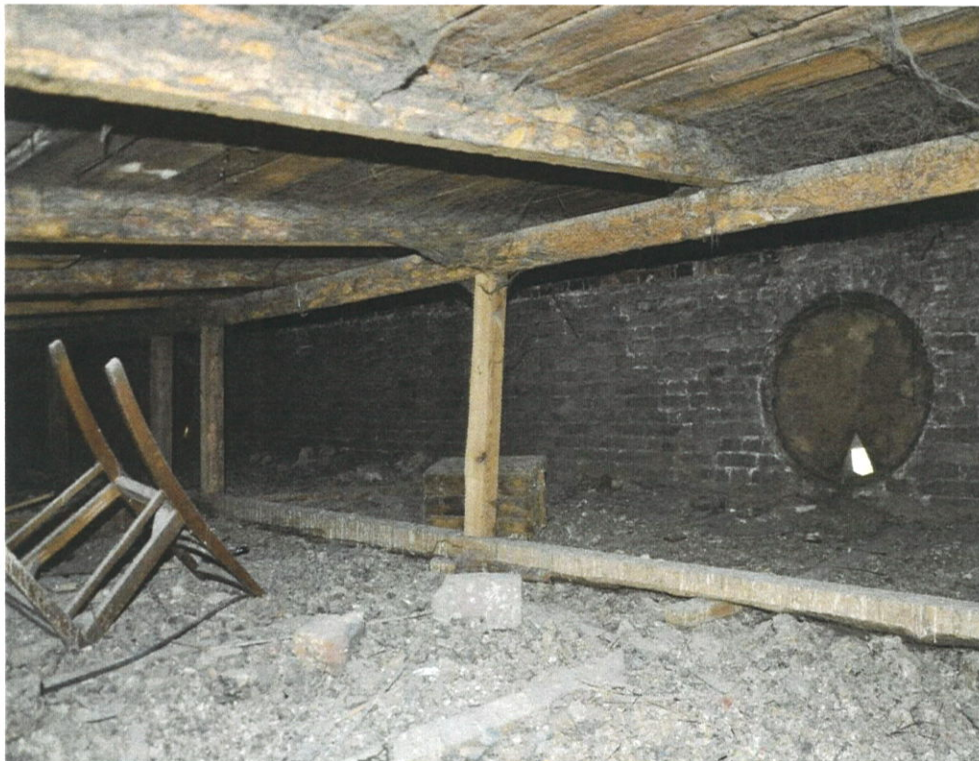
Фото 7. Биопоражение стропильной системы.
