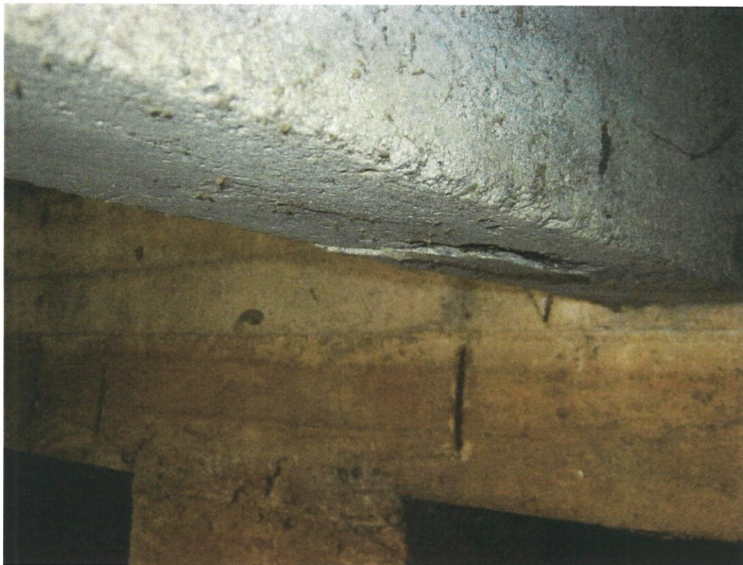
Фото 13. Намокание бетона. Нарушение защитного слоя арматуры.
