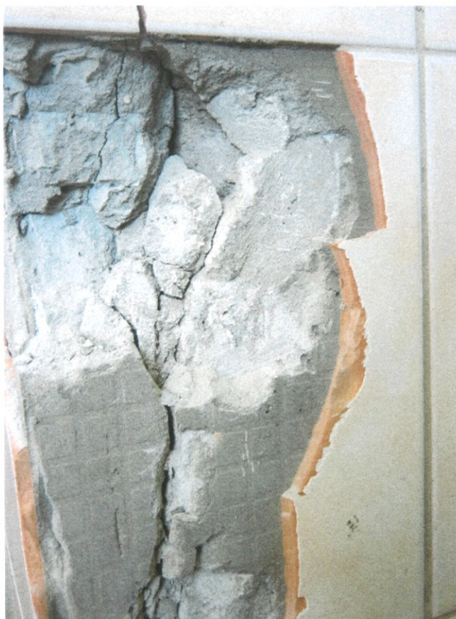
Фото 10. Разрушение защитного слоя и бетона (раствора) колонны.
