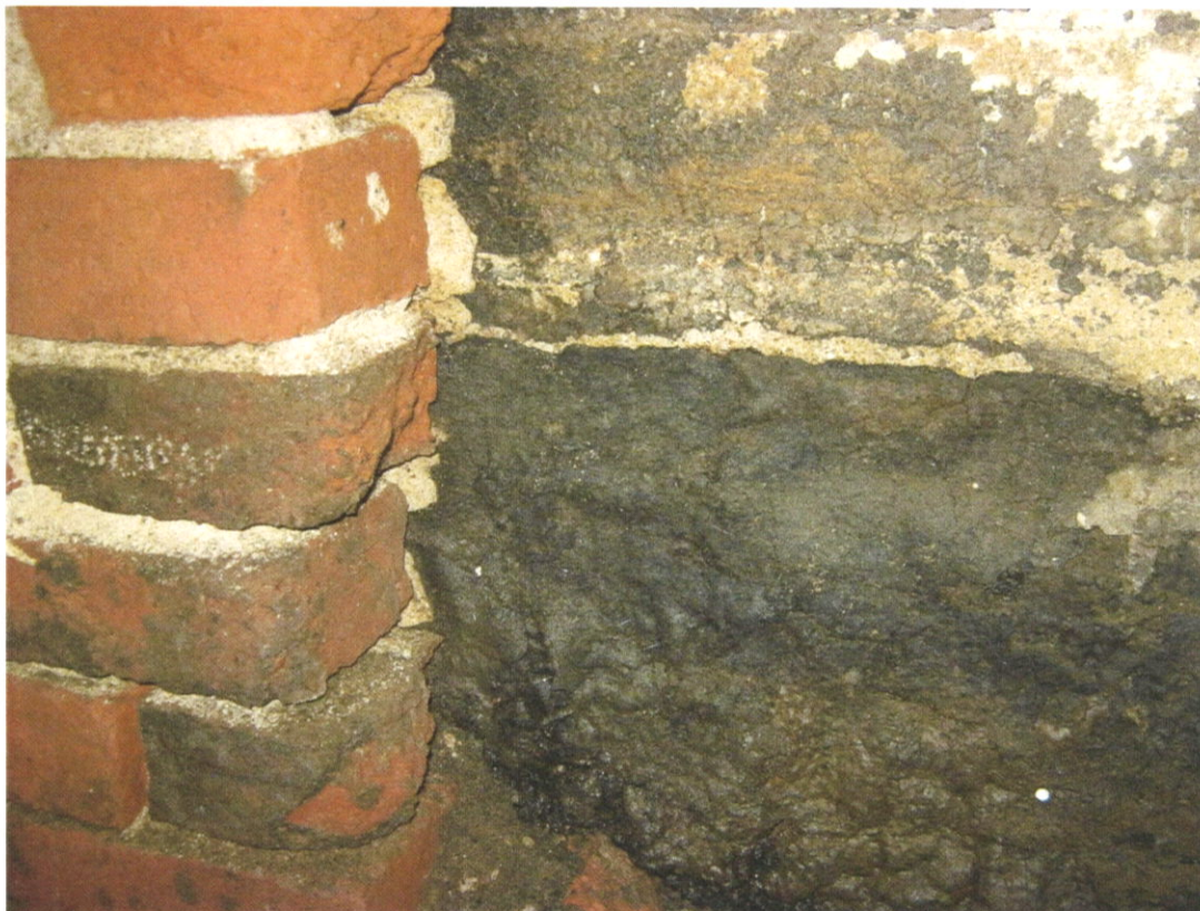
Фото 11. Намокание конструкций в подвале.
