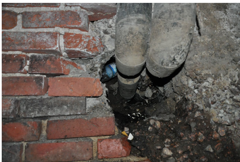
Фото 3.6.3. Узел ввода отопления в здание.
