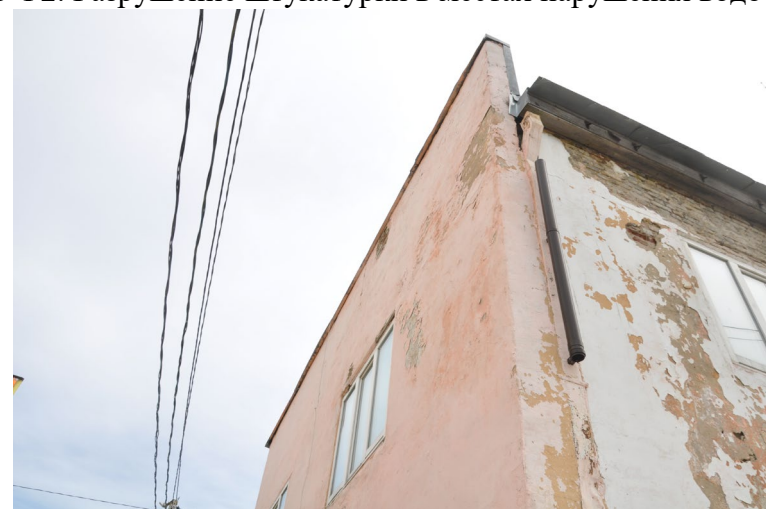
Фото Ф3. Нарушение целостности водосточных труб.
