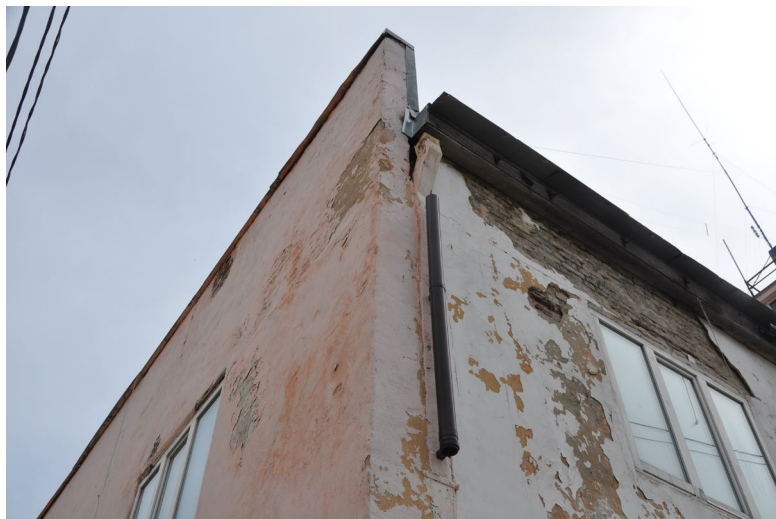
Фото 3.2.1. Отслаивание штукатурки, нарушение кладки, разрушение окрасочного слоя по оси Е.
