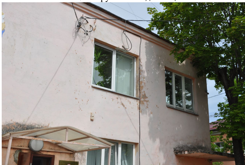
Фото Ф8. Разрушение окрасочного слоя, поражение фасада грибком.
