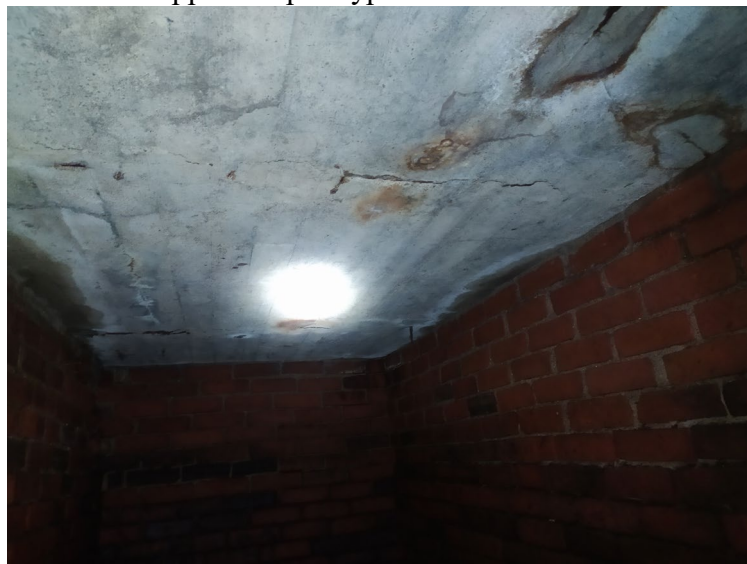
Фото 3.3.6. Коррозия арматуры и нарушение защитного слоя бетона плиты.
