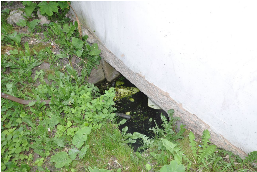
Фото Ф10. Замокание штукатурки цоколя.
