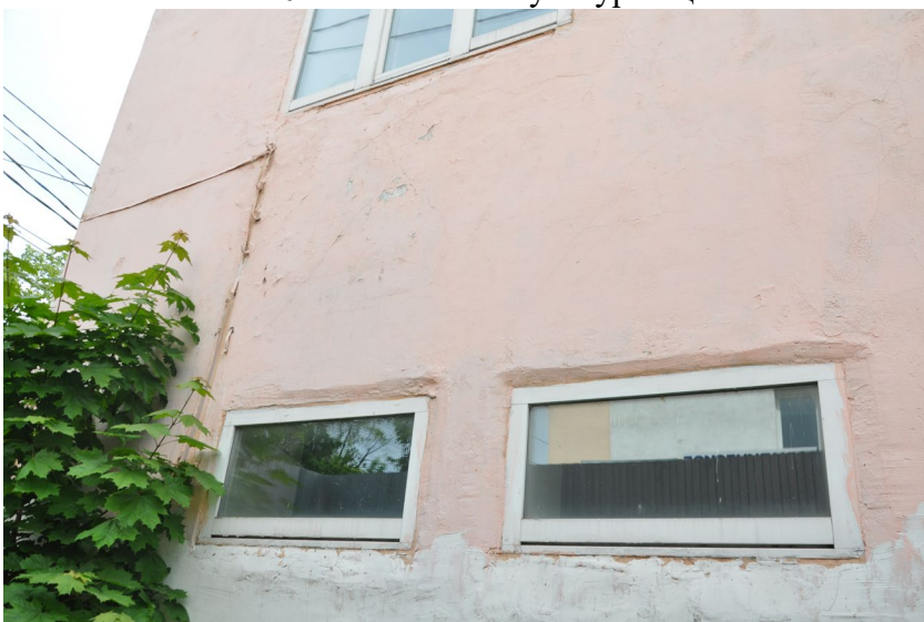
Фото Ф11. Нарушение окрасочного слоя.
