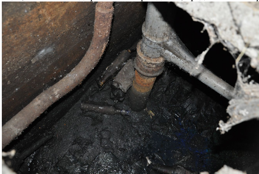
Фото 3.6.3. Узел ввода водопровода в здание.
