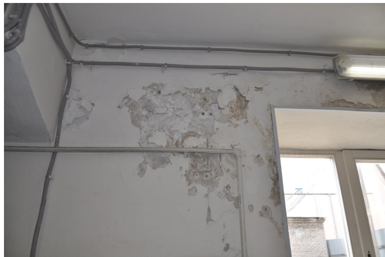
Фото 3.2.9. Биопоражения внутренней части стен
