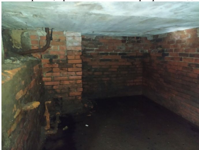
Фото Ф21. Замокание кирпичной кладки в подвале с биопоражением.
