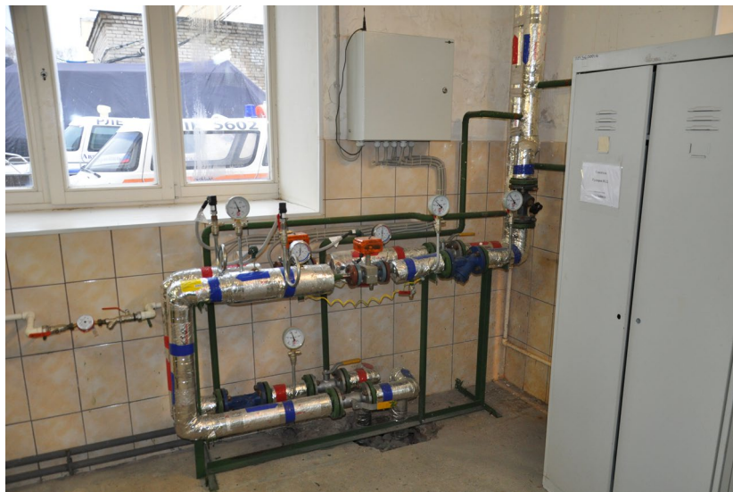
Фото 3.6.4. Помещение гаража. ИТП.
