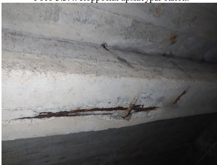
Фото 3.3.5. Коррозия арматуры балок с отслоением бетона.
