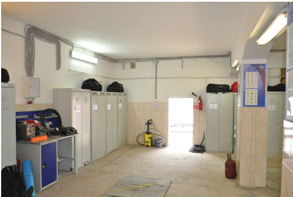
Фото 3.6.6 Помещение гаража. Разводка электрических кабелей.
