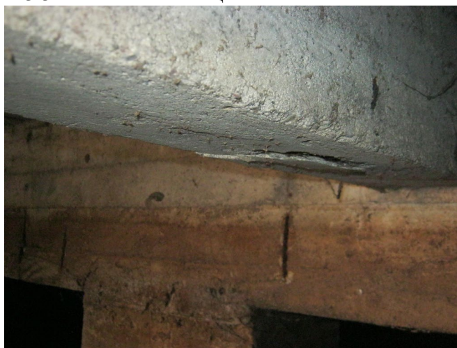
Фото 3.3.3. Отслоения защитного слоя бетона с оголением арматуры.
