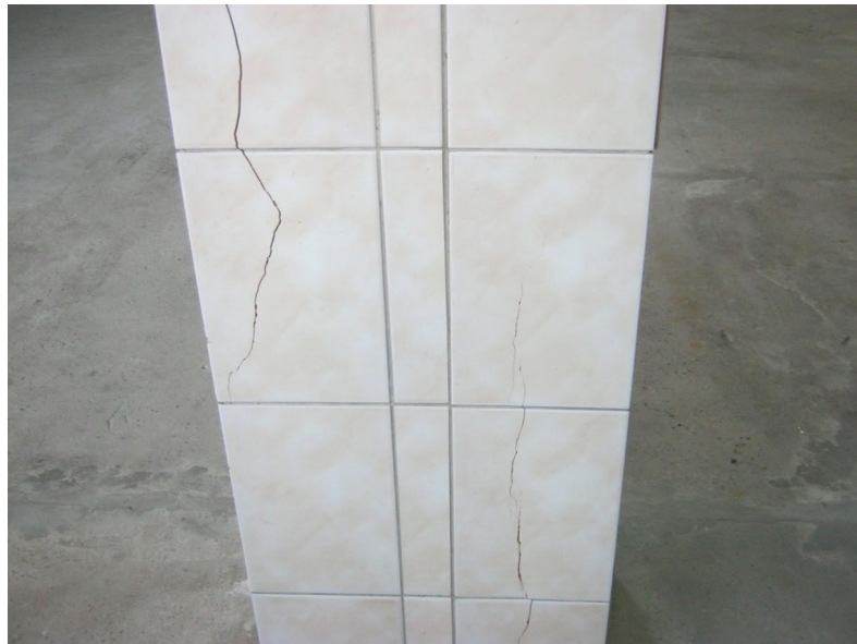
Фото Ф23. Трещины в колонне по оси 5/Г. Раскрытие трещин до 5мм.
