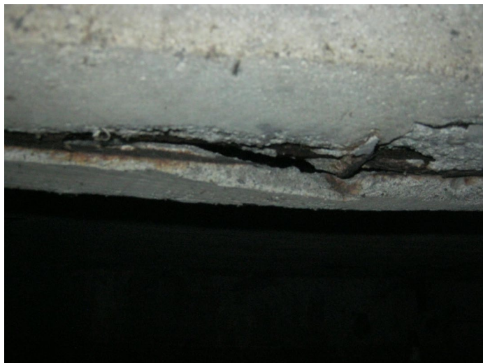
Фото 3.3.4. Коррозия арматуры балок.
