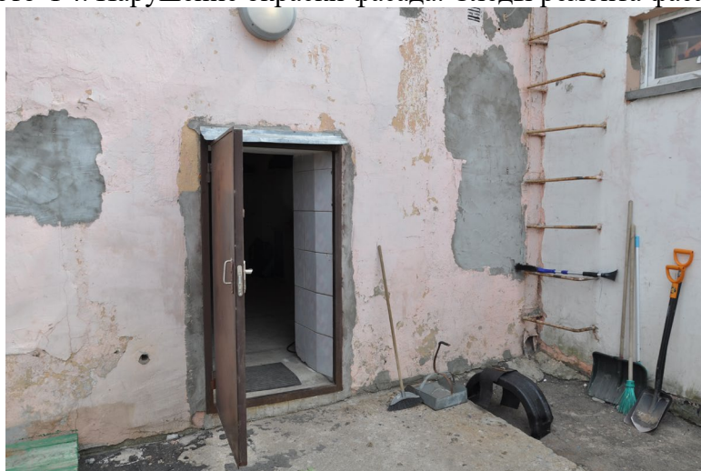
Фото Ф5. Отсутствие козырька над входом.
