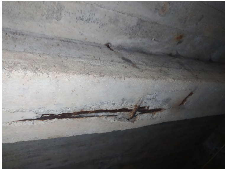
Фото Ф18. Разрушение защитного слоя балок подвала. Коррозия арматуры.
