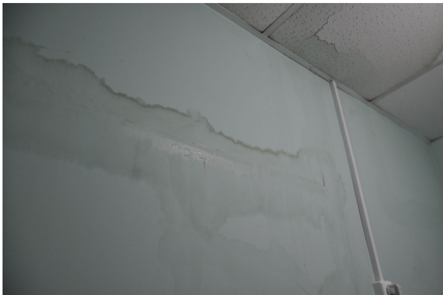
Фото Ф13. Следы протечек на втором этаже.
