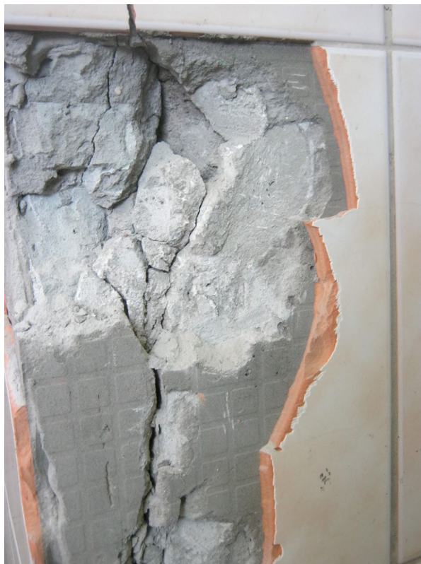
Фото 3.2.11. Разрушение защитного слоя и бетона колонны.
