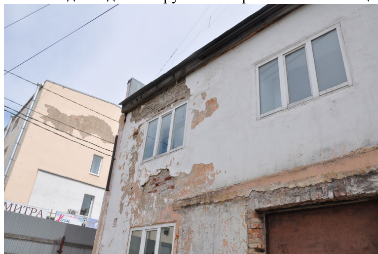
Фото Ф2. Разрушение штукатурки в местах нарушения водостока.
