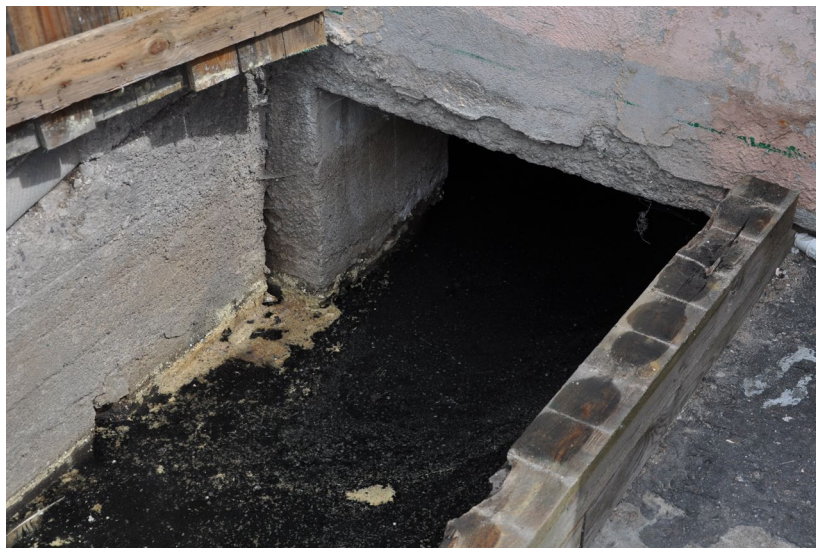
Фото 3.1.3. Уровень воды в затопленном подвале на момент проведения обследования.
