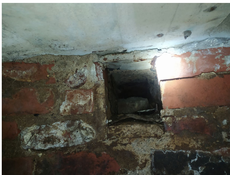
Фото 3.2.8. Состояние кирпичной кладки подвала.
