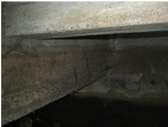
Фото 3.3.1. Намокание монолитных конструкций подвала.
