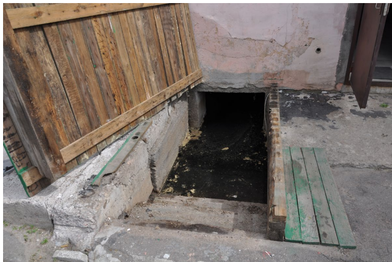
Фото Ф1. Вход в подвал. Нарушение окрасочного слоя и цоколя.
