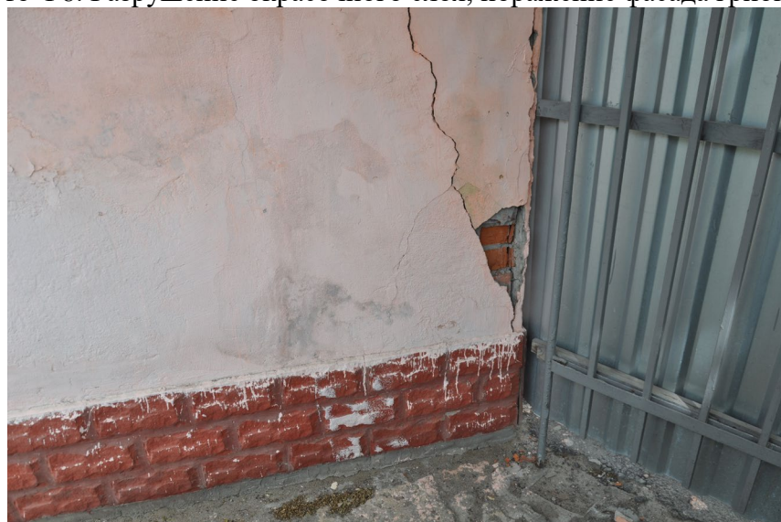
Фото Ф9. Отслоение штукатурки и отделки цоколя.
