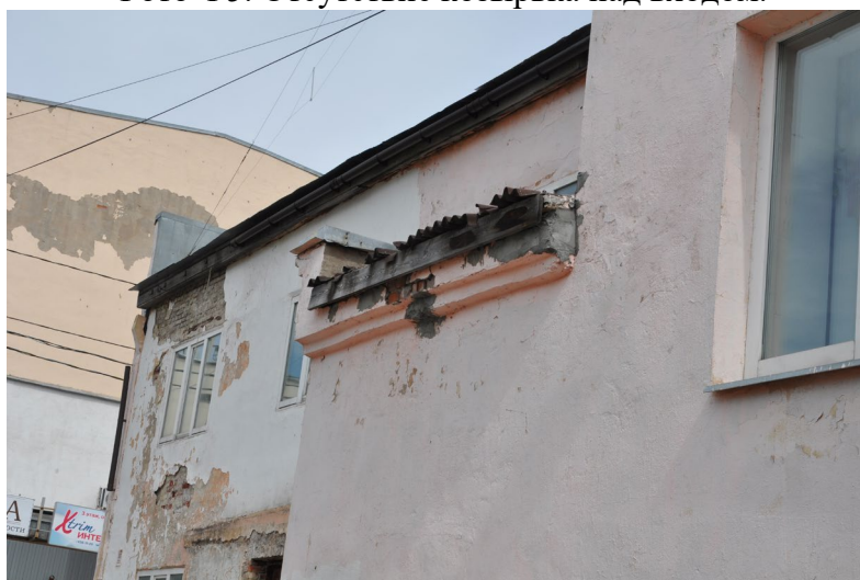
Фото Ф6. Нарушение водостока пристройки.
