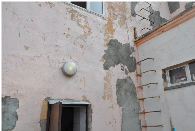
Фото 3.2.3. Нарушение штукатурки, заделка утраченного штукатурного слоя.
