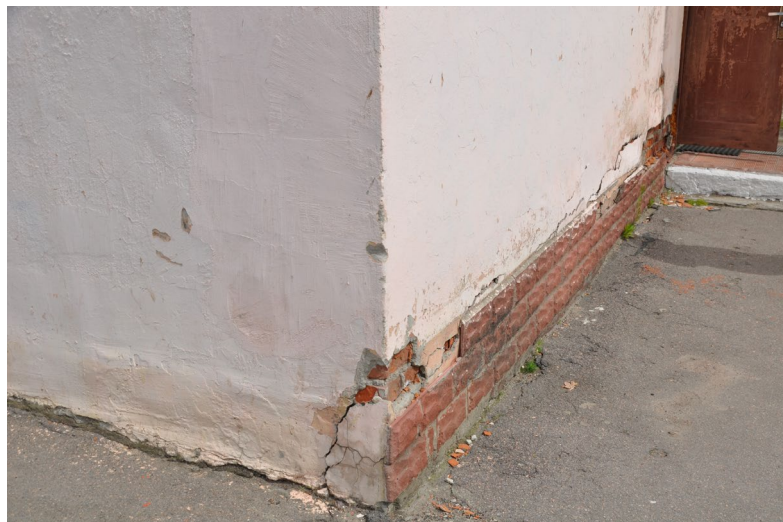
Фото Ф7. Разрушение отделки цоколя.
