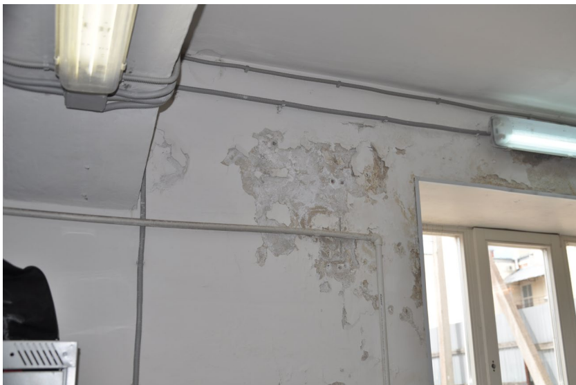
Фото Ф15. Нарушение штукатурки внутри помещений. Поражение грибком.
