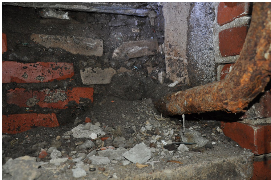
Фото 3.6.2. Узел ввода водопровода в здание. Коррозия
