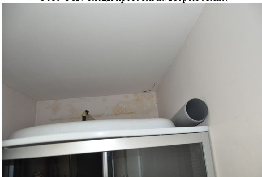
Фото Ф14. Следы протечек на втором этаже.
