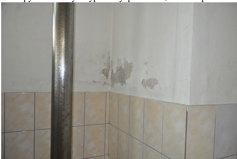
Фото Ф16. Нарушение отделки внутри помещений в осях 3-5/Е.
