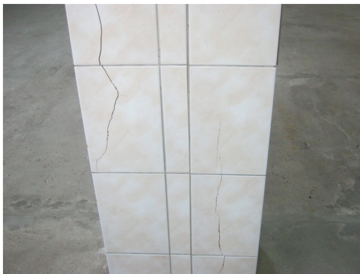
Фото 3.2.10. Трещины в отделочном слое колонны по оси 5/Г с раскрытием до 5мм.
