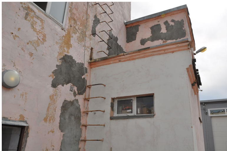
Фото Ф4. Нарушение окраски фасада. Следы ремонта фасада.
