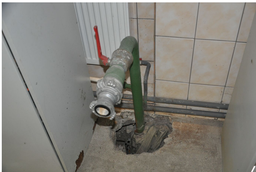
Фото 3.6.1. Прокладка трубы водоснабжения через перекрытие над подвалом выполнено без стальных гильз.
