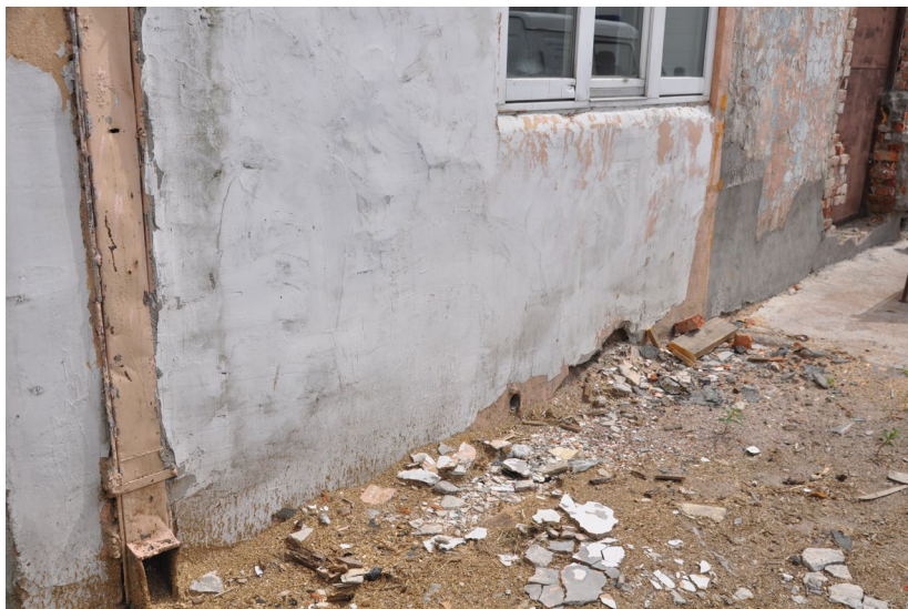
Фото 3.2.7. Разрушение цоколя по оси 6.
