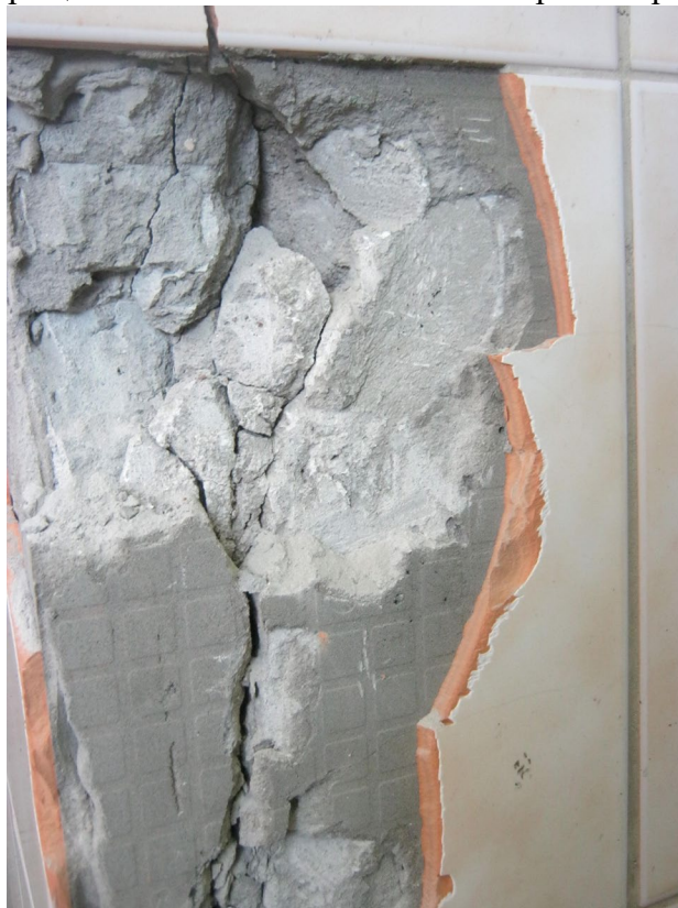
Фото Ф24. Разрушение бетона колонны.
