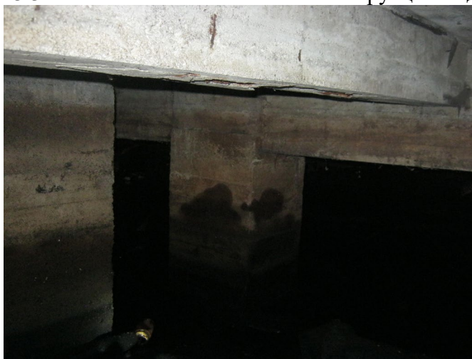
Фото 3.3.2. Отслоение защитного слоя бетона в балках.
