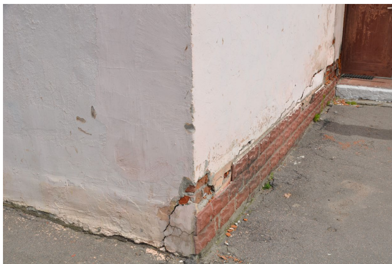
Фото 3.2.4. Нарушение облицовки и отделки цоколя по оси 1.
