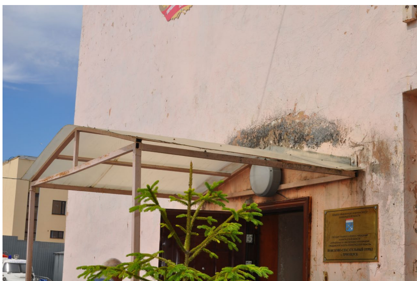
Фото 3.2.6. Биопоражения фасадной части по оси 1.
