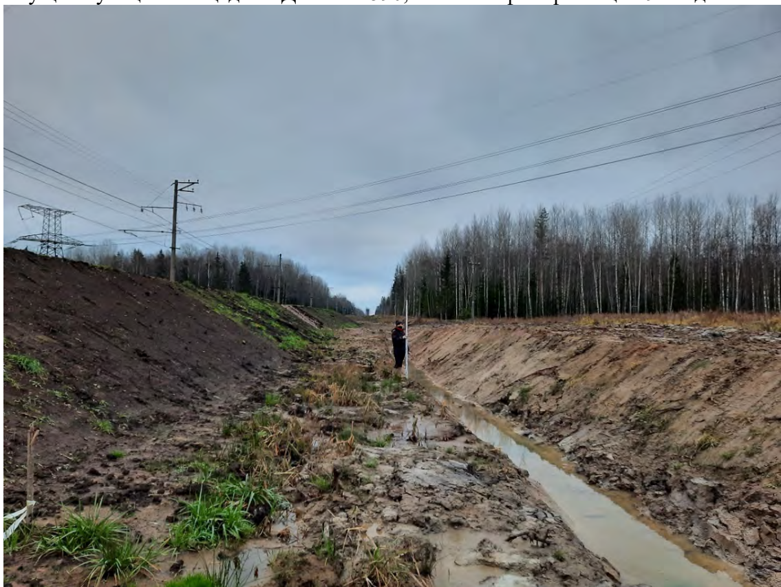
Рис. 74. Ленинградская обл., Киришский р-н, «Подъездная автодорога к существующей площадке УДЗ на км 590,4». Точка фотофиксации 10. Вид с СЗ.
