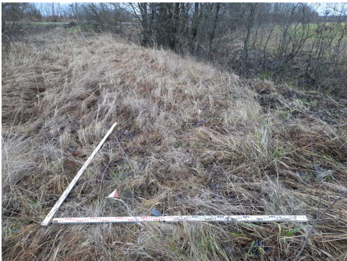
Рис. 9. Ленинградская обл., Киришский р-н, «Подъездная автодорога к существующей площадке УДЗ на км 590,4». Шурф 1. До начала земляных работ. Вид с Ю.
