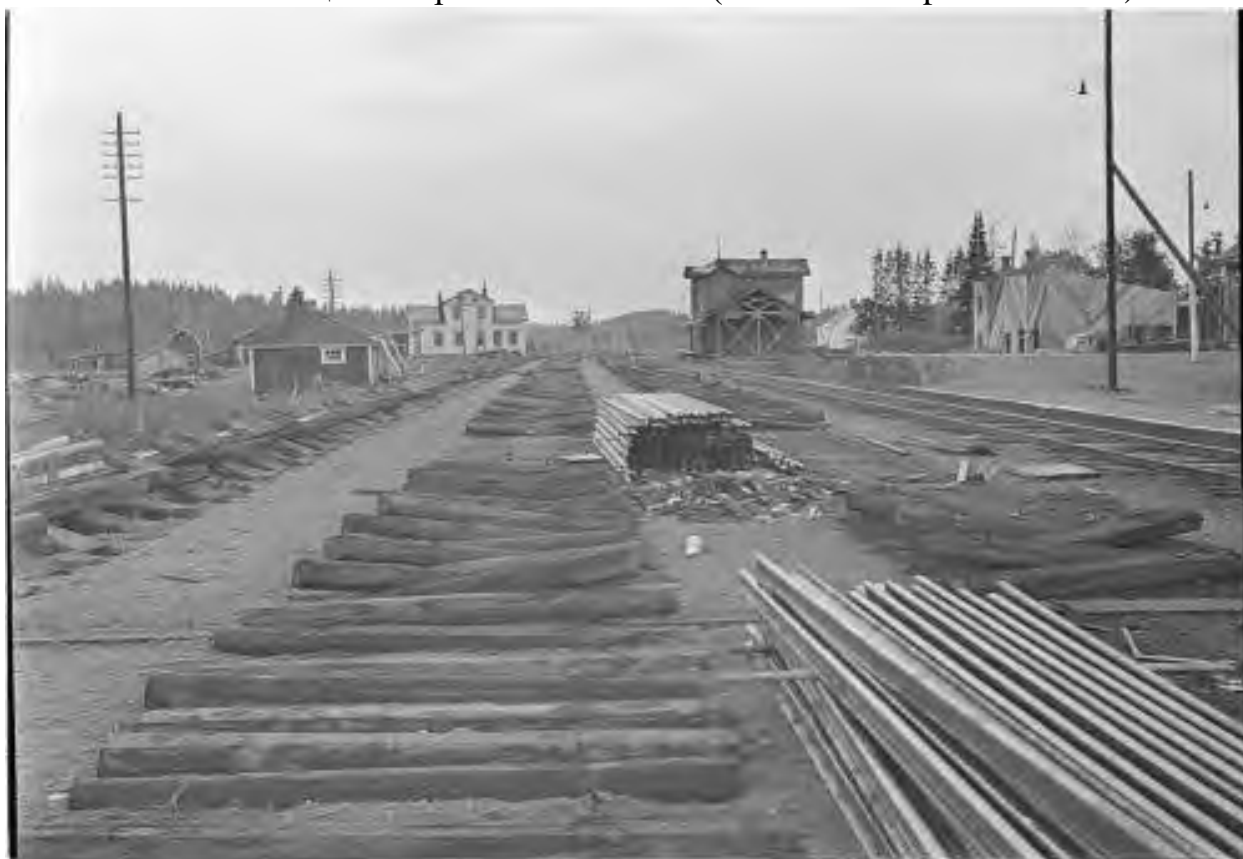
Илл. 9. Демонтированные железнодорожные пути при отходе советских войск из Оярви. 09.08.1941 г. (источник: http://sa-kuva.fi/ )
