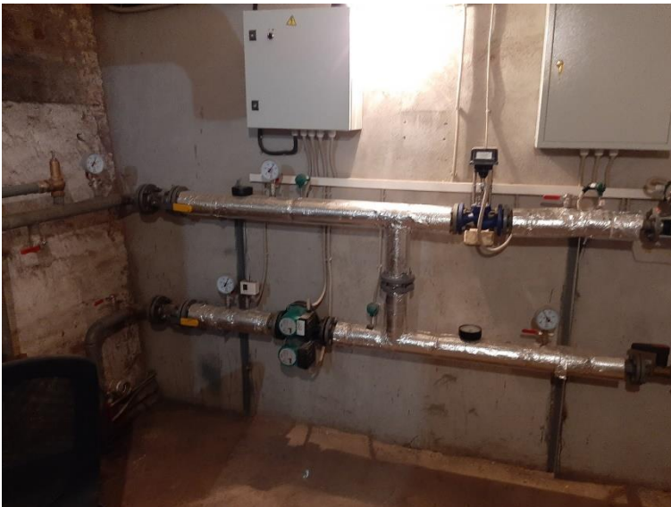
4. «Магазин, контора», Ленинградская область, Выборгский район, г. Выборг, ул. Мира, д. 8. Подвал. Общий вид. Фото 01.04.2022г.
