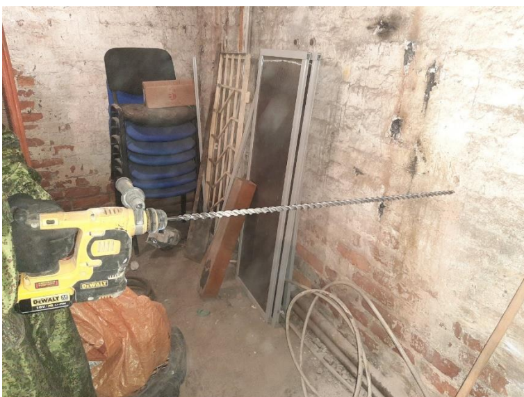
23. «Магазин, контора», Ленинградская область, Выборгский район, г. Выборг, ул. Мира, д. 8. Подвал. Общий вид. Фото 01.04.2022г.
