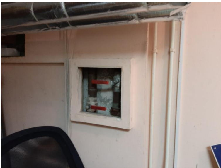
8. «Магазин, контора», Ленинградская область, Выборгский район, г. Выборг, ул. Мира, д. 8. Подвал. Фрагмент. Фото 01.04.2022г.
