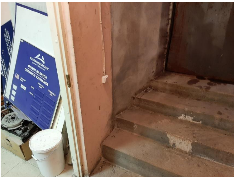
5. «Магазин, контора», Ленинградская область, Выборгский район, г. Выборг, ул. Мира, д. 8. Подвал. Фрагмент. Фото 01.04.2022г.
