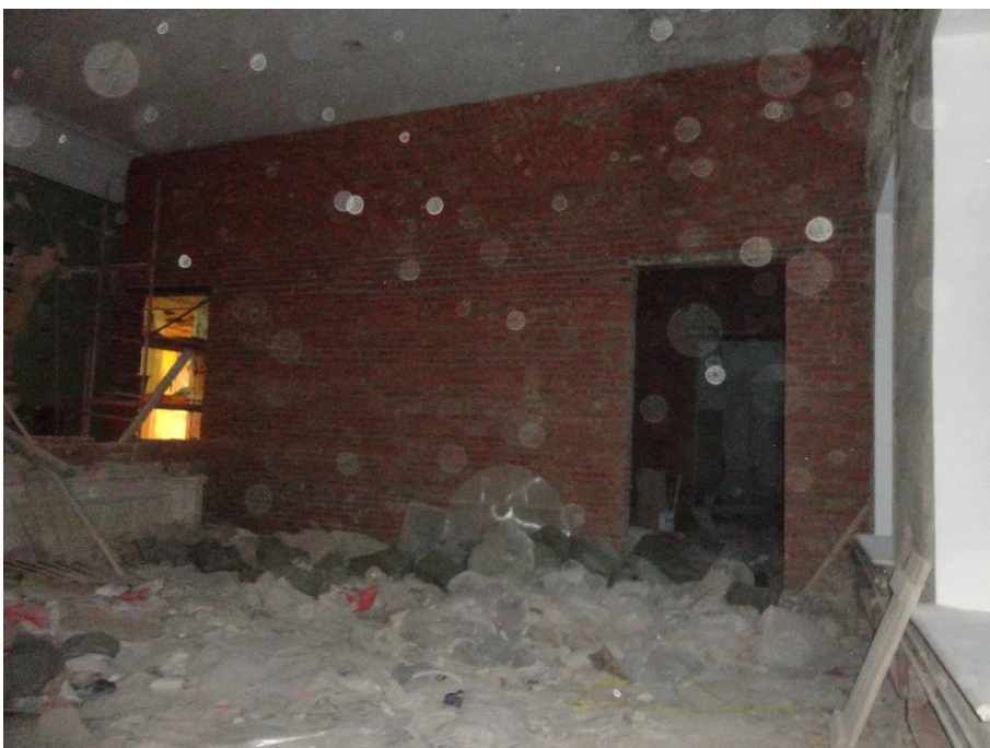
56. «Гатчинский дворец (с Арсенальным и Кухонным каре)», Ленинградская область, Гатчинский муниципальный район, г. Гатчина, Красноармейский пр., д. 1. Арсенальное каре. 3 этаж. Помещение №12, 13. Фрагмент. Фото 01.12.2021г.
