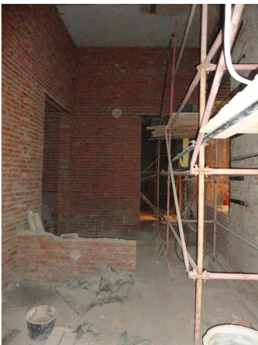
46. «Гатчинский дворец (с Арсенальным и Кухонным каре)», Ленинградская область, Гатчинский муниципальный район, г. Гатчина, Красноармейский пр., д. 1. Арсенальное каре. 3 этаж. Помещение №11. Общий вид. Фото 01.12.2021г.
