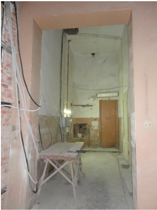
26. «Гатчинский дворец (с Арсенальным и Кухонным каре)», Ленинградская область, Гатчинский муниципальный район, г. Гатчина, Красноармейский пр., д. 1. Арсенальное каре. 3 этаж. Помещение №5. Общий вид. Фото 01.12.2021г.
