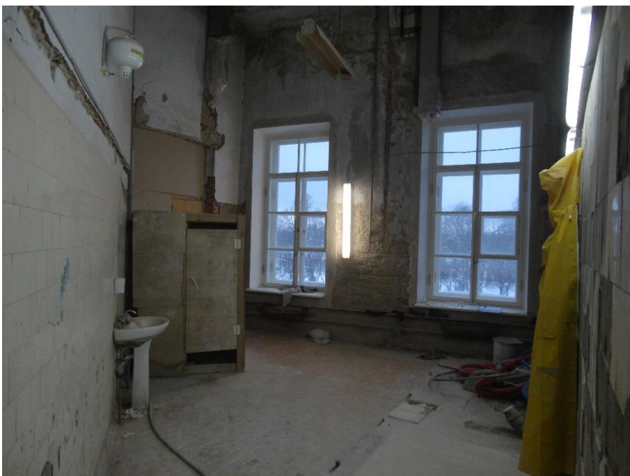
11. «Гатчинский дворец (с Арсенальным и Кухонным каре)», Ленинградская область, Гатчинский муниципальный район, г. Гатчина, Красноармейский пр., д. 1. Арсенальное каре. 3 этаж. Помещение №2. Общий вид. Фото 01.12.2021г.
