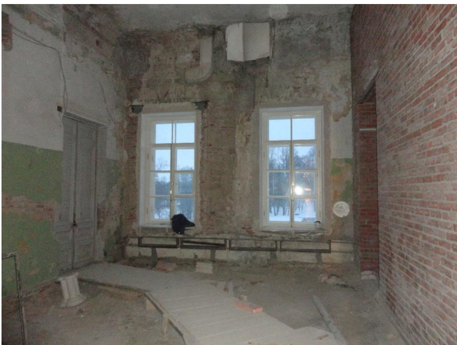
37. «Гатчинский дворец (с Арсенальным и Кухонным каре)», Ленинградская область, Гатчинский муниципальный район, г. Гатчина, Красноармейский пр., д. 1. Арсенальное каре. 3 этаж. Помещение №9. Общий вид. Фото 01.12.2021г.
