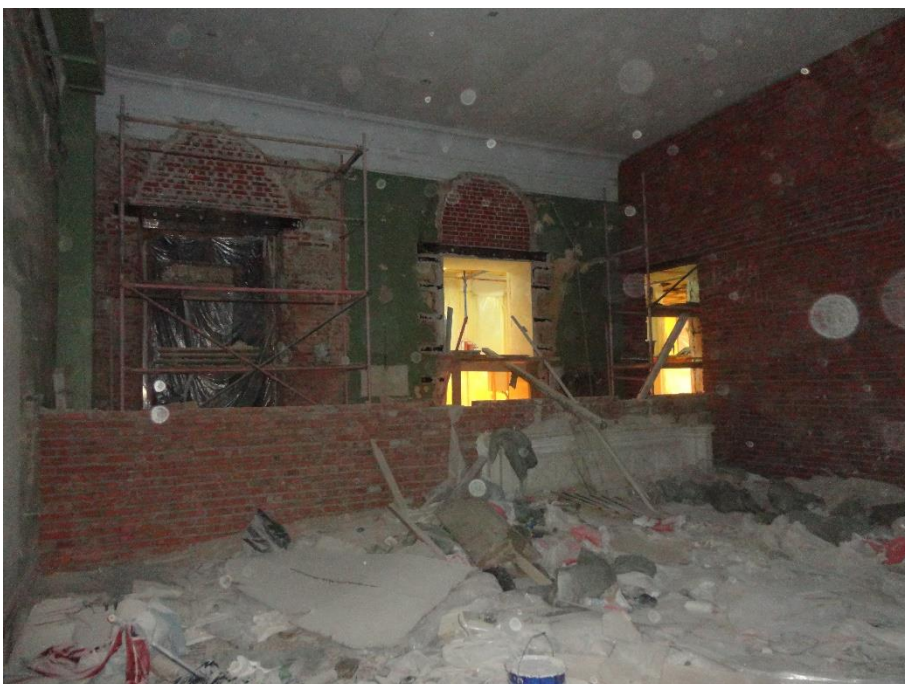
53. «Гатчинский дворец (с Арсенальным и Кухонным каре)», Ленинградская область, Гатчинский муниципальный район, г. Гатчина, Красноармейский пр., д. 1. Арсенальное каре. 3 этаж. Помещение №12, 13. Общий вид. Фото 01.12.2021г.
