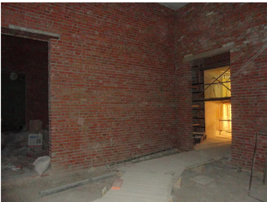
38. «Гатчинский дворец (с Арсенальным и Кухонным каре)», Ленинградская область, Гатчинский муниципальный район, г. Гатчина, Красноармейский пр., д. 1. Арсенальное каре. 3 этаж. Помещение №9. Общий вид. Фото 01.12.2021г.
