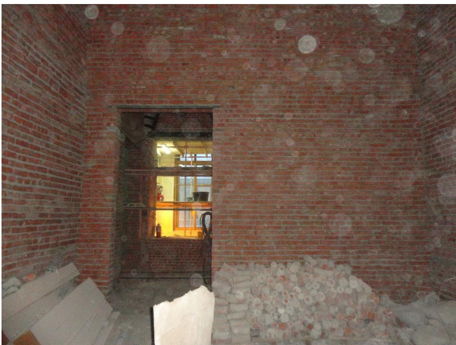
43. «Гатчинский дворец (с Арсенальным и Кухонным каре)», Ленинградская область, Гатчинский муниципальный район, г. Гатчина, Красноармейский пр., д. 1. Арсенальное каре. 3 этаж. Помещение №10. Общий вид. Фото 01.12.2021г.
