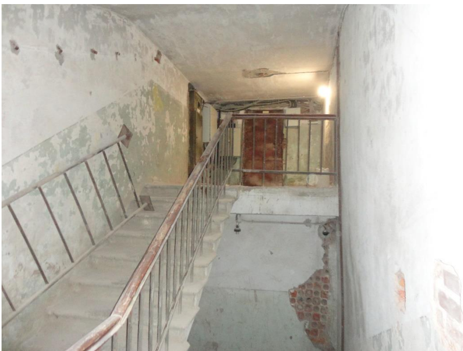
21. «Гатчинский дворец (с Арсенальным и Кухонным каре)», Ленинградская область, Гатчинский муниципальный район, г. Гатчина, Красноармейский пр., д. 1. Арсенальное каре. 3 этаж. Помещение №4. Общий вид. Фото 01.12.2021г.
