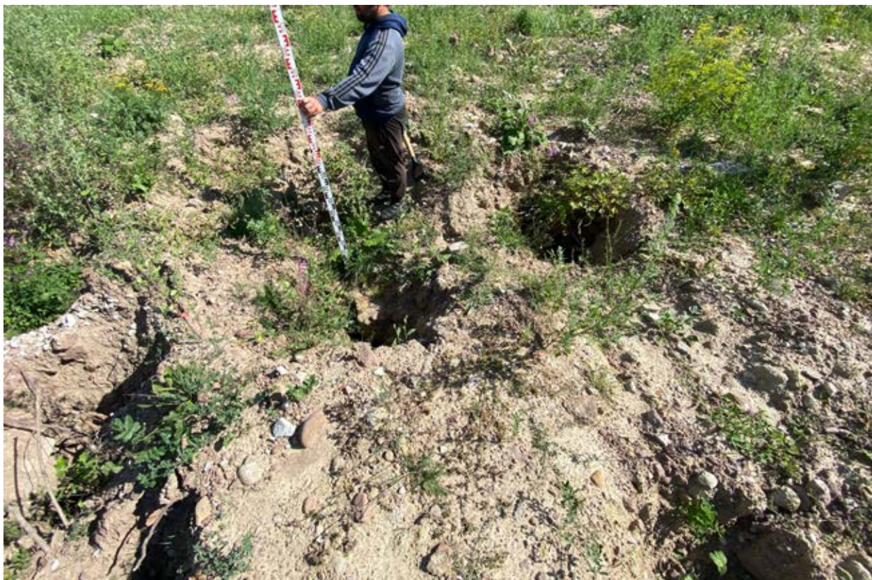
Илл. 22. Ленинградская область. Кингисеппский муниципальный район. Объект археологических исследований. Точка фото-фиксации №7. Участок перехода через р. Луга, разрушение (промывы) насыпного грунта. Вид с запада.
