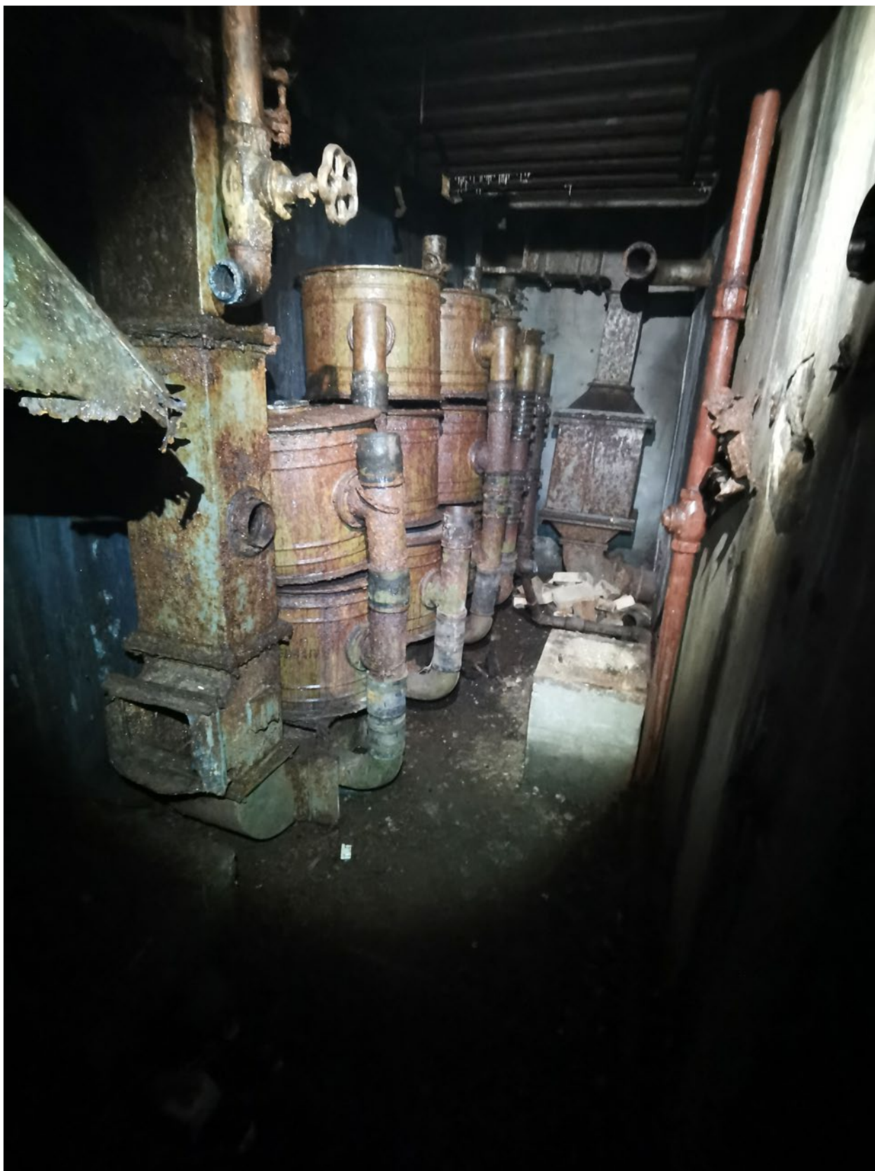
6. Интерьер ДОТа. Фрагменты фильтровентиляционной установки. Фото: 08.11.21.
