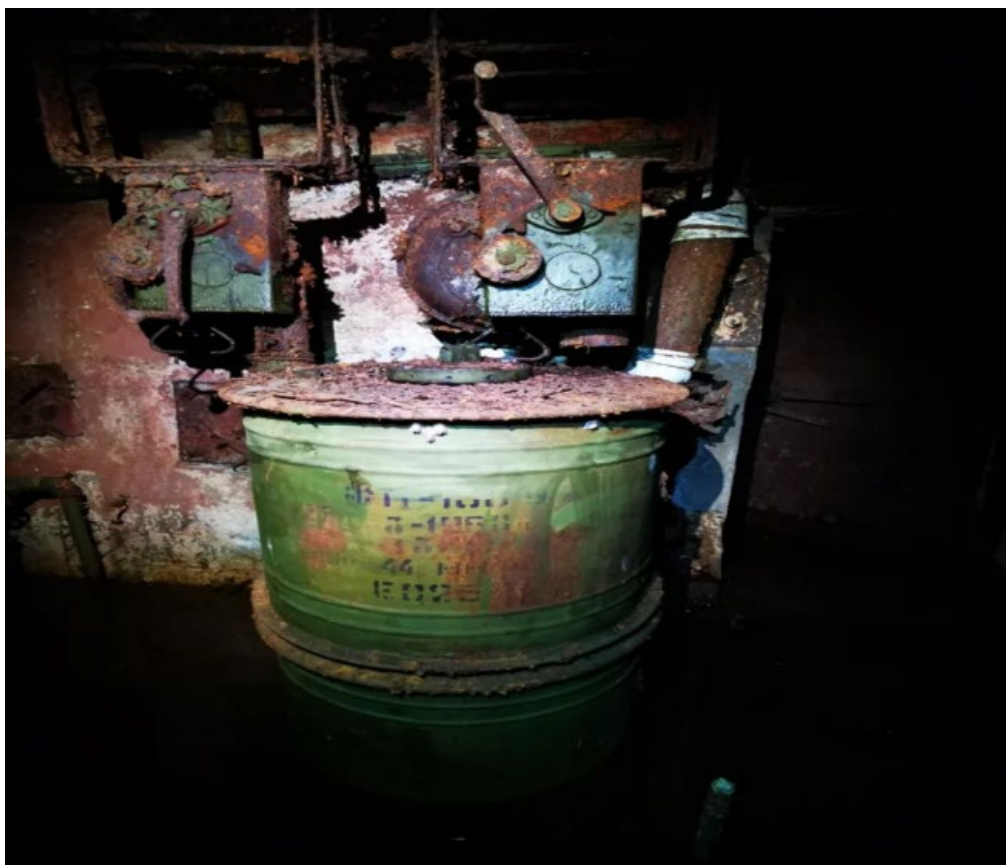
5. Сохранившиеся фрагменты фильтровентиляционной установки в ДОТ №65.
