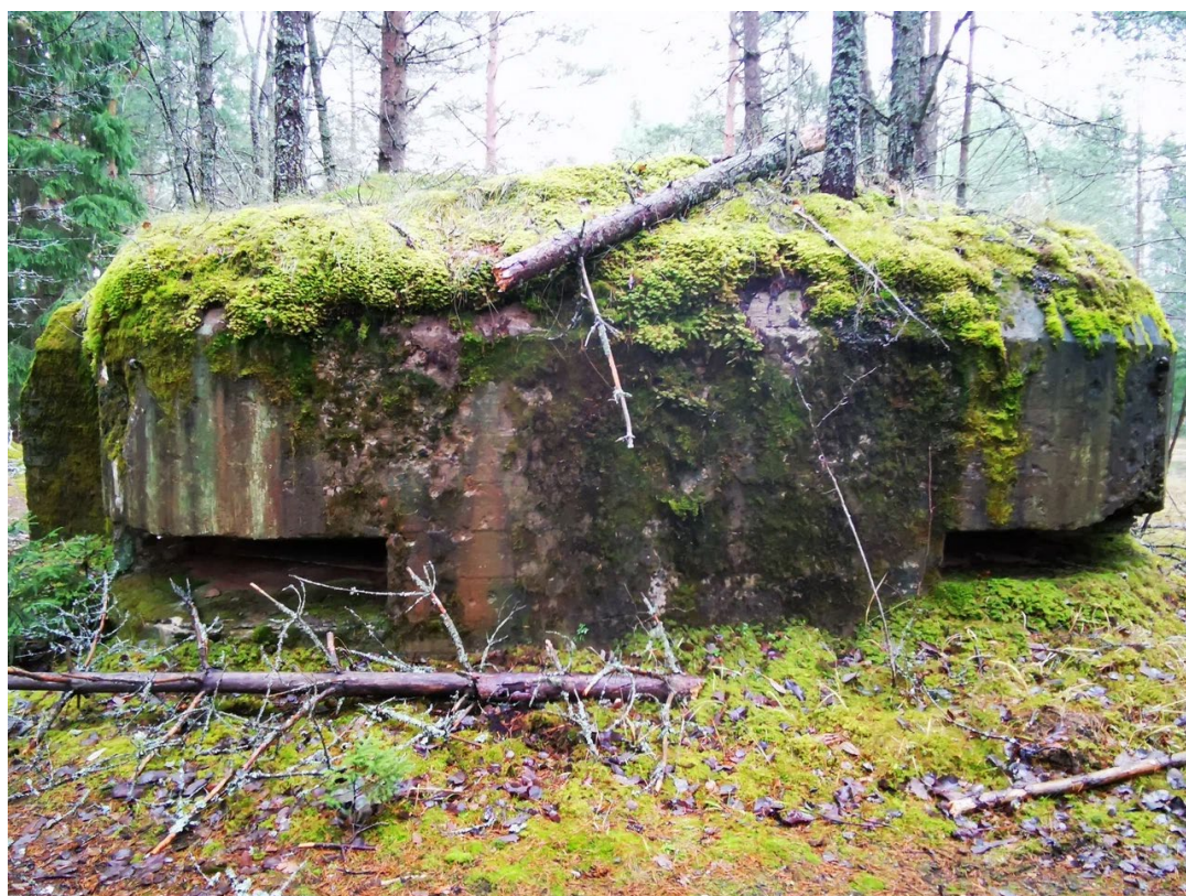
4. Вид на амбразуры и повреждения с фронта. ДОТ № 633.
