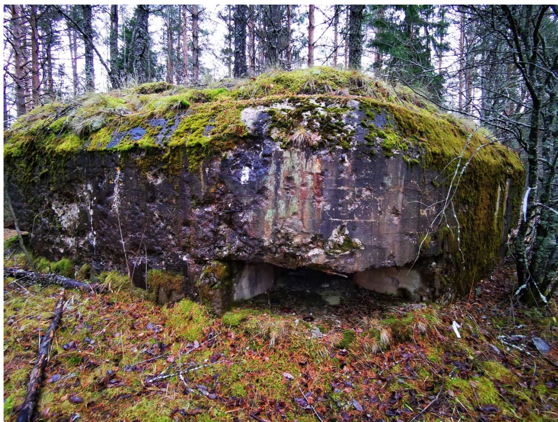
2. Вид на повреждения амбразуры. ДОТ № 633.
