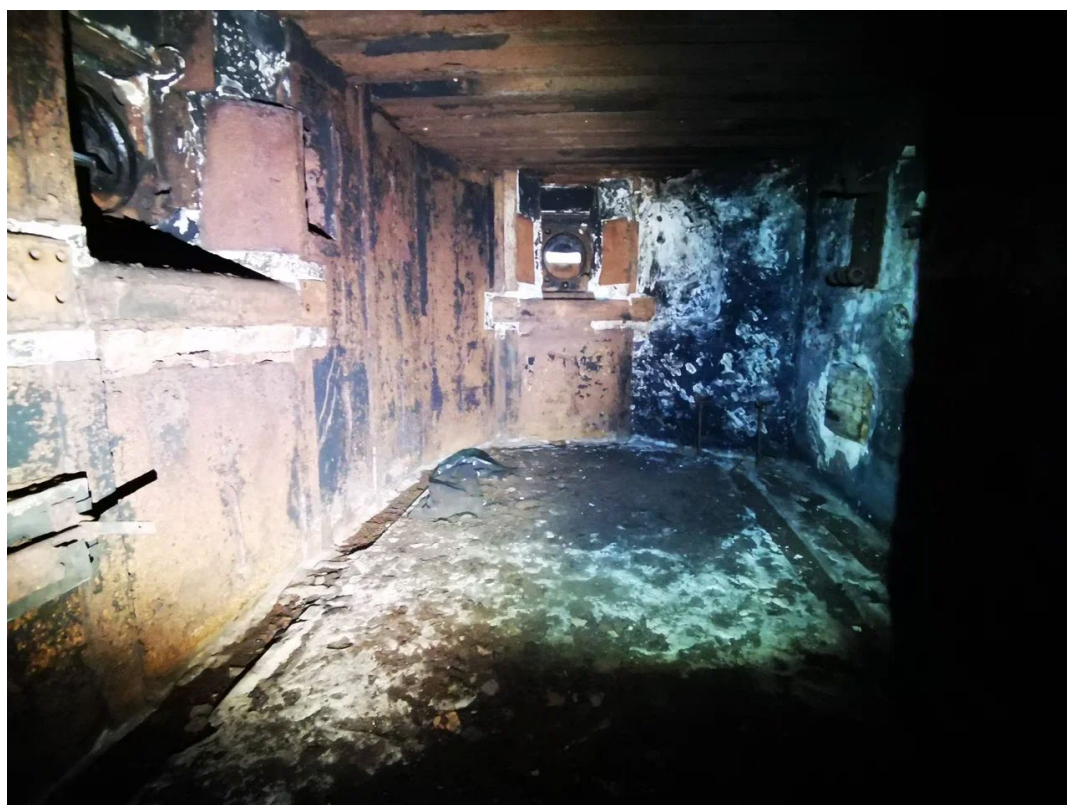
5. Боевое отделение ДОТ со следами пожара и полностью уничтоженным внутренним оборудованием.
