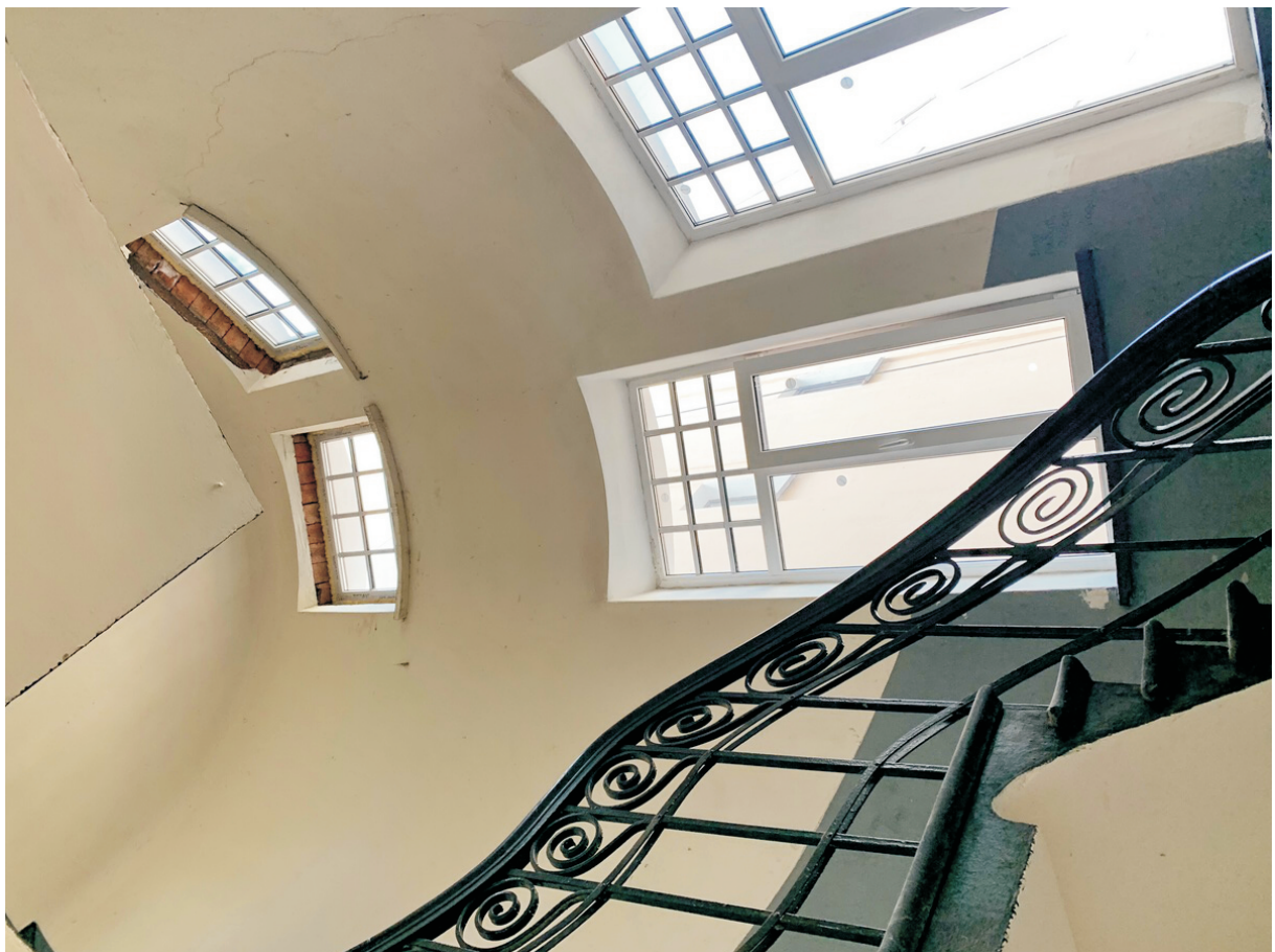
22 ОКН регионального значения “Жилой дом” Ленинградская область, Выборгский муниципальный район, г. Выборг, ул. Железнодорожная, д. 4. Подъезд № 2. Лестничная клетка. Площадка между 3 и 4 этажами. Дата съемки: 02.05.2022 г.
