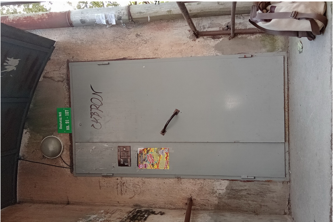
43 ОКН регионального значения “Жилой дом с магазинами Массинена” Ленинградская область, Выборгский муниципальный район, г. Выборг, Ленинградское ш., д. 15. Подъезд № 5. Входная площадка. Дата съемки: 02.05.2022 г.
