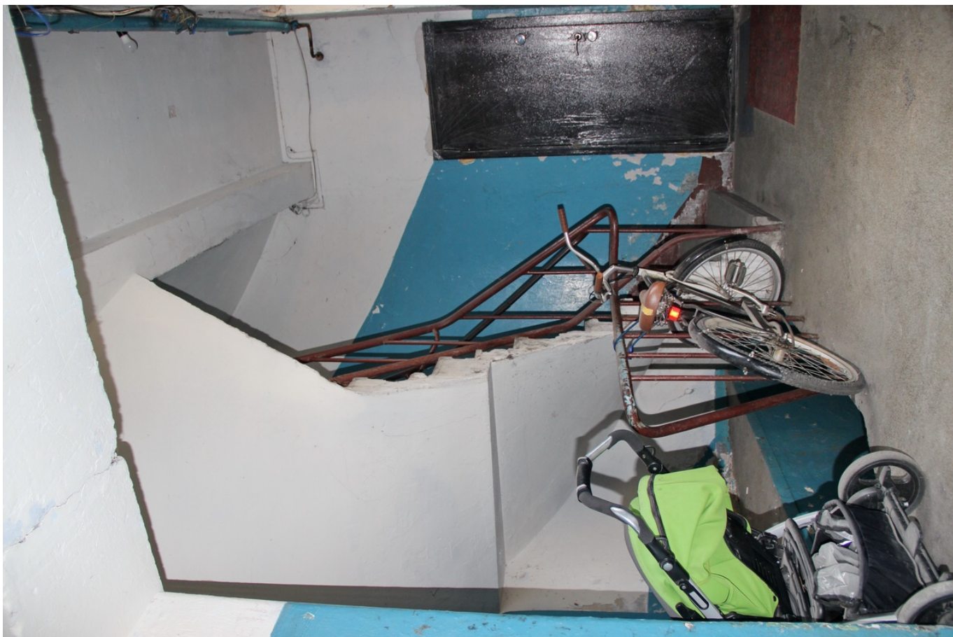
40 ОКН регионального значения “Жилой дом с магазинами Массинена” Ленинградская область, Выборгский муниципальный район, г. Выборг, Ленинградское ш., д. 15. Подъезд № 4. Лестничная клетка без лифта. 1 этаж. Дата съемки: 02.05.2022 г.
