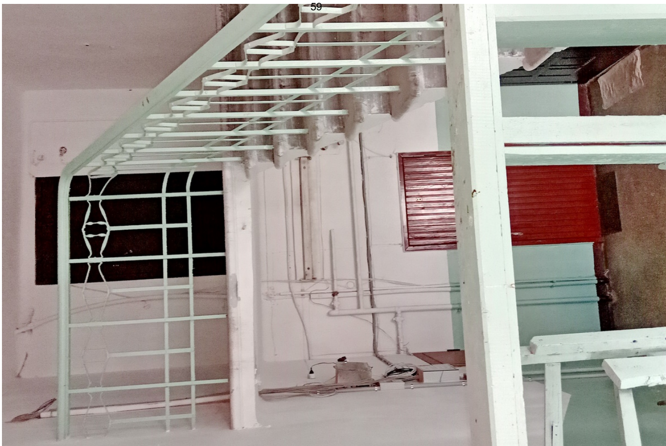
19 ОКН регионального значения “Жилой дом с магазинами Массинена” Ленинградская область, Выборгский муниципальный район, г. Выборг, Ленинградское ш., д. 15. Подъезд № 1. Лестничная клетка. Вид на площадку 5 этажа и площадку входа на чердак. Дата съемки: 02.05.2022 г.
