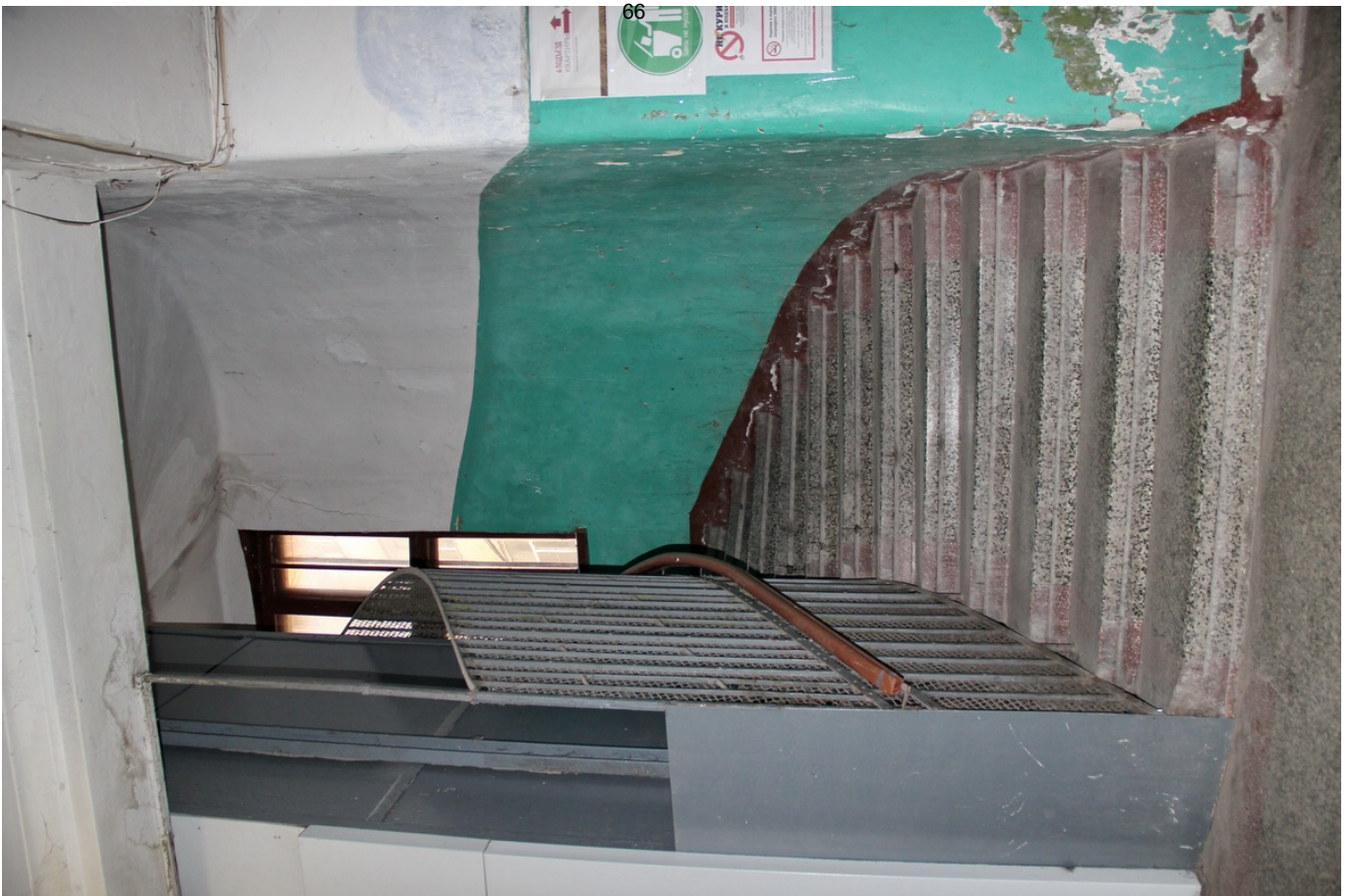
33 ОКН регионального значения “Жилой дом с магазинами Массинена” Ленинградская область, Выборгский муниципальный район, г. Выборг, Ленинградское ш., д. 15. Подъезд № 4. Лестничная клетка с лифтом. Вид в сторону междуэтажной площадки между 1 и 2 этажами. Дата съемки: 02.05.2022 г.
