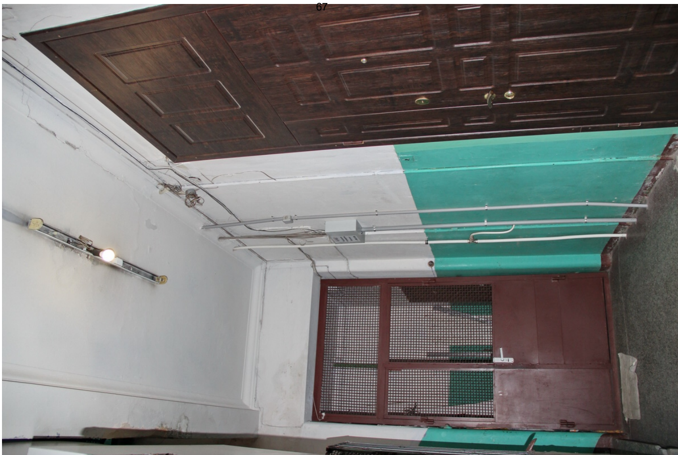
35 ОКН регионального значения “Жилой дом с магазинами Массинена” Ленинградская область, Выборгский муниципальный район, г. Выборг, Ленинградское ш., д. 15. Подъезд № 4. Лестничная клетка с лифтом. 3 этаж. Дата съемки: 02.05.2022 г.
