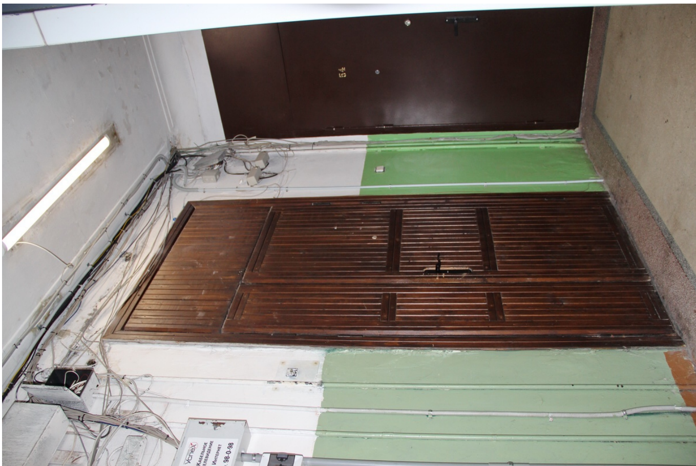
30 ОКН регионального значения “Жилой дом с магазинами Массинена” Ленинградская область, Выборгский муниципальный район, г. Выборг, Ленинградское ш., д. 15. Подъезд № 3. Лестничная клетка. 5 этаж. Дата съемки: 02.05.2022 г.
