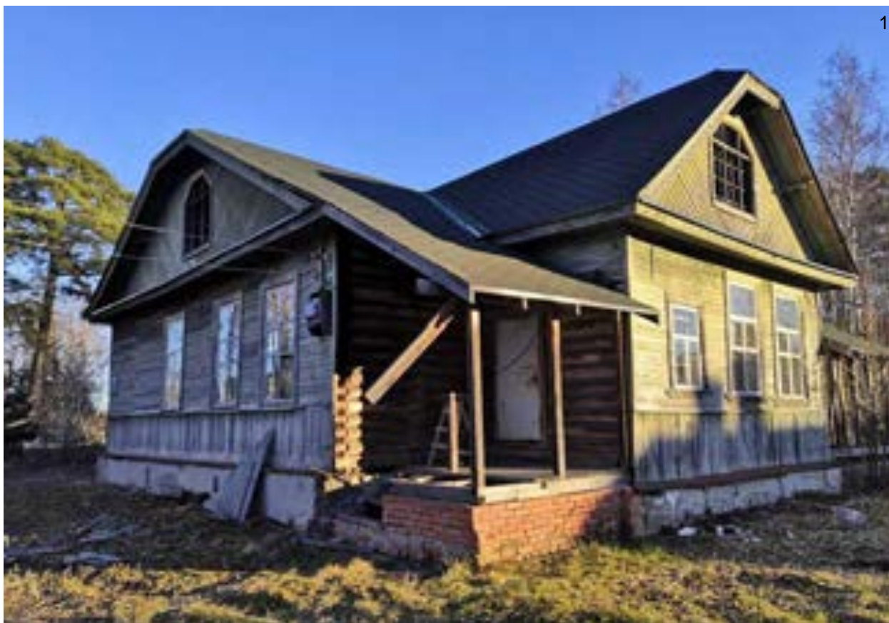
Фото.25. Амбулатория (ул. Приморская, 20) от 08.11.2021 г.
