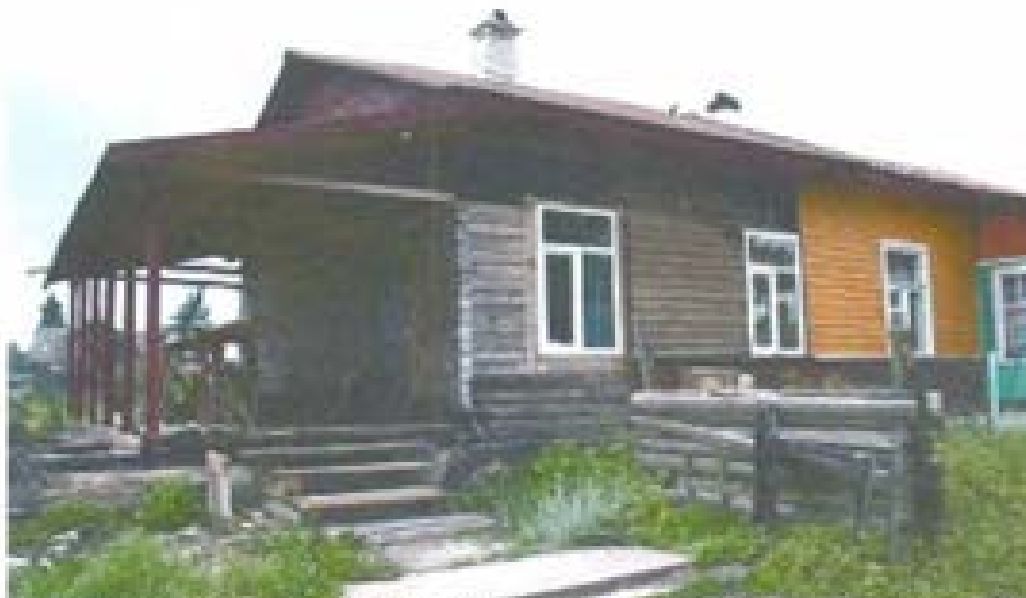
Лоцманское селение. Дом священника. Здание восстанавливается после пожара. Фото 2006 год.
