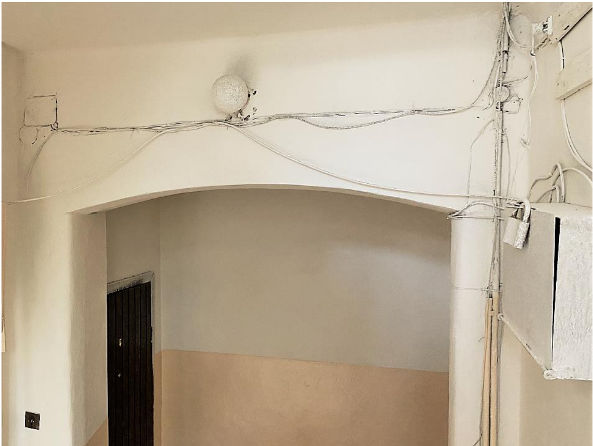
Фото 7. 3-ой этаж лестничной клетки ЛК-1. Расположение электропроводки по стенам с нарушением способа прокладки. Отсутствует аварийное освещение. Дата съемки: 11.04.2022 г. Автор: Прокофьев М.Ф.
