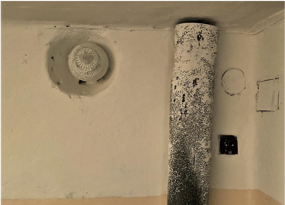
Фото 5. 1-ый этаж лестничной клетки ЛК-1, фрагмент. Отсутствует аварийное освещение. Дата съемки: 11.04.2022 г. Автор: Прокофьев М.Ф.
