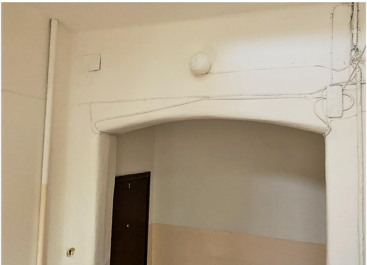
Фото 6. 2-ой этаж лестничной клетки ЛК-1. Расположение электропроводки по стенам с нарушением способа прокладки. Дата съемки: 11.04.2022 г. Автор: Прокофьев М.Ф.
