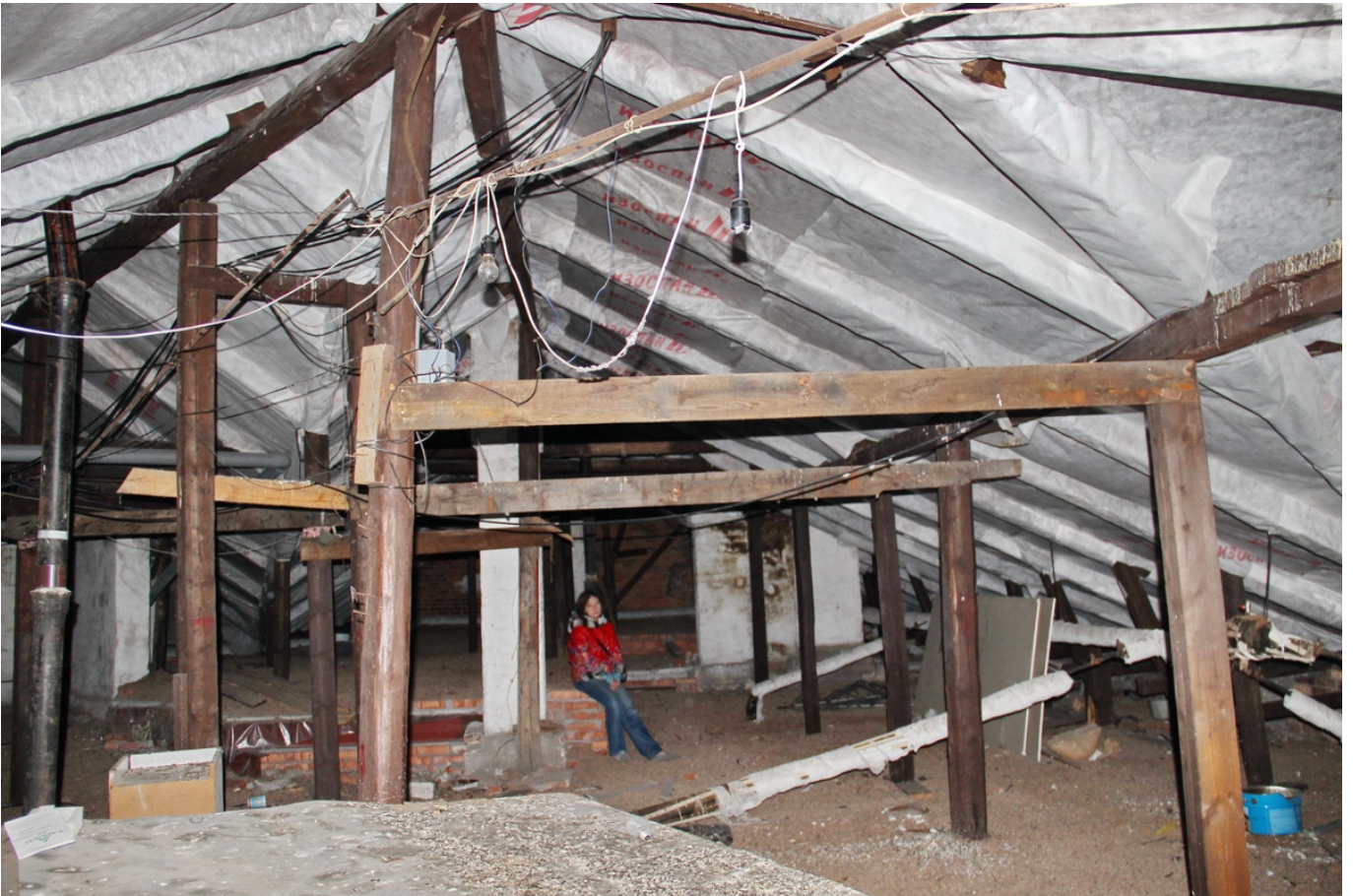
7 ОКН регионального значения “Жилой дом” ул. Выборгская, д. 1. Чердак. Дата съемки: 13.10.2021 г.
