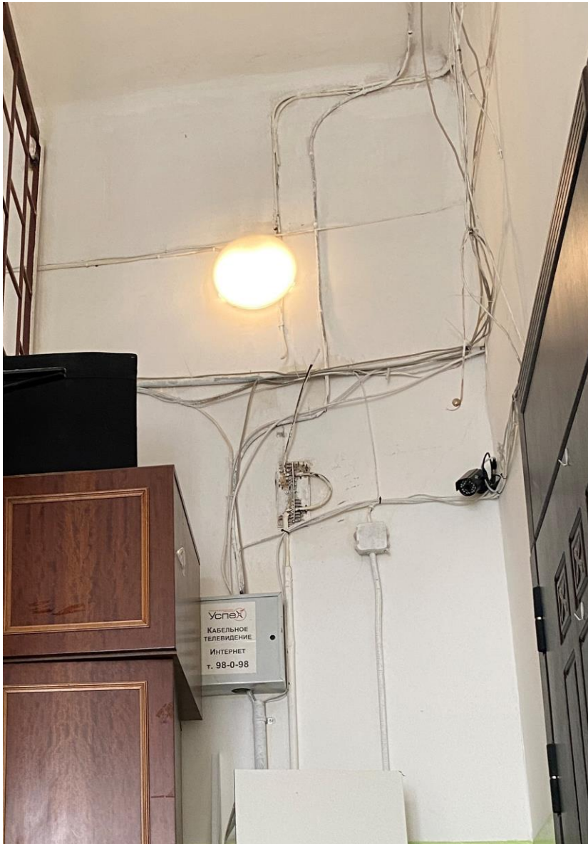
Фото 6. 4-ый этаж лестничной клетки (вход в ул. Ленинградского шоссе). Расположение прокладки электропроводов (частично в гофрированных трубах). Фото 11.04.2022 г. Автор: Куваева Ю.П.
