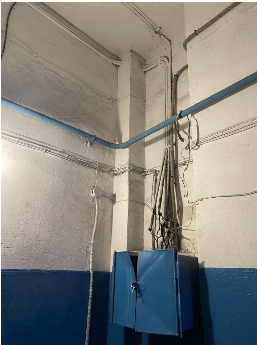
Фото 10. 4-ый этаж лестничной клетки (вход со стороны двора в уличный объем). Расположение прокладки электропроводов по стенам. Фото 11.04.2022 г. Автор: Куваева Ю.П.
