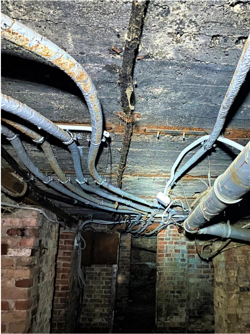
Фото 3. Подвал. Расположение кабеля питания от щитов по перекрытию. Фото 11.04.2022 г. Автор: Куваева Ю.П.
