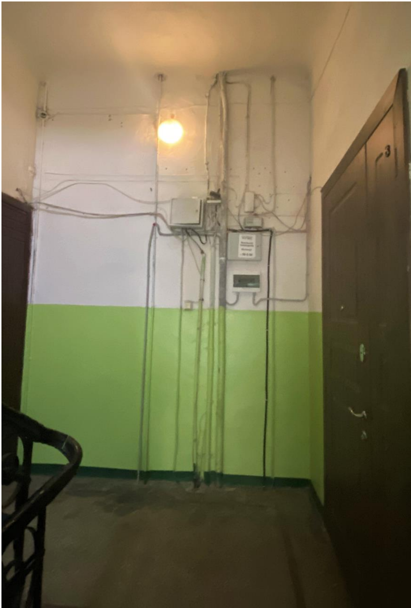
Фото 5. 2-ой этаж лестничной клетки (вход в ул. Ленинградского шоссе). Расположение прокладки электропроводов (частично в гофрированных трубах). Фото 11.04.2022 г. Автор: Куваева Ю.П.
