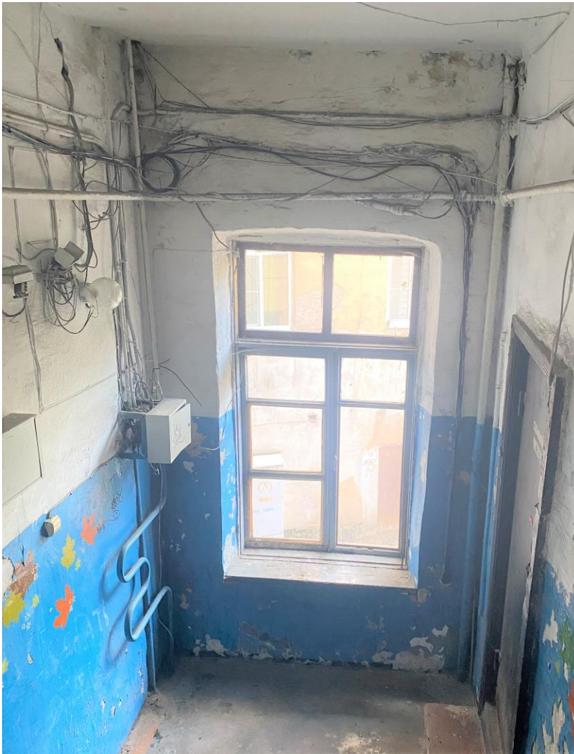
Фото 12. 2-ой этаж лестничной клетки (вход в дворовый корпус). Расположение электропроводки (открытой и в гофре) по стенам. Фото 11.04.2022 г. Автор: Куваева Ю.П.
