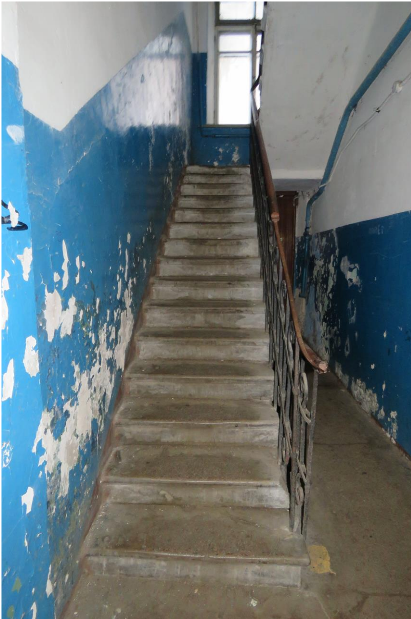
Фото 8. 1-ый этаж лестничной клетки (вход со стороны двора в уличный объем). Расположение электропроводки по стене. Фото 11.04.2022 г. Автор: Куваева Ю.П.
