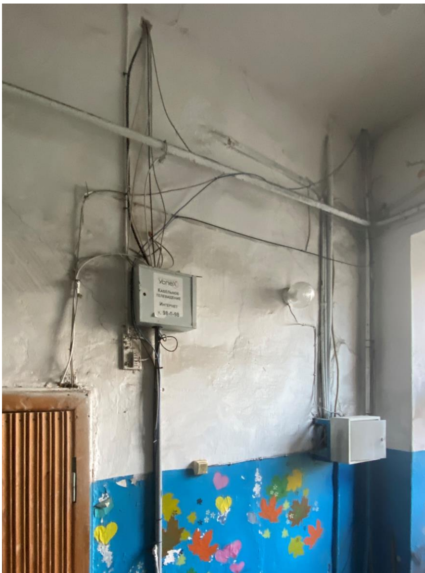
Фото 14. 3-ий этаж лестничной клетки (вход в дворовый корпус). Расположение электропроводки (открытой и в гофре) по стенам. Фото 11.04.2022 г. Автор: Куваева Ю.П.
