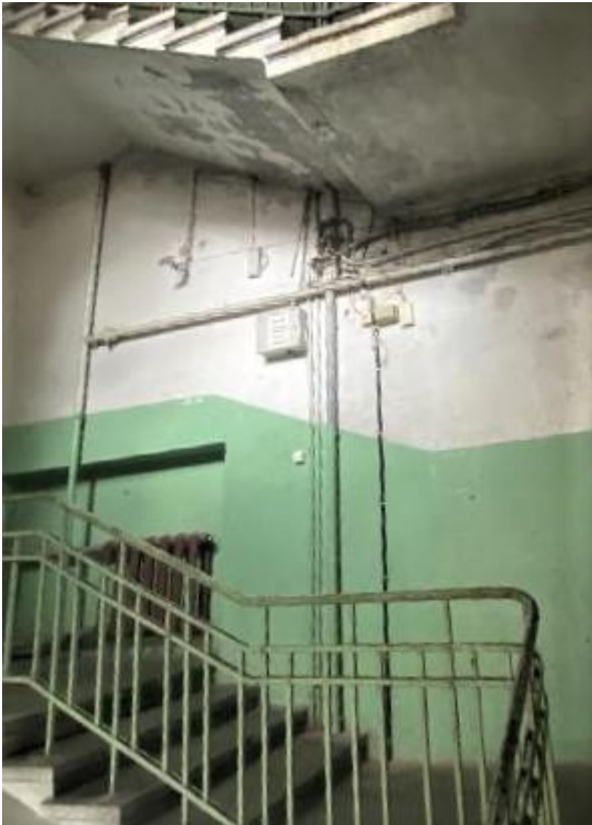
Фото 20. Лестничная клетка в 4-ом подъезде. 2-ой этаж. Расположение электропроводки по стене с нарушением способа прокладки. Дата съемки: 11.04.2022 г. Автор: Куваева Ю.П.
