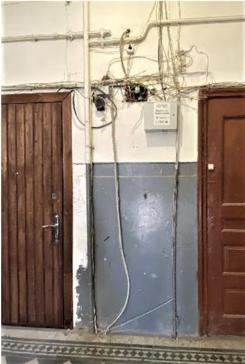
Фото 23. Лестничная клетка в 6-ом подъезде. 3-ий этаж. Расположение электропроводки (открытой и в гибких кабелях) с нарушением способа прокладки. Дата съемки: 11.04.2022 г. Автор: Куваева Ю.П.
