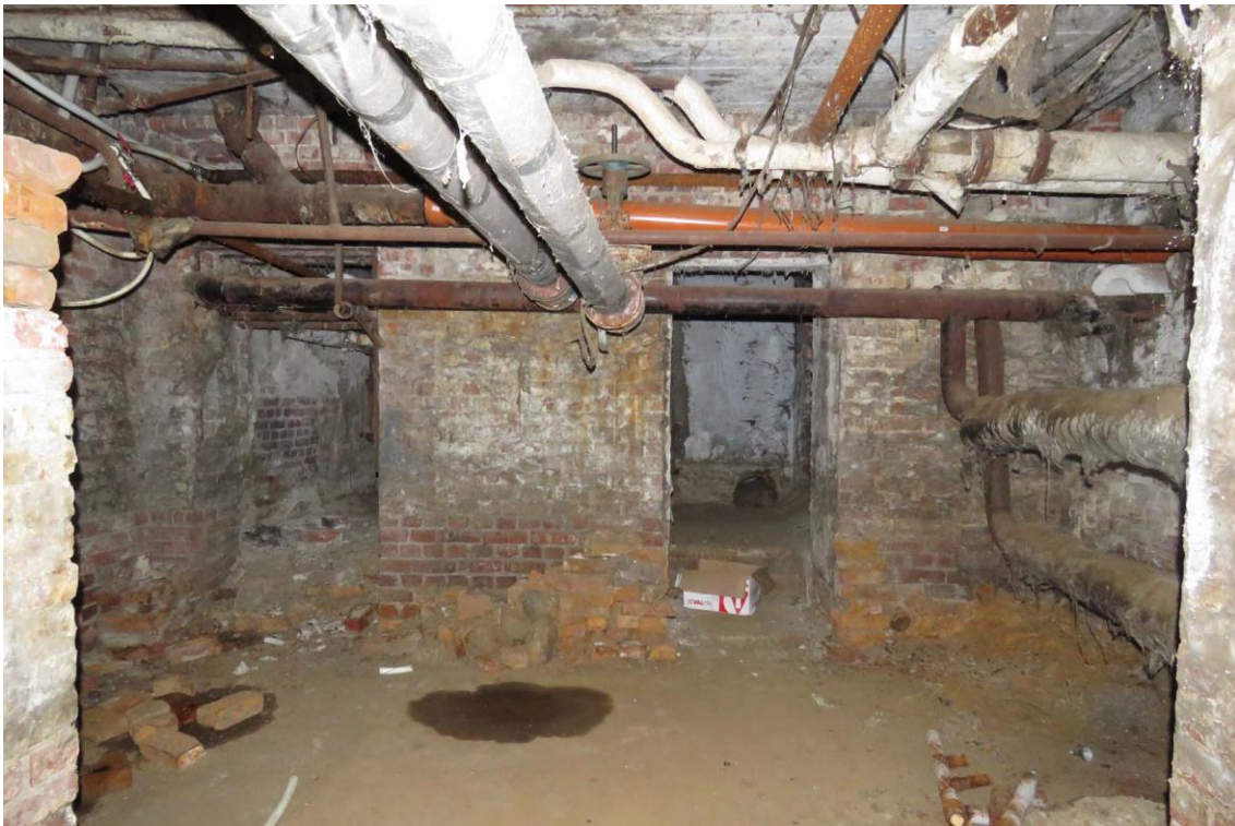
Фото 10. Расположение электропроводки с нарушением способа прокладки. Дата съемки: 11.04.2022 г. Автор: Куваева Ю.П.
