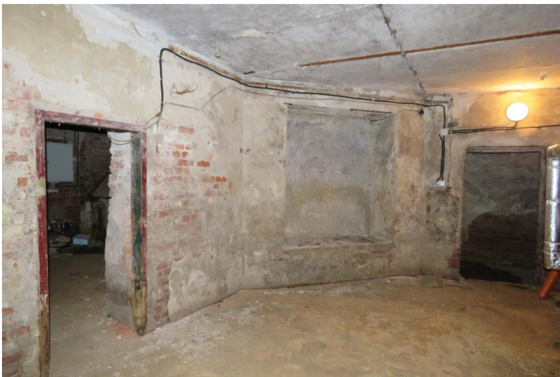
Фото 6. Подвал. Расположение электропроводки по стенам помещения с нарушением способа прокладки. Дата съемки: 11.04.2022 г. Автор: Куваева Ю.П.
