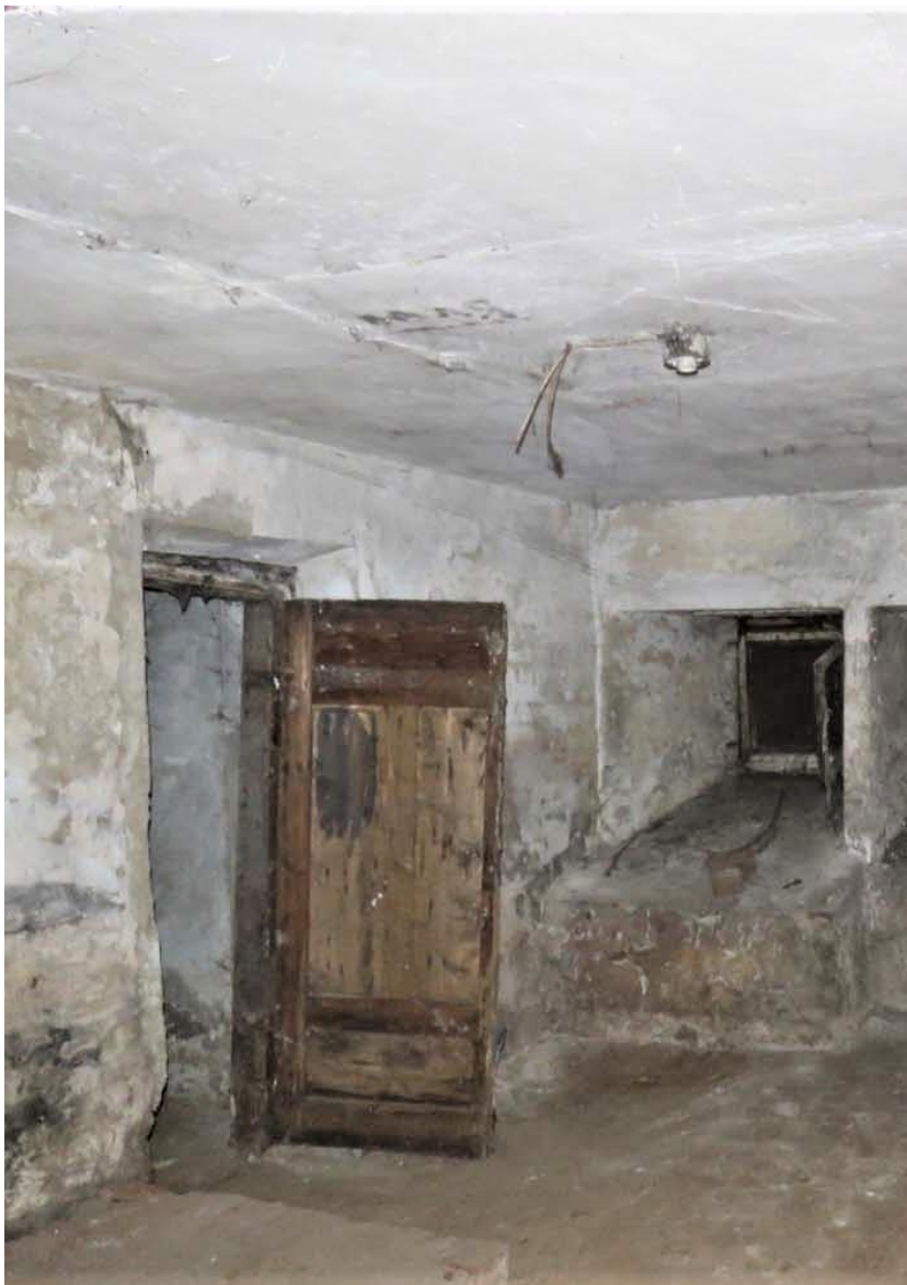
Фото 12. Остатки электропроводки на потолке. Дата съемки: 11.04.2022 г. Автор: Куваева Ю.П.
