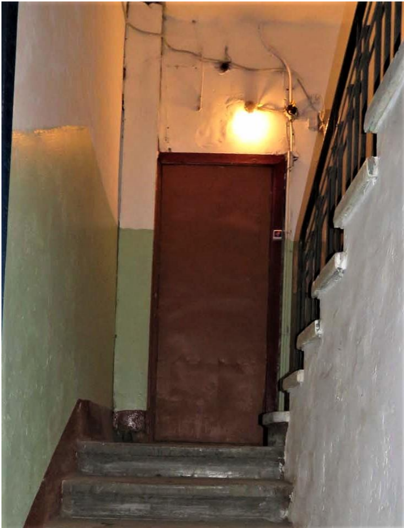
Фото 17. Дворовая лестничная клетка (уличный корпус). 1-ый этаж. Расположение электропроводки по стенам с нарушением способа прокладки. Дата съемки: 11.04.2022 г. Автор: Куваева Ю.П.
