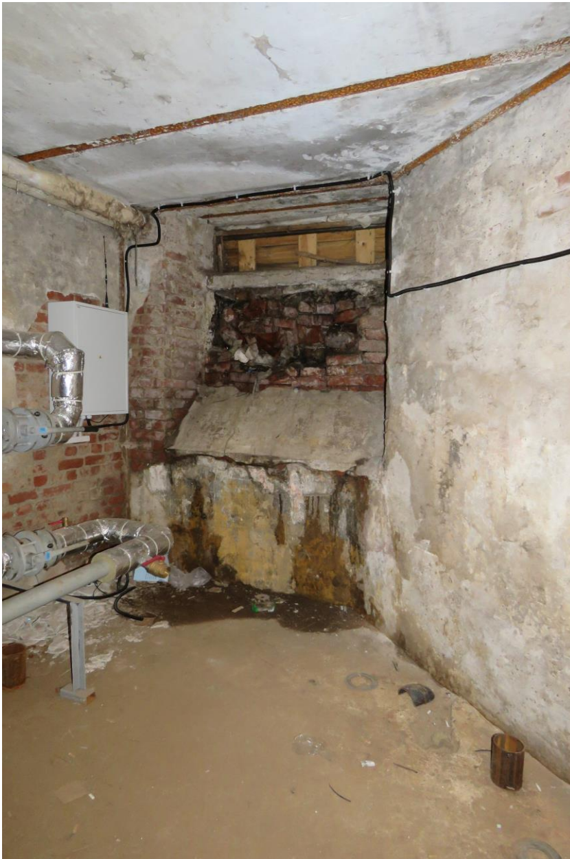
Фото 8. Расположение электропроводки по стенам помещения с нарушением способа прокладки. Дата съемки: 11.04.2022 г. Автор: Куваева Ю.П.
