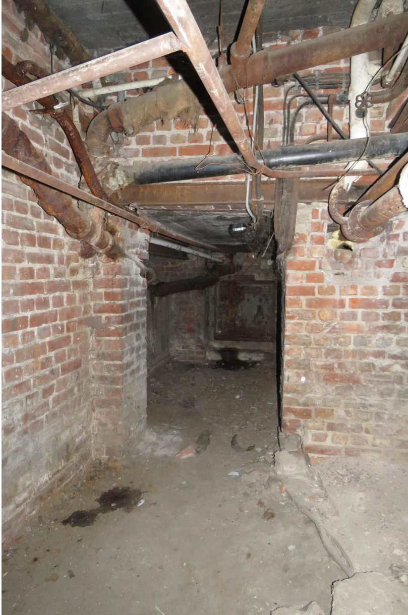
Фото 13. Помещение подвала. Расположение электропроводки с нарушением способа прокладки. Дата съемки: 11.04.2022 г. Автор: Куваева Ю.П.
