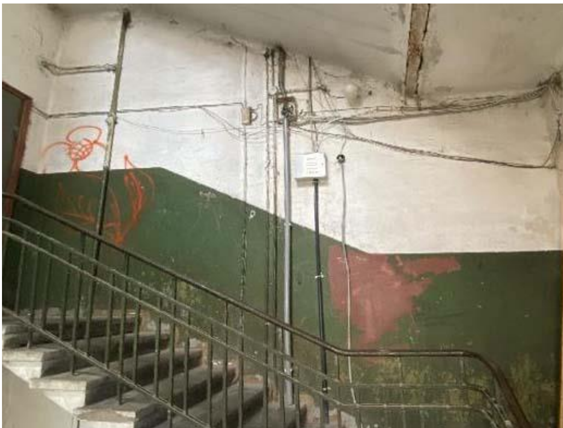
Фото 21. Лестничная клетка в 4-ом подъезде. 3-ий этаж. Расположение электропроводки по стене с нарушением способа прокладки. Дата съемки: 11.04.2022 г. Автор: Куваева Ю.П.
