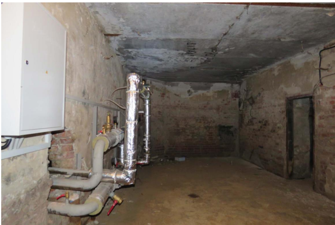
Фото 5. Подвал. Расположение щита и электропроводки по стенам. Дата съемки: 11.04.2022 г. Автор: Куваева Ю.П.
