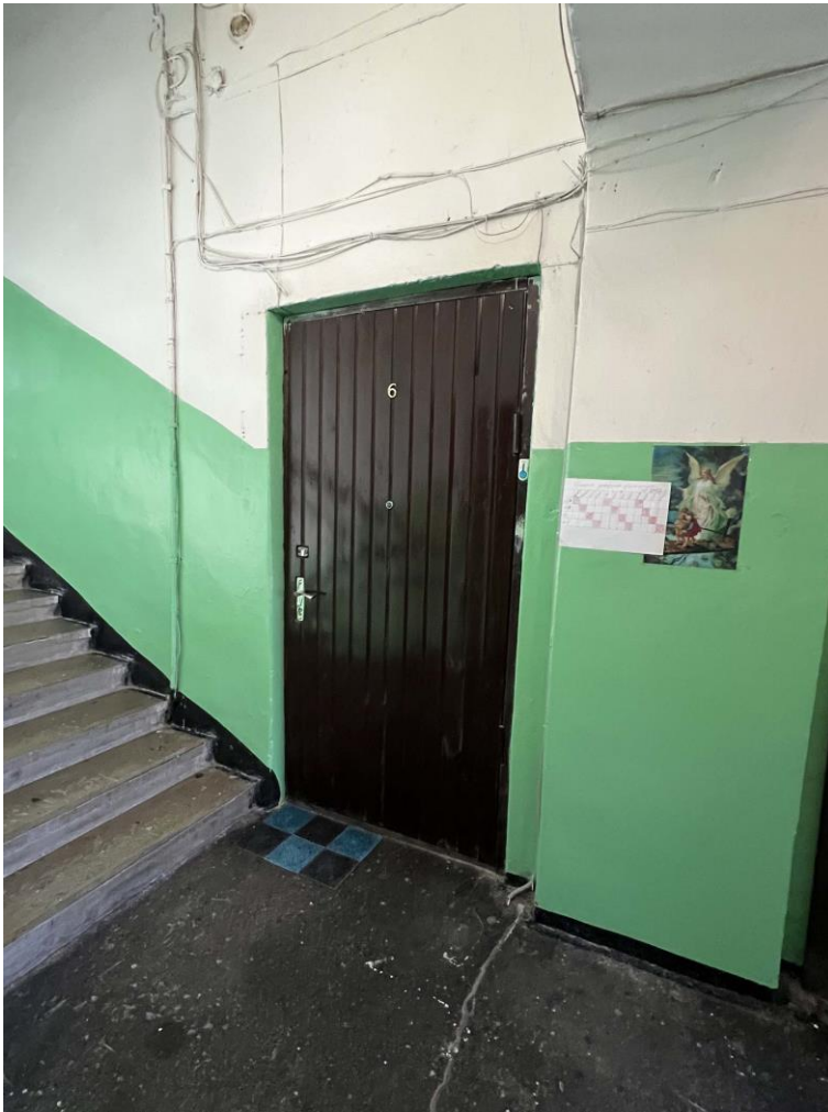
Фото 10. Прокладка электропроводов по стене коридора 2-го этажа над квартирой. Дата съемки: 11.04.2022 г. Автор: Куваева Ю.П.
