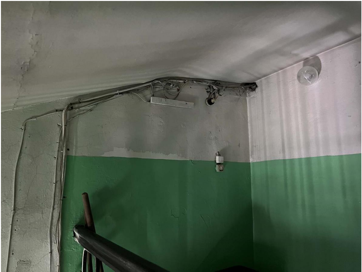
Фото 12. Прокладка электропроводов по стене в уровне чердака на лестничной клетке. Дата съемки: 11.04.2022 г. Автор: Куваева Ю.П.
