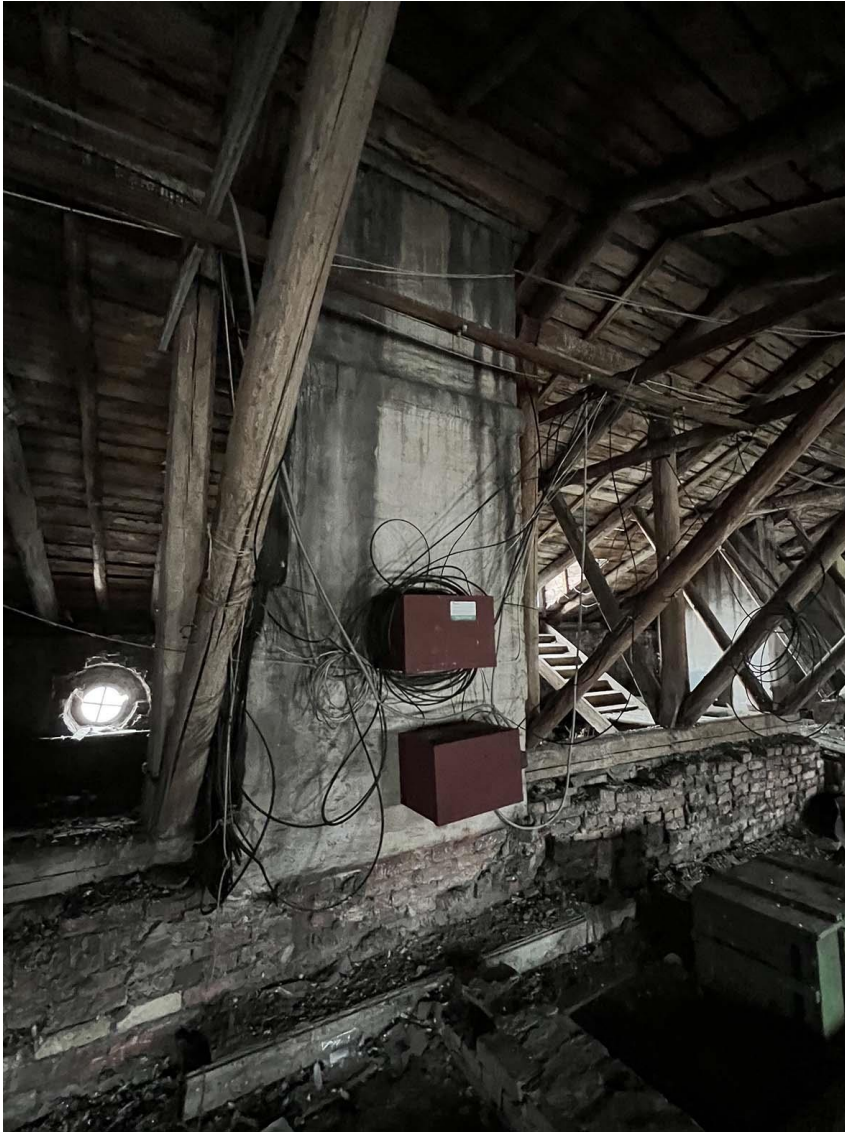
Фото 20. Чердак. Помещение в юго-восточной половине здания. Крепление электрощитов к стене вентиляционной шахты. Дата съемки: 11.04.2022 г. Автор: Куваева Ю.П.
