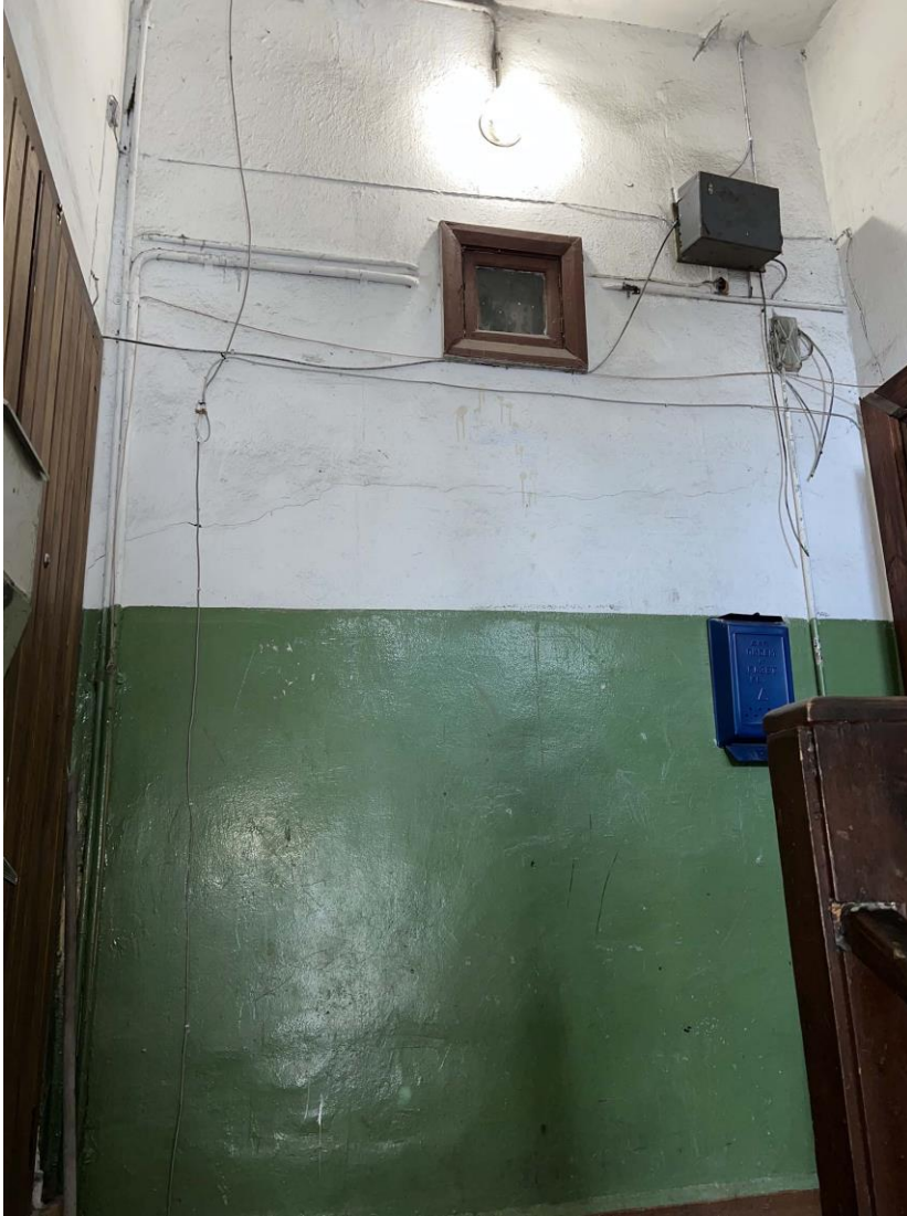
Фото 8. Лестничная клетка. 1-ый подъезд. Крепление электропроводки к стене 2-го этажа. Дата съемки: 11.04.2022 г. Автор: Куваева Ю.П.
