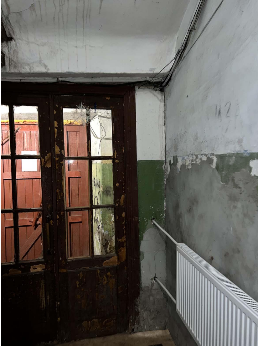
Фото 5. Лестничная клетка. 1-ый подъезд, 1-ый этаж. Крепление электропроводки к стене тамбура. Дата съемки: 11.04.2022 г. Автор: Куваева Ю.П.
