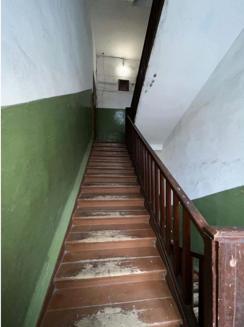
Фото 7. Лестничная клетка. 1-ый подъезд. Общий вид помещения с промежуточной площадки. Дата съемки: 11.04.2022 г. Автор: Куваева Ю.П.
