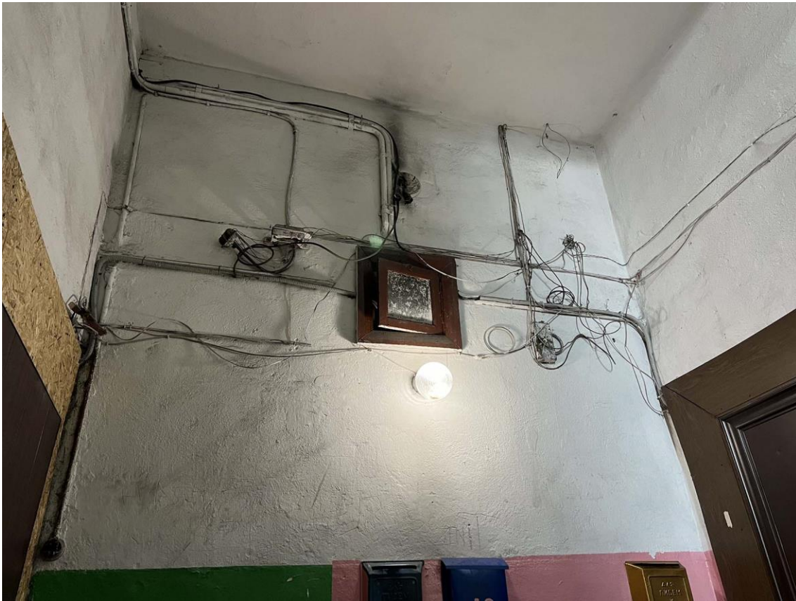
Фото 14. Лестничная клетка. 3-ий подъезд. Крепление открытой электропроводки к стене 1-го этажа. Дата съемки: 11.04.2022 г. Автор: Куваева Ю.П.
