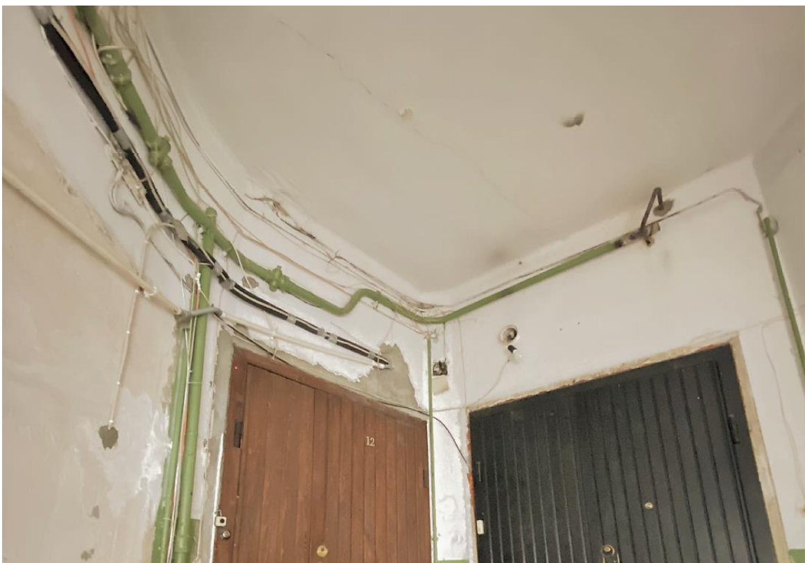
Фото 9. 3-ий этаж лестничной клетки ЛК-2. Расположение электропроводки по стенам с нарушением способа прокладки. Отсутствуют плафон светильника и аварийное освещение. Дата съемки: 11.04.2022 г. Автор: Прокофьев М.Ф.
