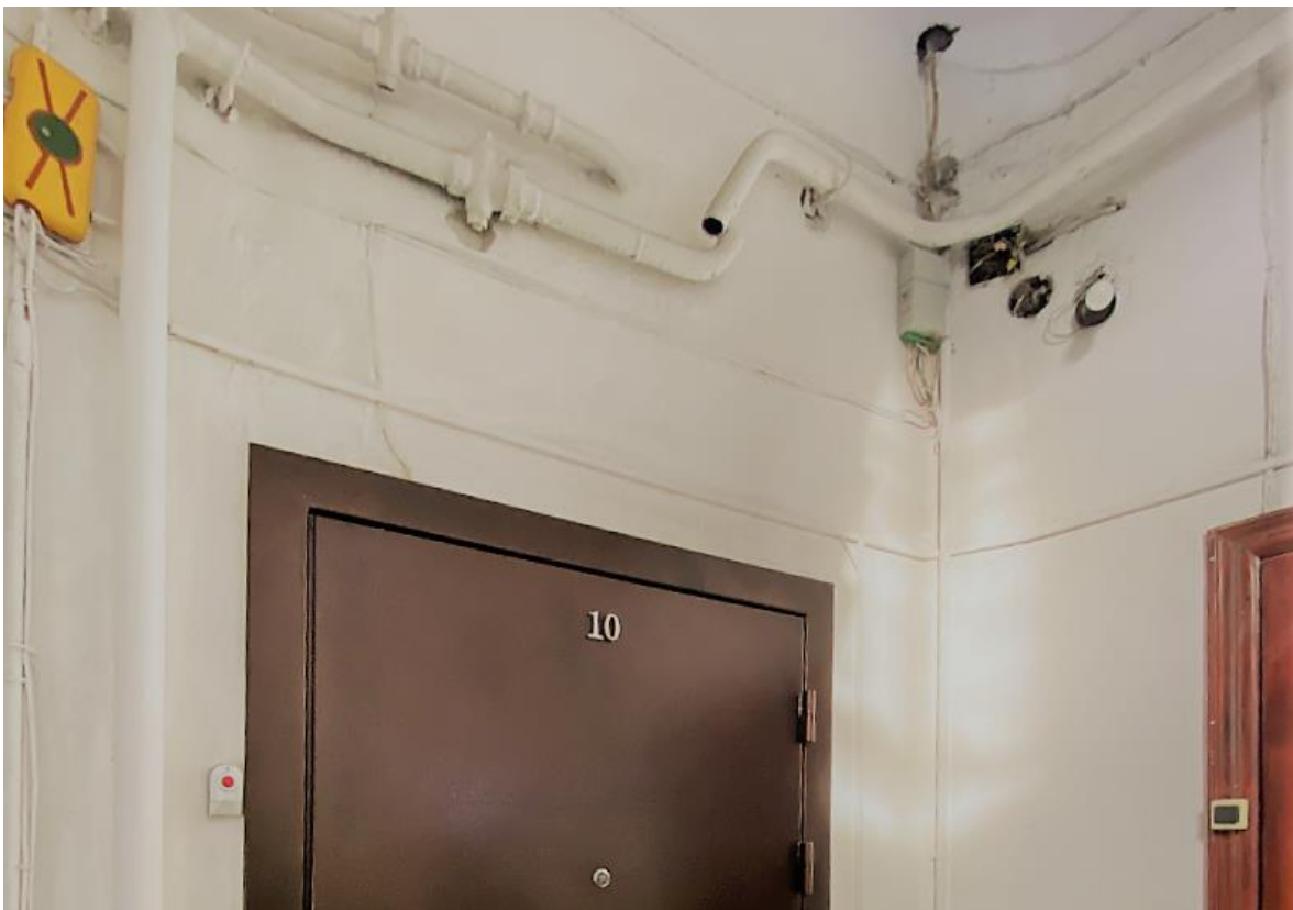
Фото 8. 2-ой этаж лестничной клетки ЛК-2. Расположение электропроводки по стенам с нарушением способа прокладки. Отсутствует аварийное освещение. Дата съемки: 11.04.2022 г. Автор: Прокофьев М.Ф.
