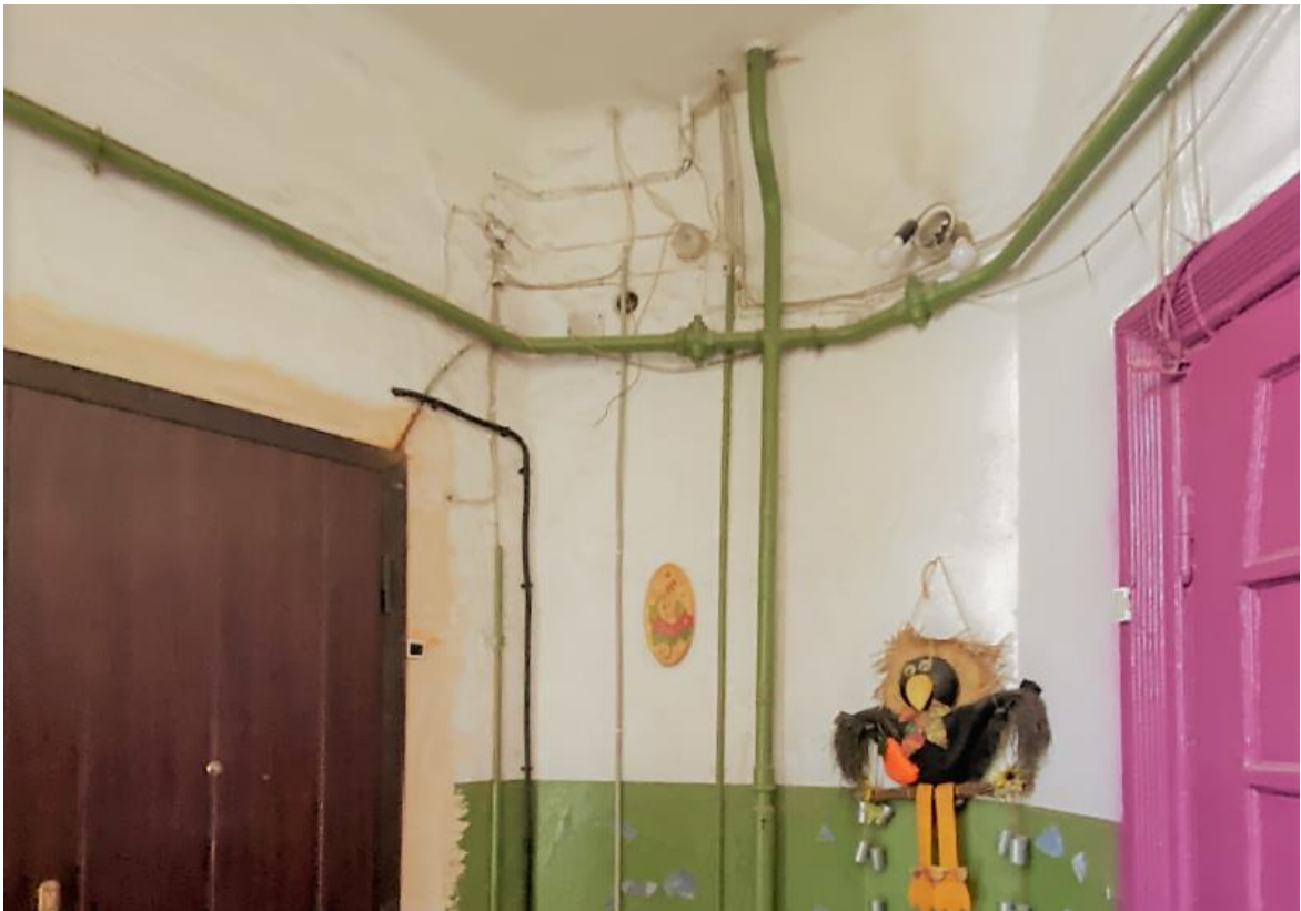
Фото 7. 2-ой этаж лестничной клетки ЛК-1. Расположение электропроводки по стенам с нарушением способа прокладки. Отсутствуют плафон светильника и аварийное освещение. Дата съемки: 11.04.2022 г. Автор: Прокофьев М.Ф.
