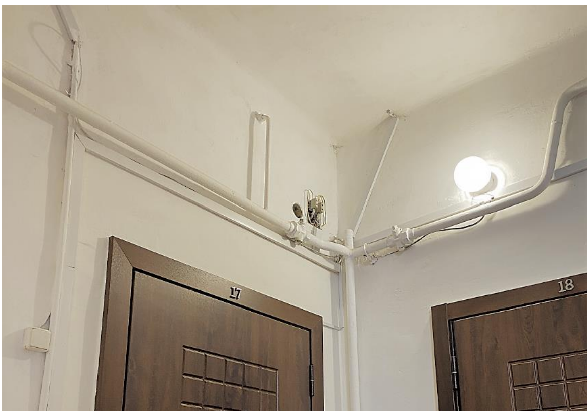
Фото 10. 3-ий этаж лестничной клетки ЛК-3. Расположение электропроводки по стенам с нарушением способа прокладки. Отсутствует аварийное освещение. Дата съемки: 11.04.2022 г. Автор: Прокофьев М.Ф.
