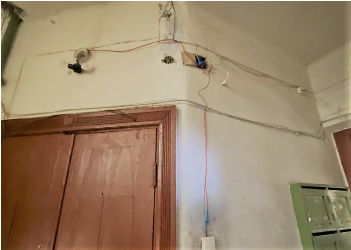
Фото 5. 1-ый этаж лестничной клетки ЛК-2. Расположение электропроводки по стенам с нарушением способа прокладки. Отсутствует аварийное освещение. Дата съемки: 11.04.2022 г. Автор: Прокофьев М.Ф.
