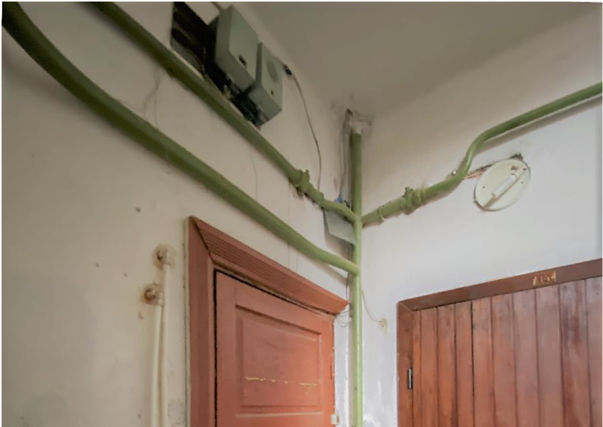
Фото 6. 1-ый этаж лестничной клетки ЛК-3. Расположение электропроводки по стенам с нарушением способа прокладки. Отсутствует аварийное освещение. Дата съемки: 11.04.2022 г. Автор: Прокофьев М.Ф.
