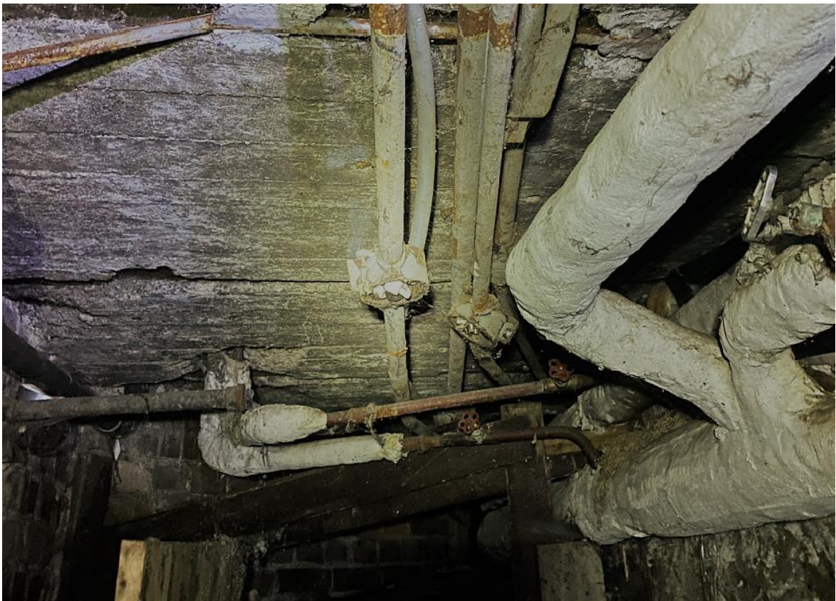
Фото 4. Подвал. Металлические трубы поражены коррозией. Дата съемки: 11.04.2022 г. Автор: Прокофьев М.Ф.
