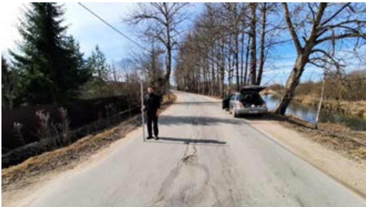
Илл.116. Ленинградская обл, Гатчинский р-н, д. Мыза-Ивановка-2021. Точка фотофиксации 57. Вид с ЮВ.
