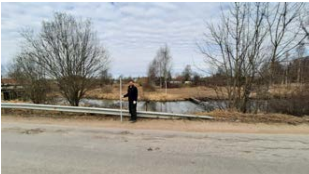
Илл.77. Ленинградская обл, Гатчинский р-н, д. Мыза-Ивановка-2021. Точка фотофиксации 34. Вид с ЮВ.
