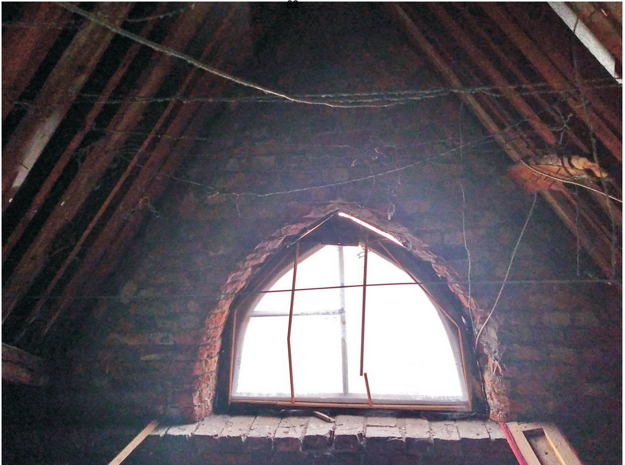
27 ОКН регионального значения “Жилой дом А.П. Воробьева” Ленинградская область, Выборгский муниципальный район, г. Выборг, ул. Майорова, д. 4. Чердак. Дата съемки: 02.05.2022 г.
