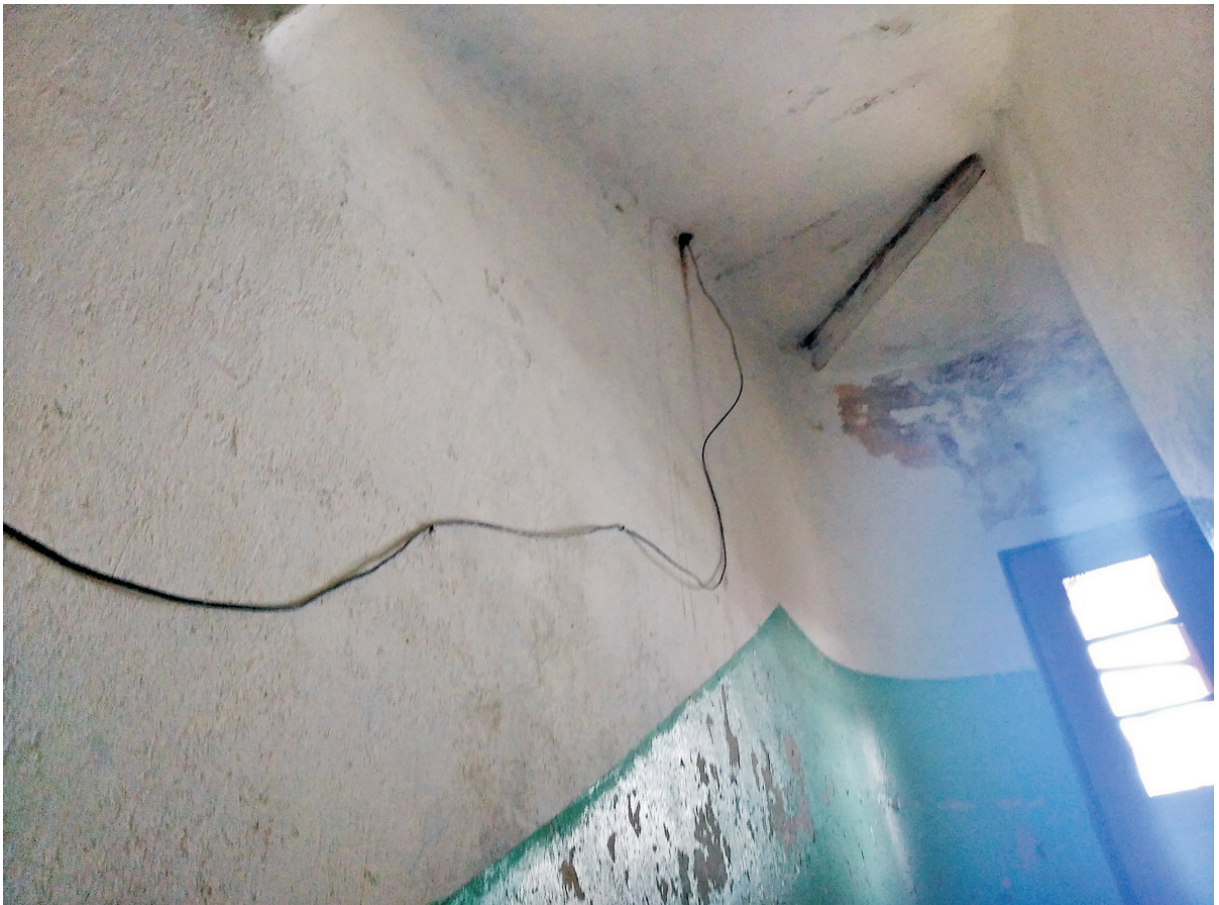
18 ОКН регионального значения “Жилой дом А.П. Воробьева” Ленинградская область, Выборгский муниципальный район, г. Выборг, ул. Майорова, д. 4. Подъезд № 2. Лестничная клетка. Междуэтажная площадка между 2 и 3 этажами. Дата съемки: 02.05.2022 г.
