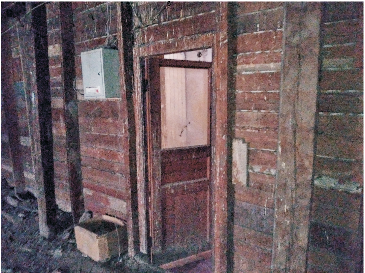
25 ОКН регионального значения “Жилой дом А.П. Воробьева” Ленинградская область, Выборгский муниципальный район, г. Выборг, ул. Майорова, д. 4. Вход на чердак. Дата съемки: 02.05.2022 г.
