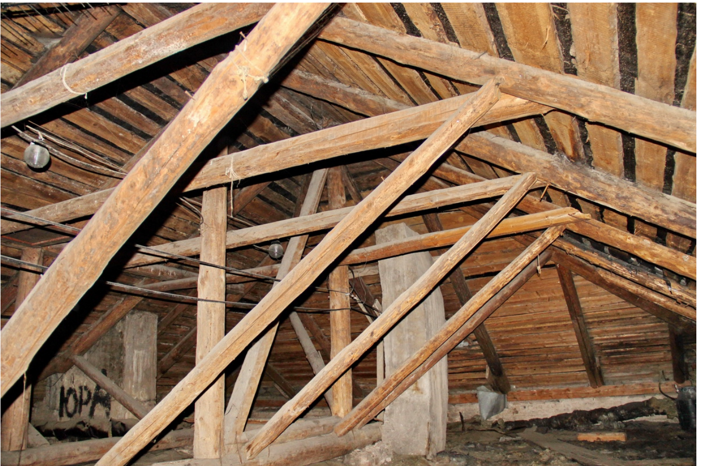
26 ОКН регионального значения “Жилой дом” Ленинградская область, Кингисеппский муниципальный район, г. Кингисепп, ул. Жукова, д. 14. Чердак. Дата съемки: 08.06.2022 г.
