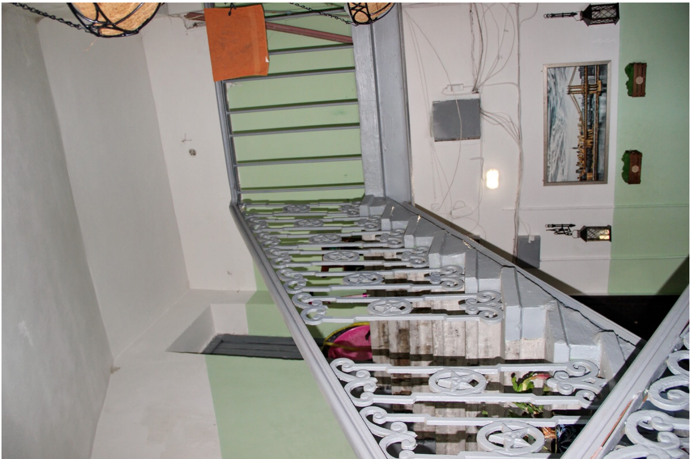
18 ОКН регионального значения “Жилой дом” Ленинградская область, Кингисеппский муниципальный район, г. Кингисепп, ул. Жукова, д. 12. Подъезд № 3. Лестничная клетка. Вид на площадку чердака. Дата съемки: 08.06.2022 г.
