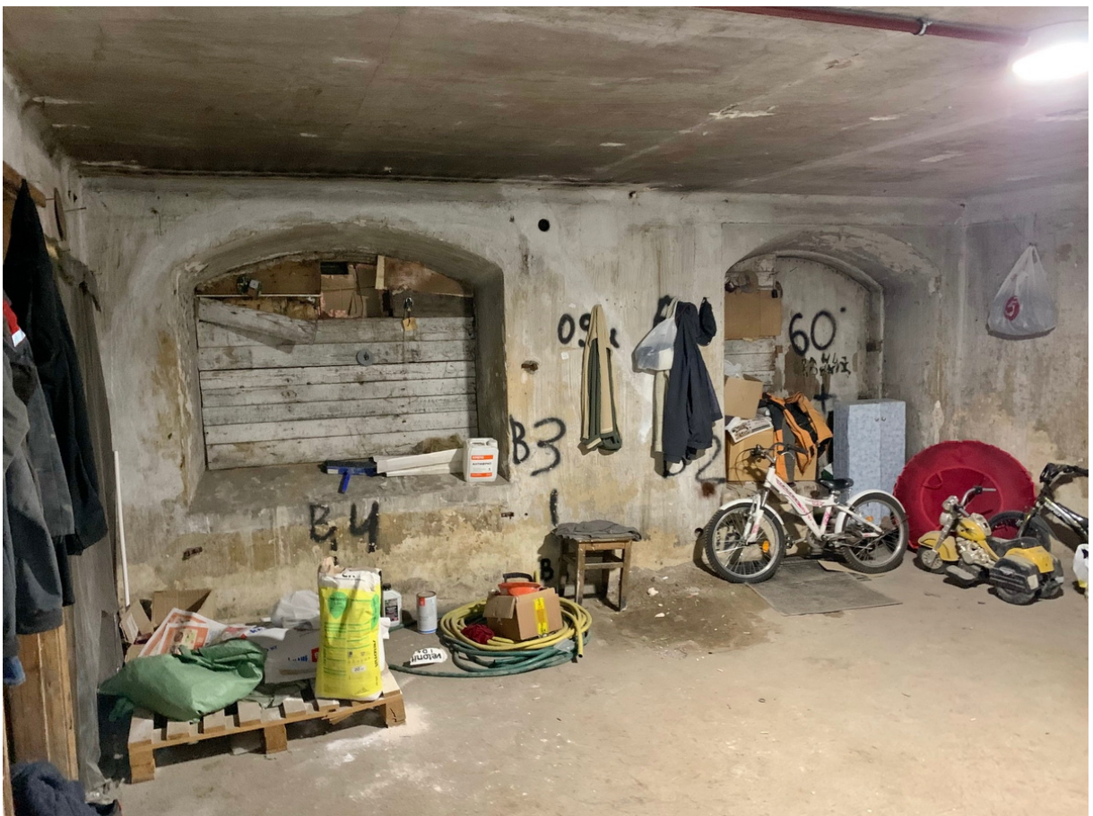
14 ОКН регионального значения “Жилой дом со службами К. Клоуберга” Ленинградская область, Выборгский муниципальный район, г. Выборг, ул. Сторожевой башни, д. 18. Подвал № 1. Помещение 3. Дата съемки: 02.05.2022 г.
