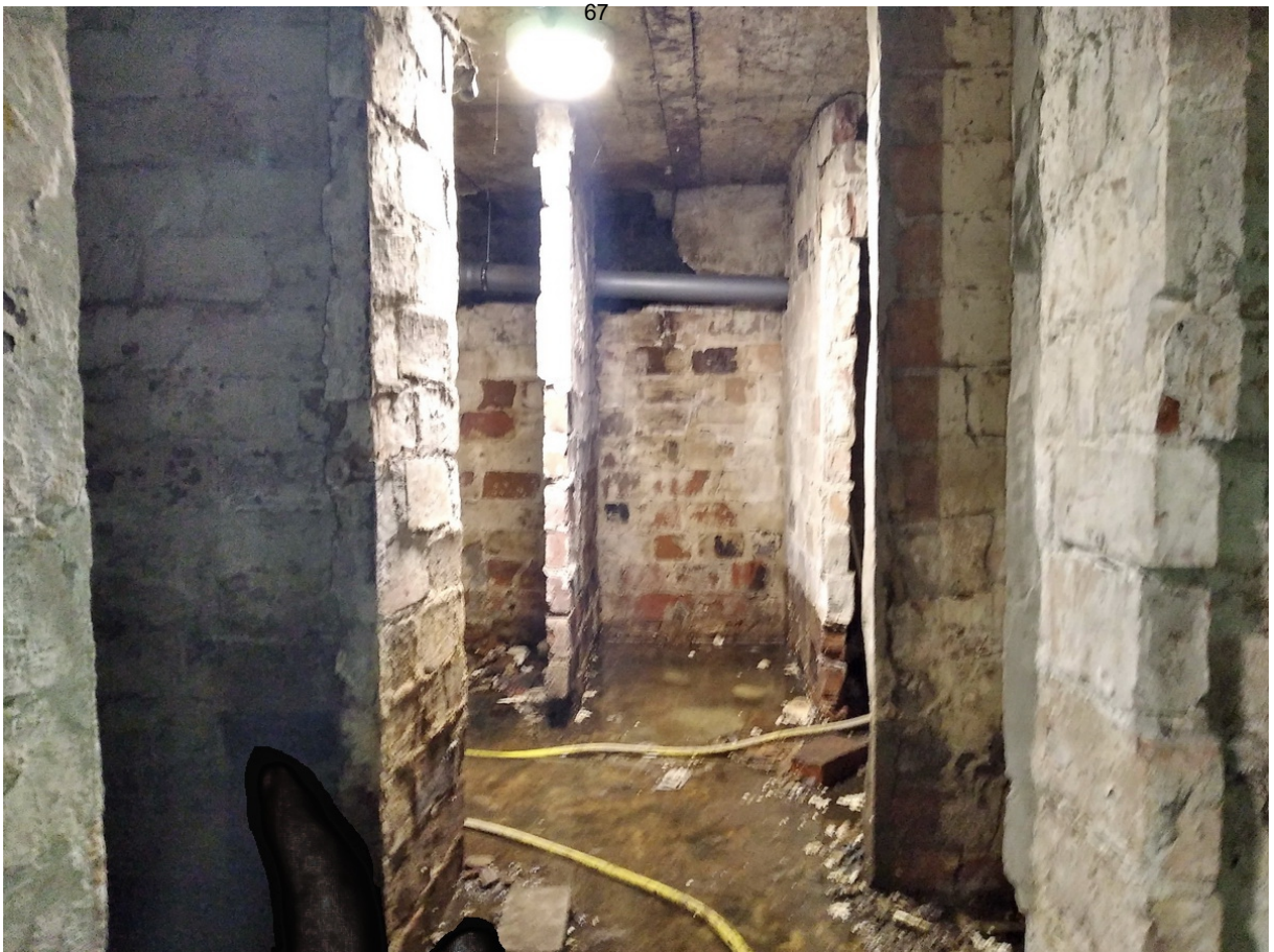
35 ОКН регионального значения “Жилой дом со службами К. Клоуберга” Ленинградская область, Выборгский муниципальный район, г. Выборг, ул. Сторожевой башни, д. 18. Подвал № 3. Помещение 1. Дата съемки: 02.05.2022 г.
