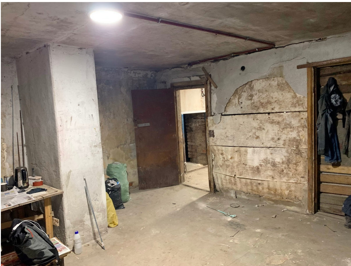
16 ОКН регионального значения “Жилой дом со службами К. Клоуберга” Ленинградская область, Выборгский муниципальный район, г. Выборг, ул. Сторожевой башни, д. 18. Подвал № 1. Помещение 3. Дата съемки: 02.05.2022 г.
