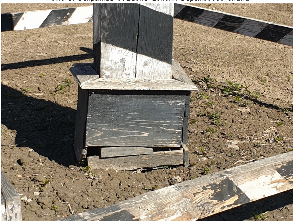
Фото 6. Разрушение цоколя Верстового знака
