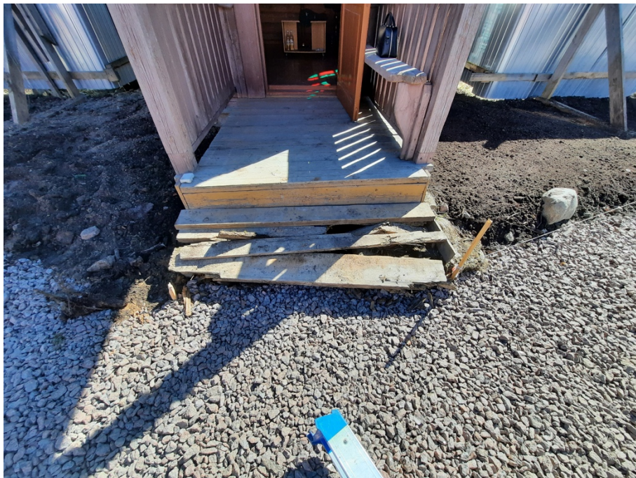
Фото 5. Вид на крыльцо. Разрушение ступени
