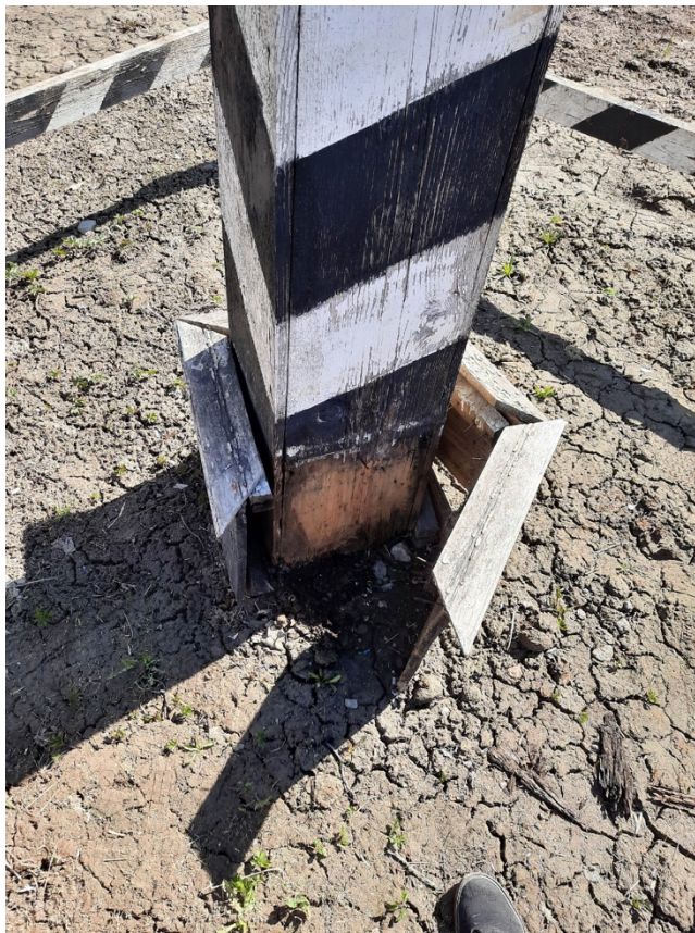
Фото 5. Разрушение цокольной части Верстового знака
