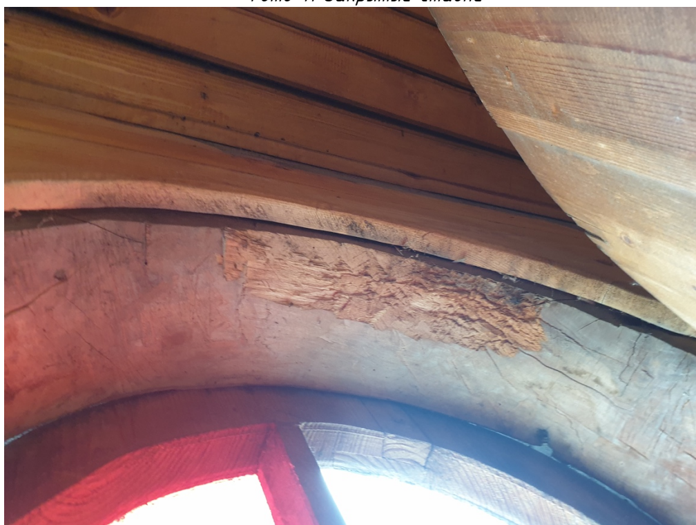
Фото 8. Деструкция древесины в оконной коробке
