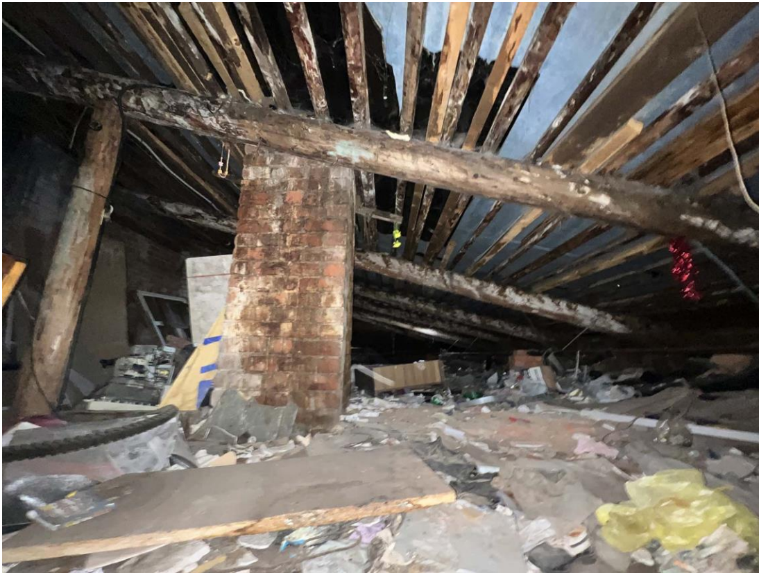
Фото 48. «Жилой флигель для рабочих с баней и конюшней». Чердак. Общий вид помещения с юго-востока. Дата съемки: 25.05.2022 г. Автор съемки: Куваева Ю.П.
