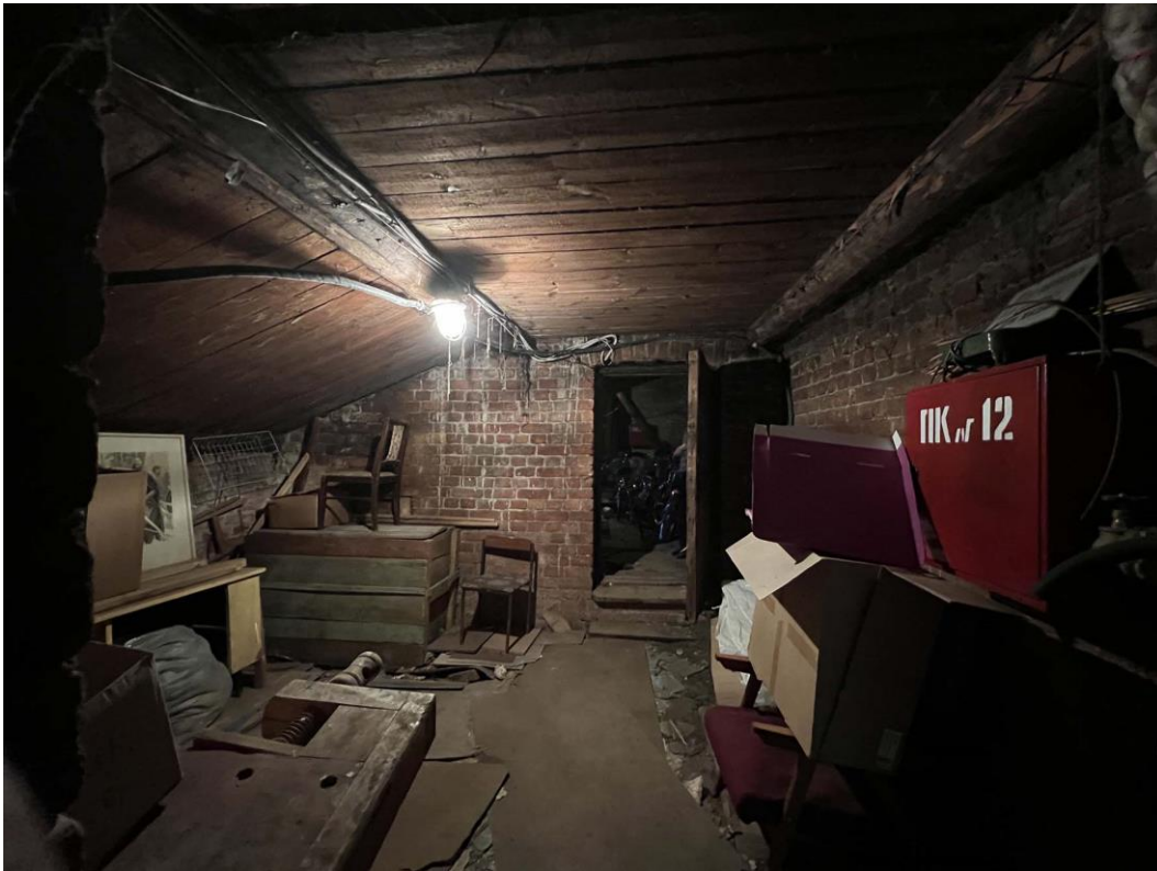
Фото 16. «Жилой дом с лавками, конторой, погребом и пекарней». Чердак. Общий вид входа в помещение чердака с северо-запада. Дата съемки: 25.05.2022 г. Автор съемки: Куваева Ю.П.
