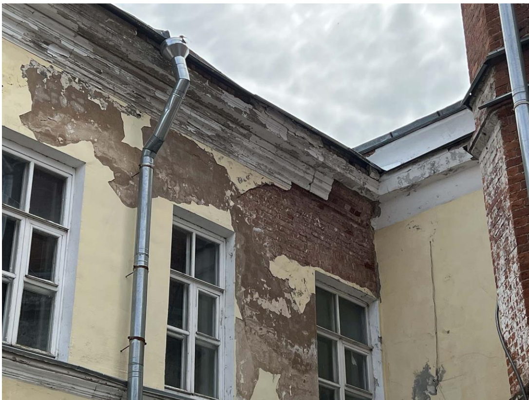
Фото 12. «Жилой дом с лавками, конторой, погребом и пекарней». Фрагмент южного дворового угла. Разрушения карниза. Дата съемки: 25.05.2022 г. Автор съемки: Куваева Ю.П.
