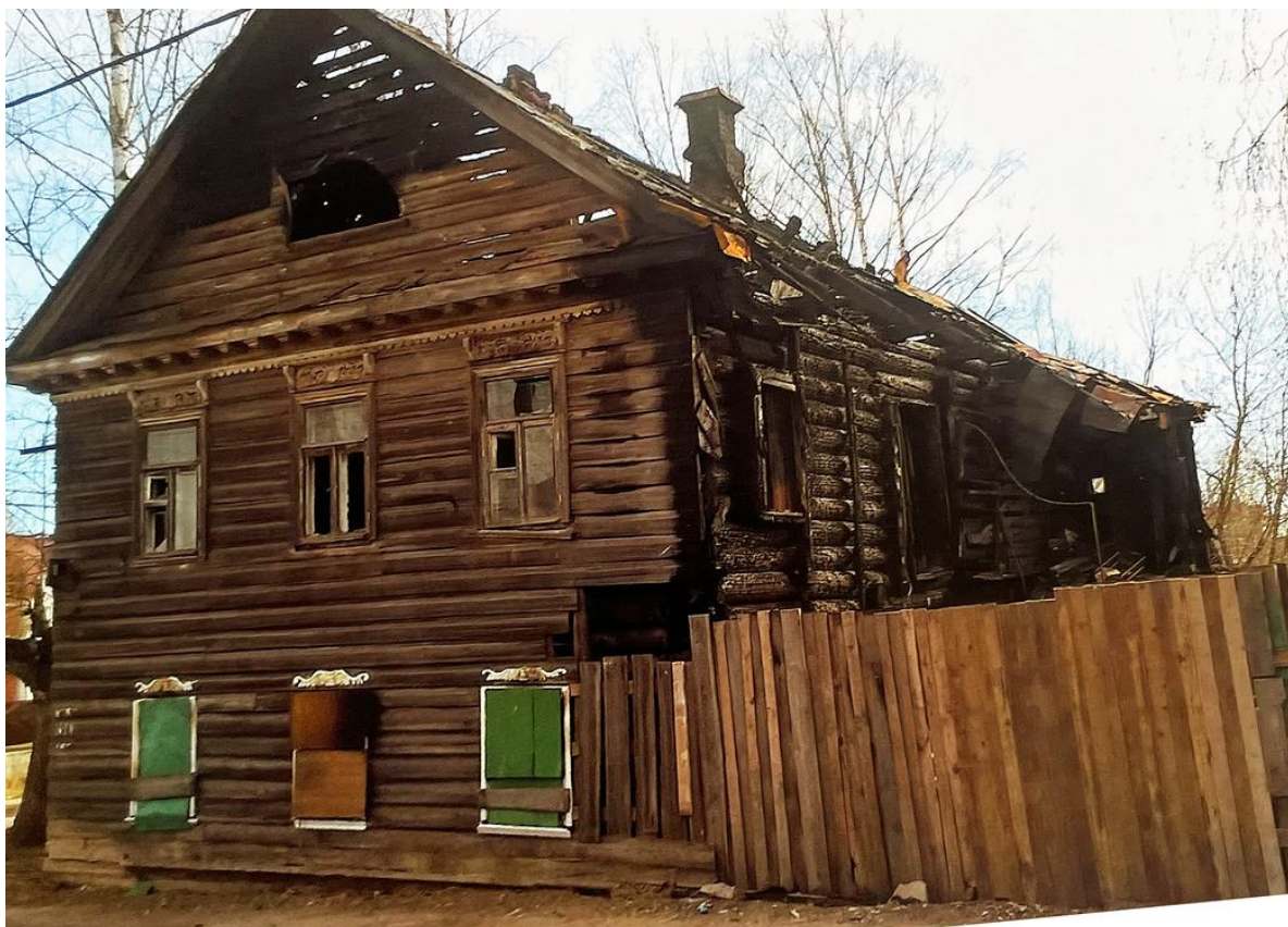
Илл. 14. Дом по Новгородской ул., 40 после пожара 20.04.2018. Вид с запада.
