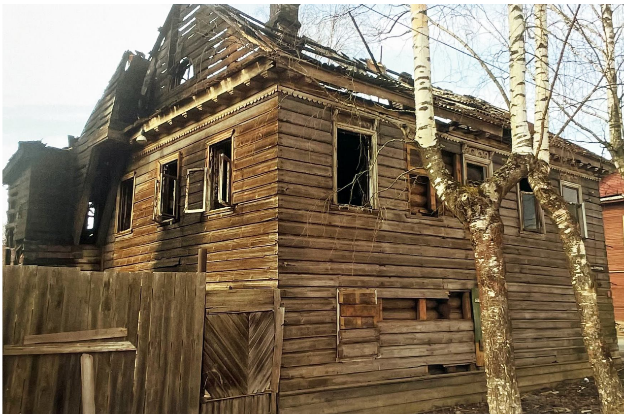
Илл. 15. Дом по Новгородской ул., 40 после пожара 20.04.2018. Вид с востока.
