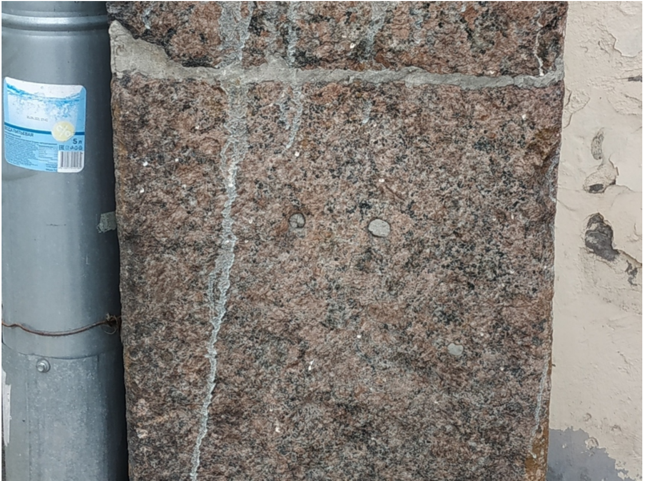
4. Следы крепления ограждения приямка в гранитной отделке цоколя (южнее проёма).
