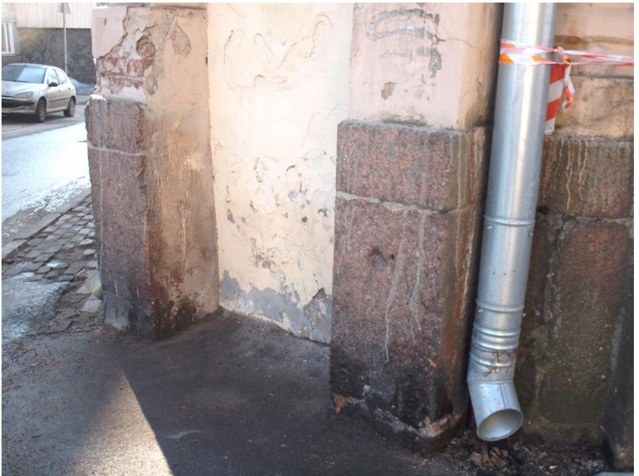
21. Неудовлетворительное состояние штукатурного слоя и поверхности гранитных блоков
