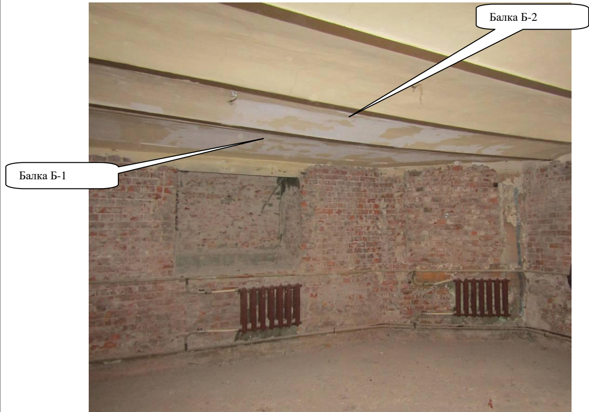
Фото № 5.2-1. Помещение в осях 1-2/Г-Е. Виден прогиб балки Б-1 и Б-2
