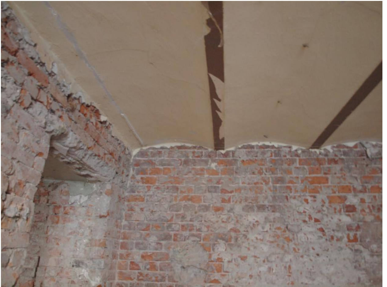
25. Пом. 1. Локальные утраты шовного заполнения кирпичной кладки стен
