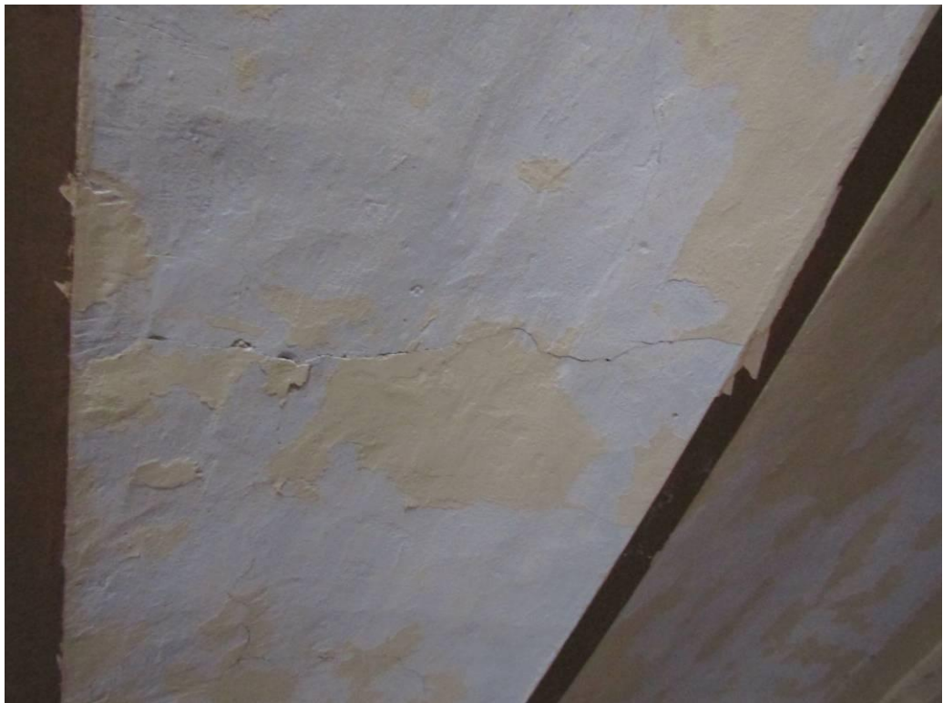
Фото № 5.2-2. . Трещина в бетонном своде, расположенном между балками Б-1 и Б-2
