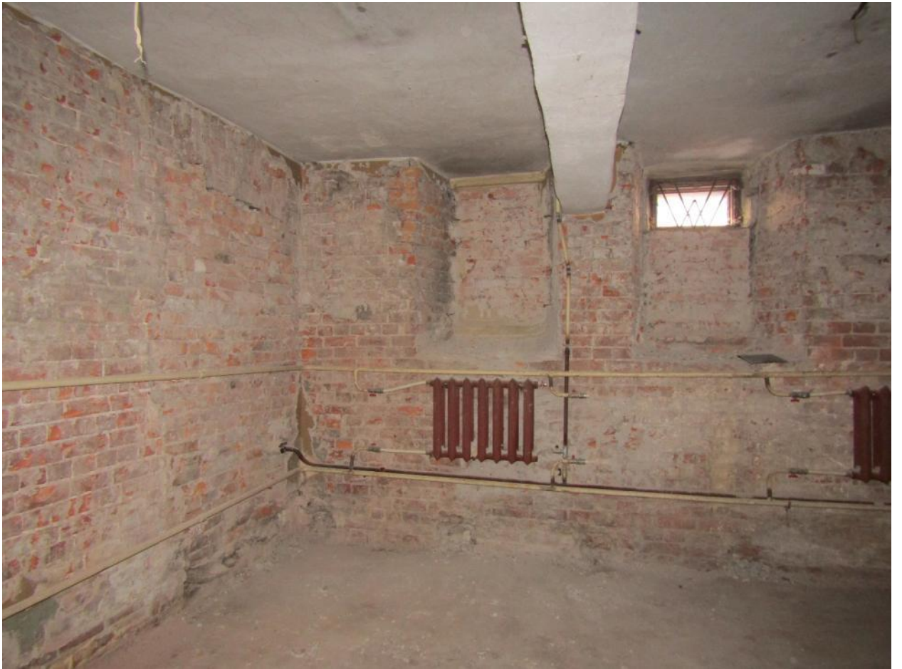
31. Пом. 2. Заложённый дверной проём в стене по оси «А», заложённые оконные проёмы в стене по оси «1».
