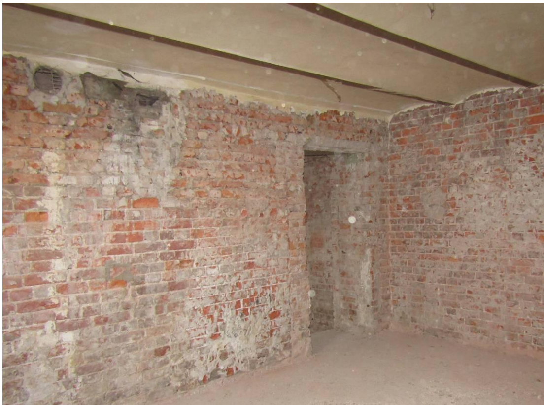
Фото № 5.3-3. Стена по оси «2». Слева видны следы вентиляционных и дымовых каналов.
