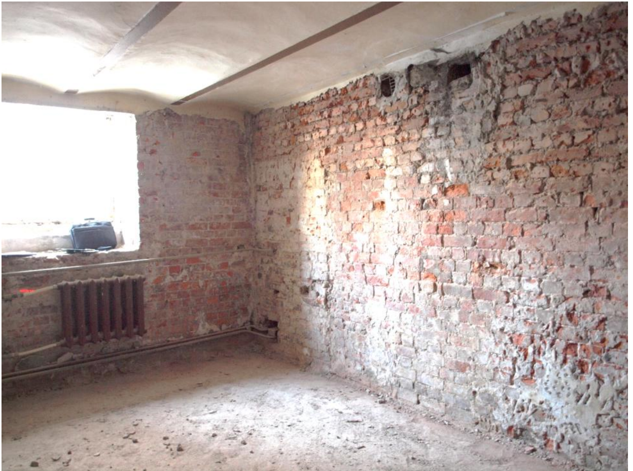
24. Пом. 1. Стена по оси «2». Неудовлетворительное состояние кирпичной кладки стен – утрата штукатурного слоя, сквозные отверстия в кладке, заложённые проёмы.
