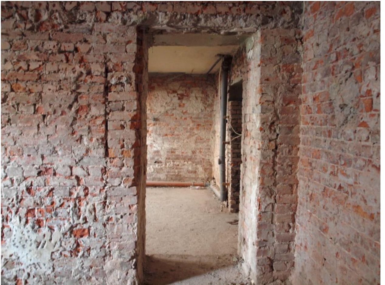
26. Пом. 1. Вид на пом. 3. Дверной проём между помещениями. Следы перекладок кирпичной кладки.
