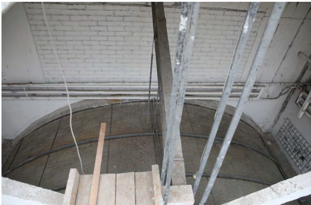
12. Объект культурного наследия регионального значения «Жилой и торговый дом «Карьяла» по адресу: Ленинградская область, Выборгский район, город Выборг, проспект Ленина, д.12/10. Вид на витраж сверху (с ходовых мостков в пространстве между витражом и световым фонарем).
