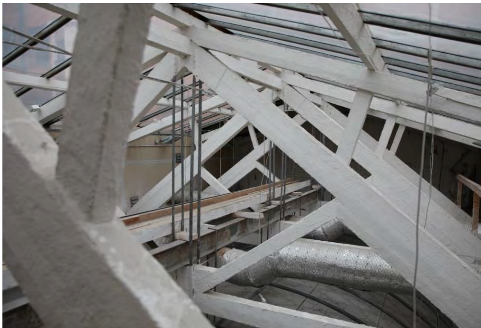
14. Объект культурного наследия регионального значения «Жилой и торговый дом «Карьяла» по адресу: Ленинградская область, Выборгский район, город Выборг, проспект Ленина, д.12/10. Конструкции кровли и светового фонаря над витражом.
