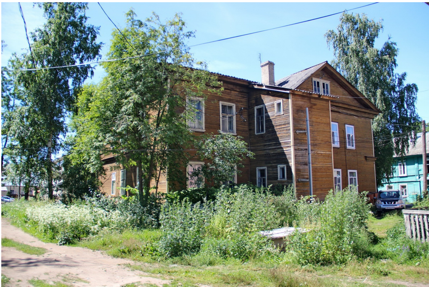
6 ОКН регионального значения “Жилой дом - бывший дом Йорса, 1898 г.” Ленинградская область, Волховский район, г. Новая Ладога, ул. Горького, д. 7/9. Юго-восточный и северо-восточный фасады. Дата съемки: 30.06.2022 г.
