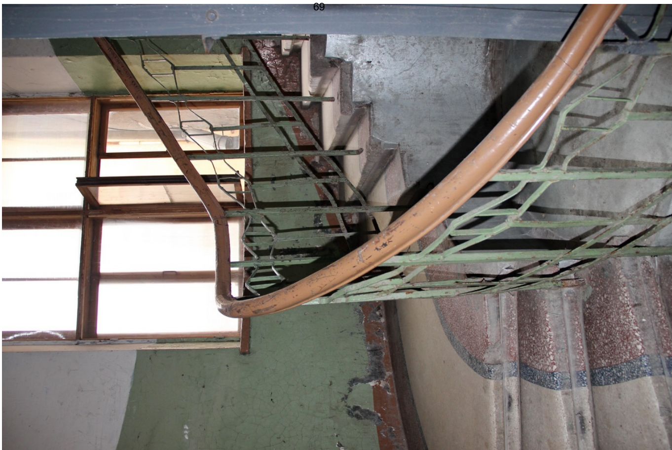
27 ОКН регионального значения “Жилой дом с магазинами Массинена” Ленинградская область, Выборгский муниципальный район, г. Выборг, Ленинградское ш., д. 15. Подъезд № 3. Лестничная клетка. Междуэтажная площадка между 1 и 2 этажами. Дата съемки: 01.09.2021 г.
