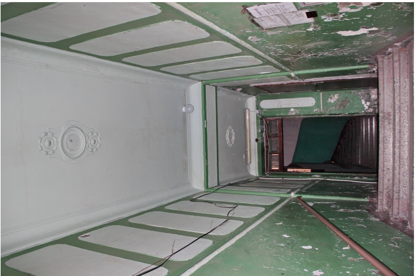
32 ОКН регионального значения “Жилой дом с магазинами Массинена” Ленинградская область, Выборгский муниципальный район, г. Выборг, Ленинградское ш., д. 15. Подъезд № 4. Входной тамбур. 1 этаж. Дата съемки: 01.09.2021 г.
