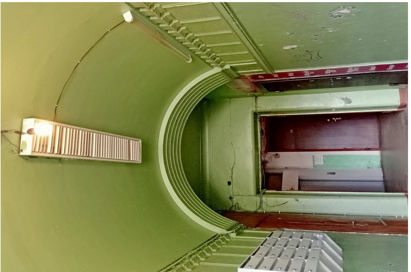
20 ОКН регионального значения “Жилой дом с магазинами Массинена” Ленинградская область, Выборгский муниципальный район, г. Выборг, Ленинградское ш., д. 15. Подъезд № 2. Входной тамбур. 1 этаж. Дата съемки: 01.09.2021 г.
