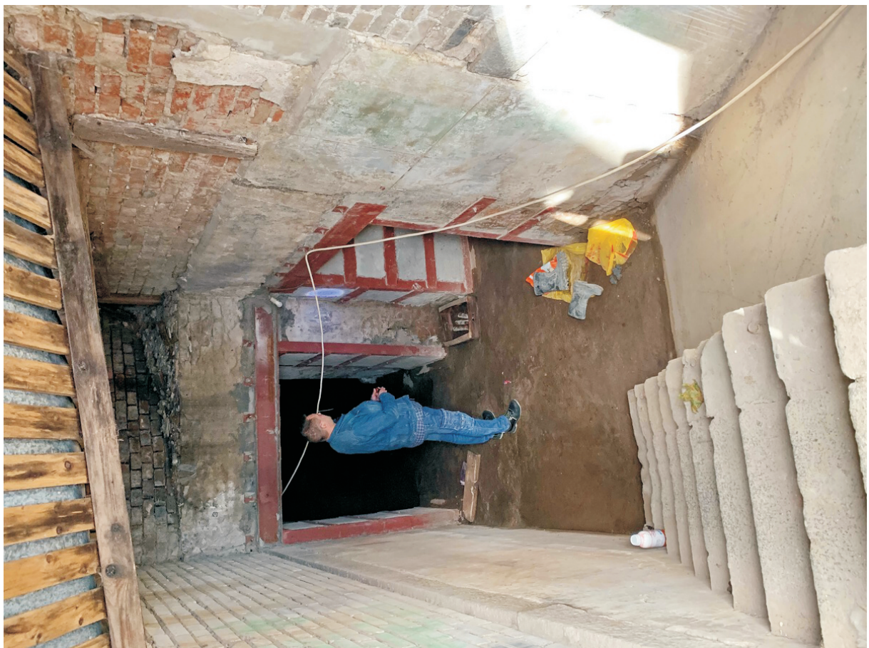
10 ОКН регионального значения “Жилой дом” Ленинградская область, Выборгский муниципальный район, г. Выборг, ул. Железнодорожная, д. 4. Вход в подвал. Дата съемки: 01.09.2021 г.
