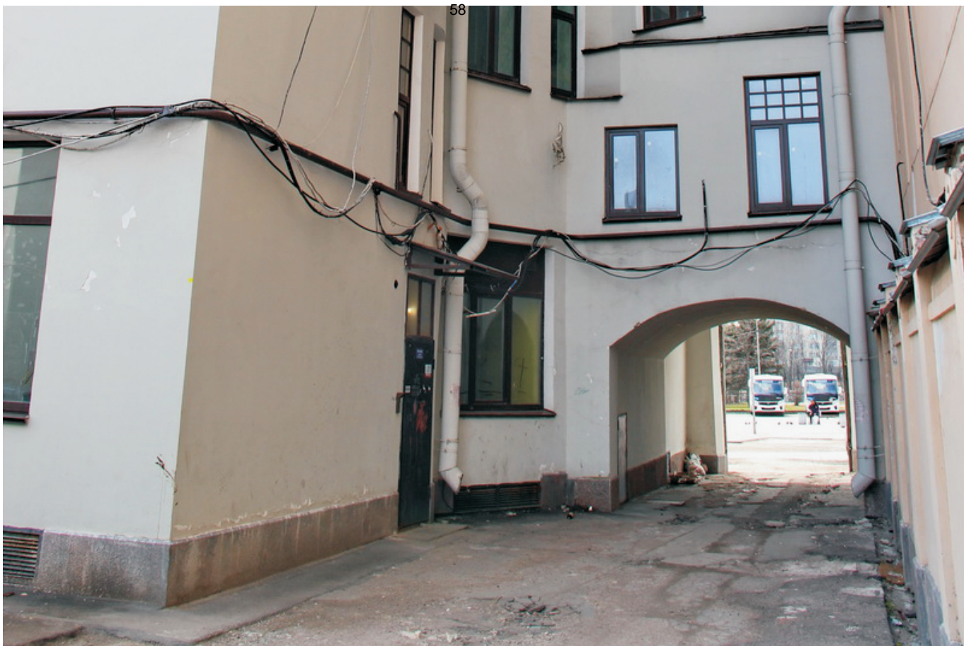
5 ОКН регионального значения “Жилой дом” Ленинградская область, Выборгский муниципальный район, г. Выборг, ул. Железнодорожная, д. 4. Северо-восточный фасад. Фрагмент. Дата съемки: 01.09.2021 г.
