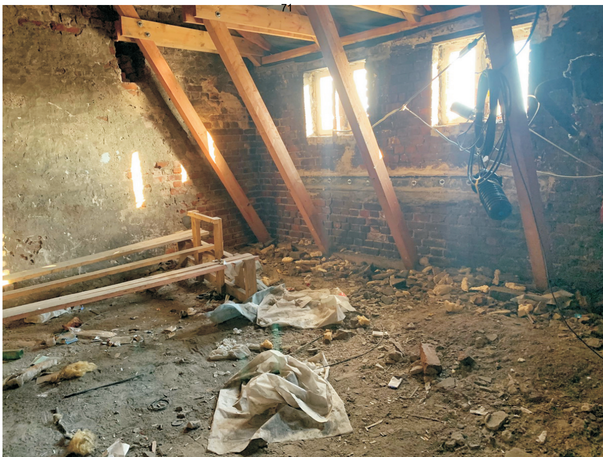
31 ОКН регионального значения “Жилой дом” Ленинградская область, Выборгский муниципальный район, г. Выборг, ул. Железнодорожная, д. 4. Чердак. Дата съемки: 01.09.2021 г.
