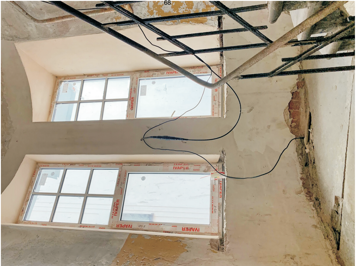
25 ОКН регионального значения “Жилой дом” Ленинградская область, Выборгский муниципальный район, г. Выборг, ул. Железнодорожная, д. 4. Подъезд № 3. Лестничная клетка. Площадка между 1 и 2 этажами. Дата съемки: 01.09.2021 г.
