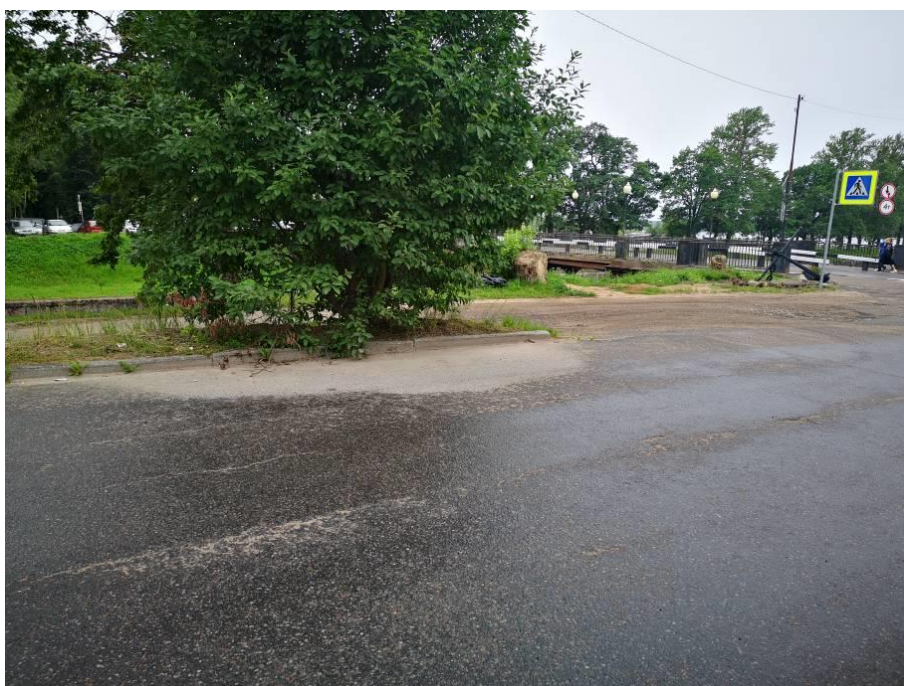
Фото 8. Территория производства работ. Участок капитального ремонта сетей водоснабжения вдоль улицы Староладожский Канал.
