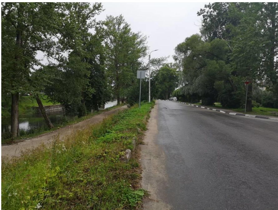
Фото 7. Территория производства работ. Участок капитального ремонта сетей водоснабжения вдоль улицы Староладожский Канал.
