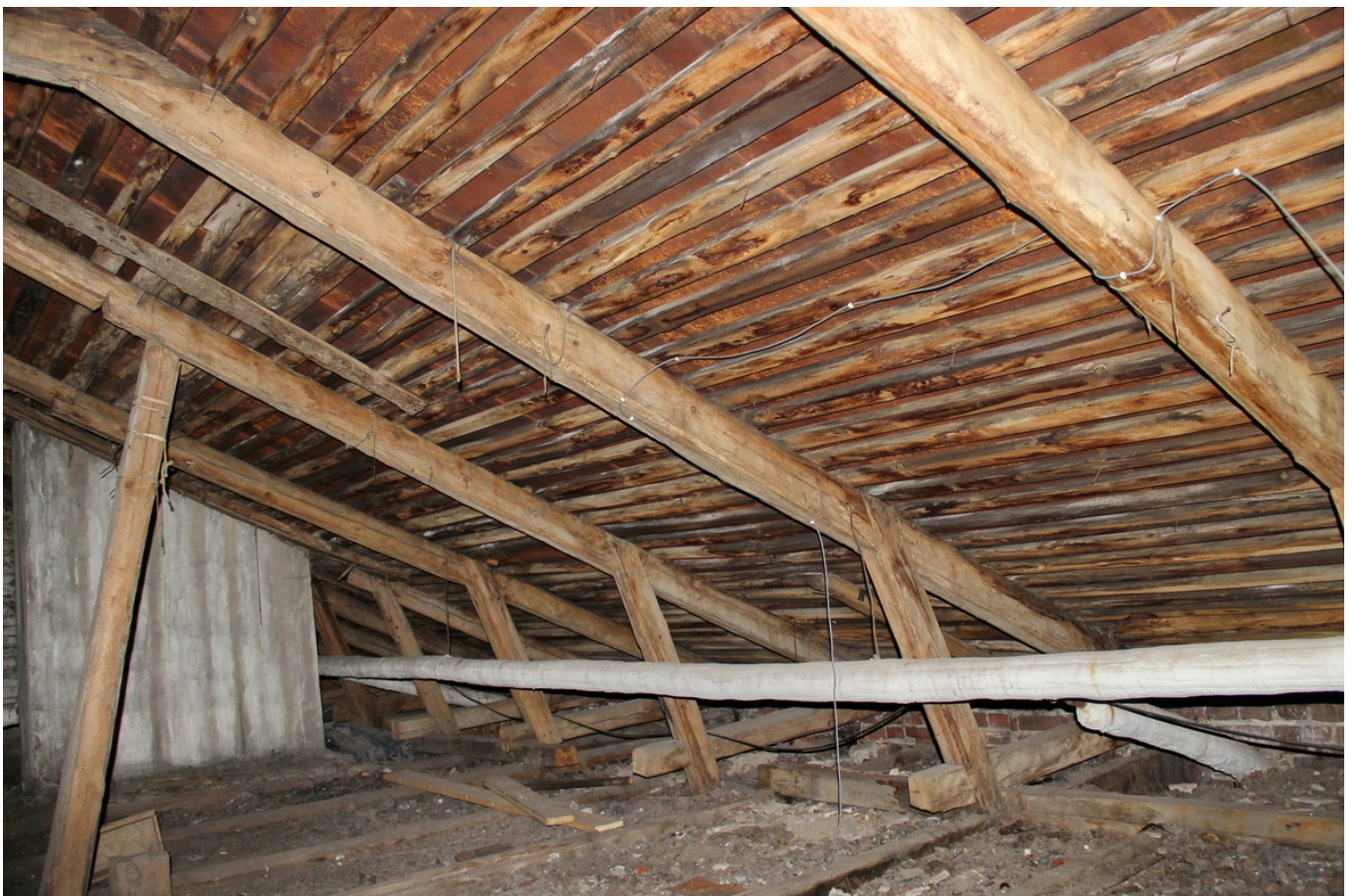
6 ОКН регионального значения “Жилой дом” ул. Выборгская, д. 1А. Чердак. Дата съемки: 13.10.2021 г.
