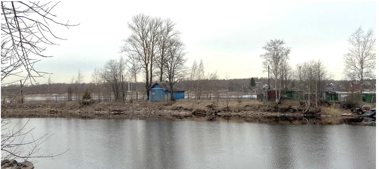
Фото 3.1. Вид на историческую дамбу, устроенную вдоль Ладожского озера, берега оплыли, частично видно берегоукрепление в виде каменной наброски, на дамбе расположились поздние строения.
