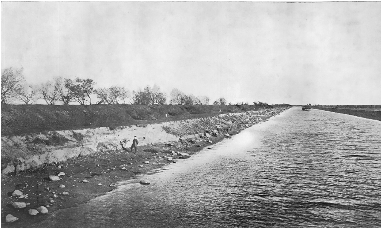
Илл. 50. Разрушение берегов [Новолодожского] канала пароходной волной. (Разрушение не только откоса, но и всей нижней бермы озерной дамбы.) 1908-1911 гг.
