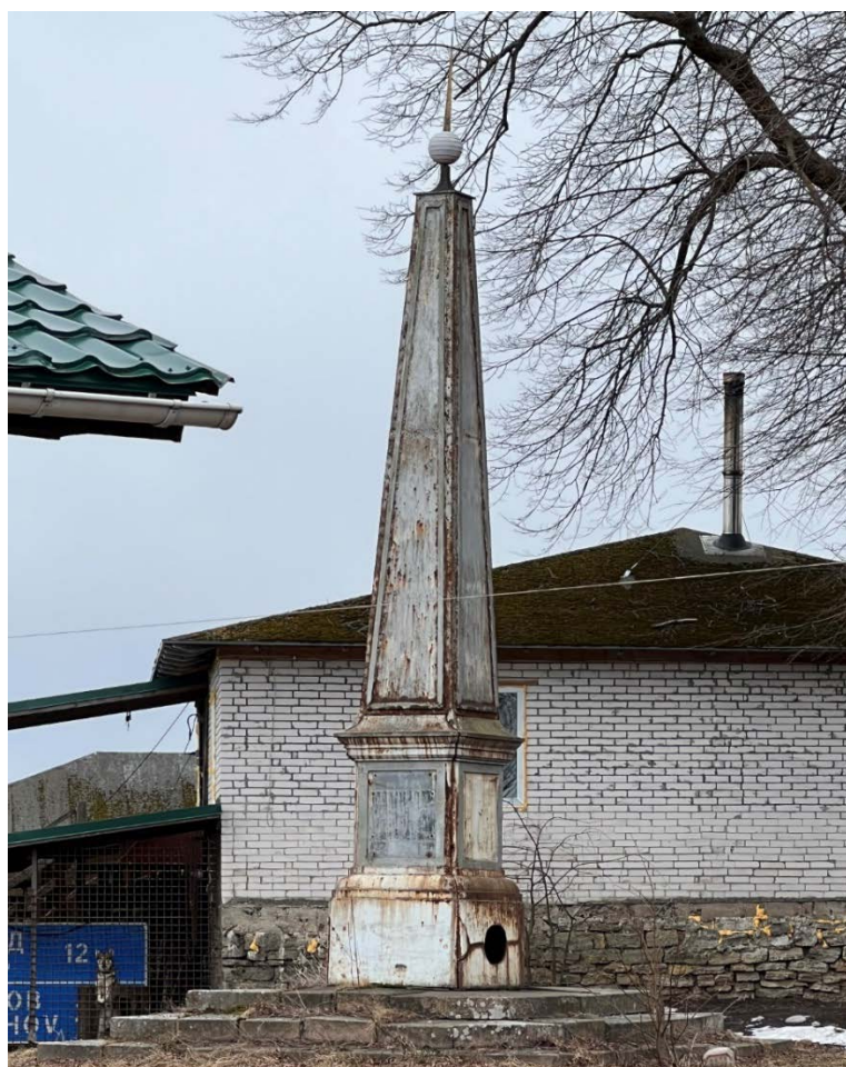
Фото 12. Вид на исторический памятный обелиск (знак), установленный в честь устройства Новолодожского канала в его истоке (памятный обелиск в устье канала не сохранился).
