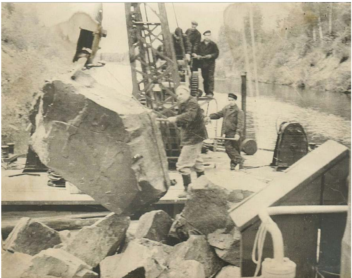
Илл. 60. Новолодожский канал («Работа крана №2 на Белом Камне»). 1960 г. Работы по ремонту откосов канала
