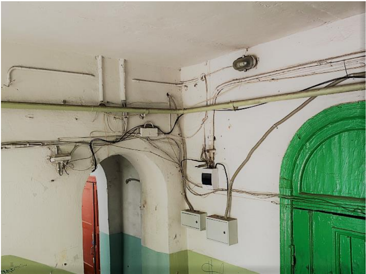
Фото 7. 1-ый этаж лестничной клетки ЛК-1. Расположение электропроводки по стенам с нарушением способа прокладки. Дата съемки: 11.04.2022 г. Автор: Прокофьев М.Ф.
