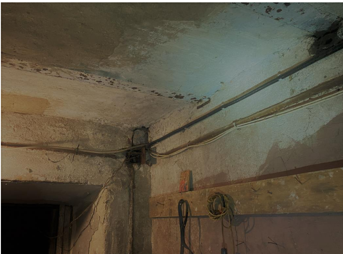
Фото 6. Подвал. Расположение линий сети освещения по стенам с нарушением способа прокладки. Дата съемки: 11.04.2022 г. Автор: Прокофьев М.Ф.
