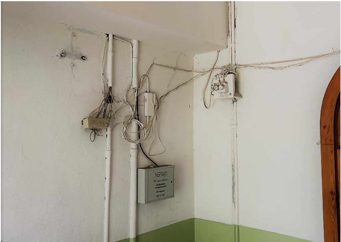
Фото 9. 2-ой этаж лестничной клетки ЛК-1. Расположение электропроводки по стенам с нарушением способа прокладки. Дата съемки: 11.04.2022 г. Автор: Прокофьев М.Ф.
