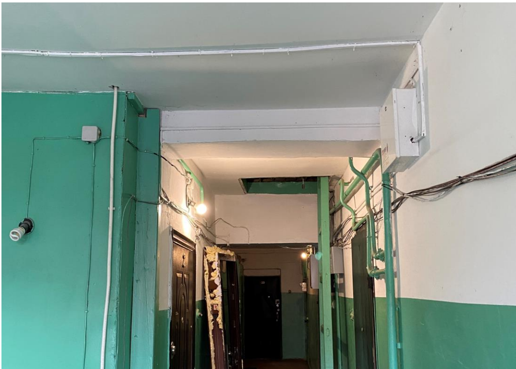
Фото 9. 4-ый этаж лестничной клетки ЛК-2. Расположение электропроводки по стенам и перекрытию с нарушением способа прокладки. Дата съемки: 11.04.2022 г. Автор: Куваева Ю.П.
