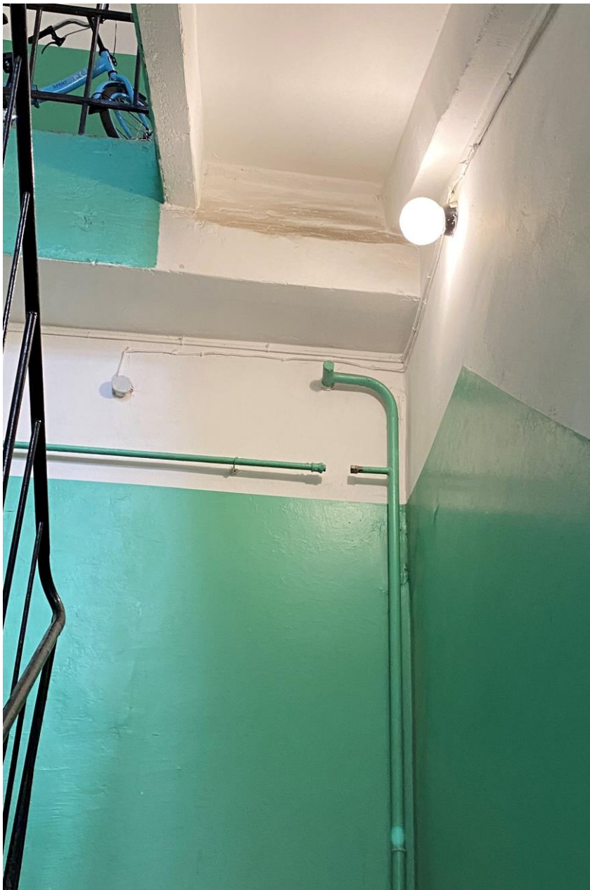
Фото 6. 2-ой этаж лестничной клетки ЛК-2. Расположение электропроводки по стенам с нарушением способа прокладки. Дата съемки: 11.04.2022 г. Автор: Куваева Ю.П.
