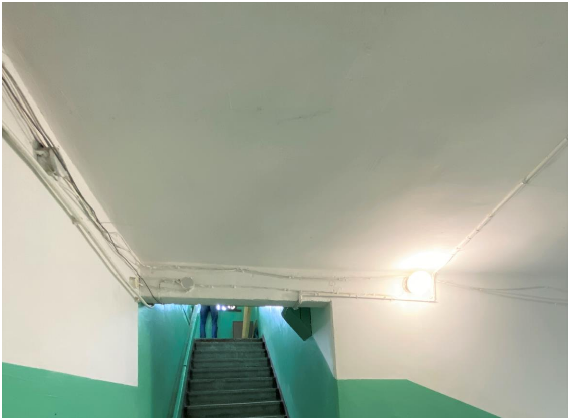
Фото 8. 3-ий этаж лестничной клетки ЛК-2. Расположение электропроводки по стенам и перекрытию с нарушением способа прокладки. Дата съемки: 11.04.2022 г. Автор: Куваева Ю.П.
