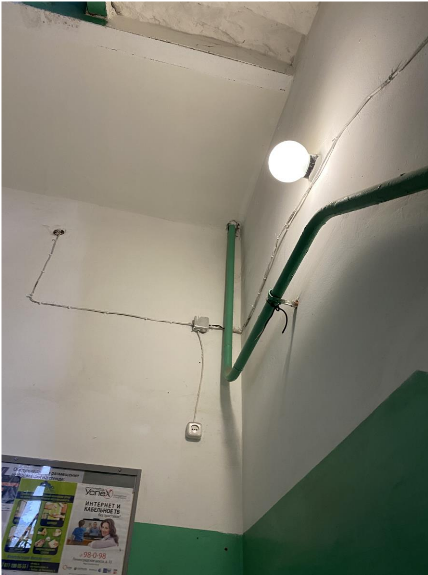
Фото 5. 1-ый этаж лестничной клетки ЛК-2. Расположение электропроводки по стенам с нарушением способа прокладки. Дата съемки: 11.04.2022 г. Автор: Куваева Ю.П.
