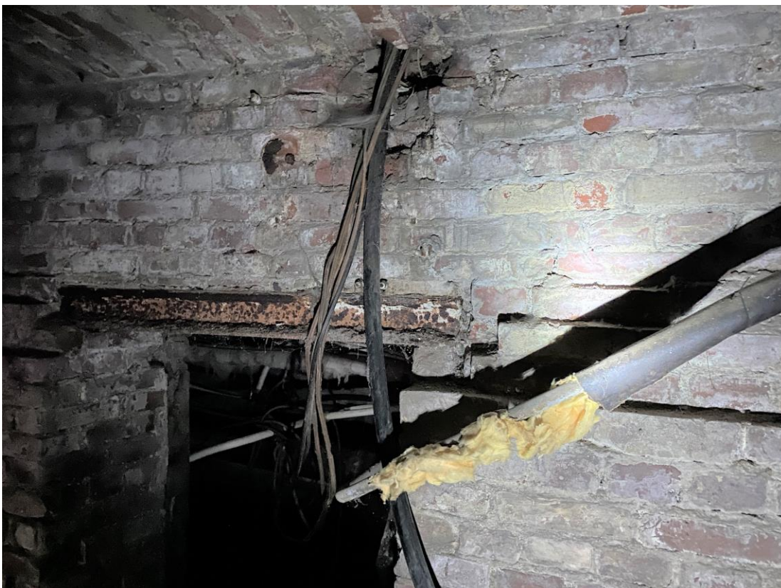
Фото 4. Подвал. Расположение электропроводки в кабелях сквозь перекрытия и по стене с нарушением способа прокладки. Дата съемки: 11.04.2022 г. Автор: Куваева Ю.П.
