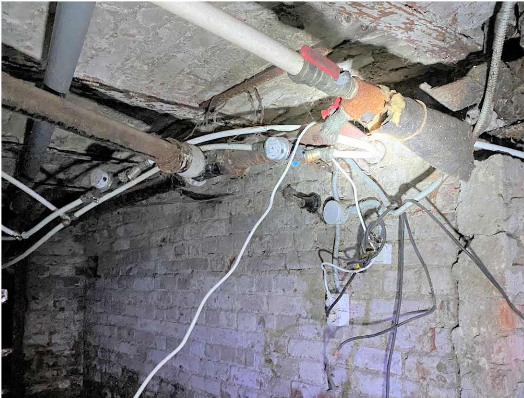
Фото 3. Подвал. Расположение электропроводки (открытая и в гофра) по стенам с нарушением способа прокладки. Освещение помещения лампой накаливания без защитного плафона. Дата съемки: 11.04.2022 г. Автор: Куваева Ю.П.
