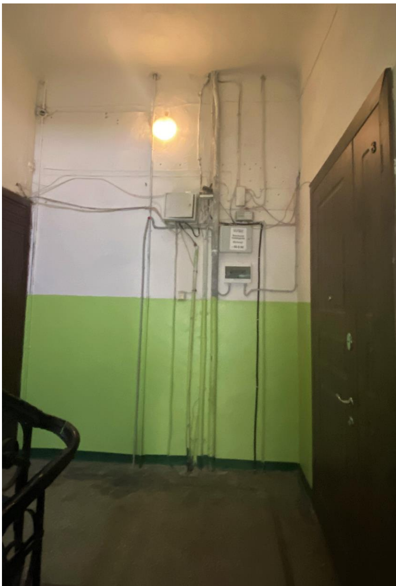
Фото 5. 2-ой этаж лестничной клетки (вход в ул. Ленинградского шоссе). Расположение прокладки электропроводов (частично в гофрированных трубах). Фото 11.04.2022 г. Автор: Куваева Ю.П.
