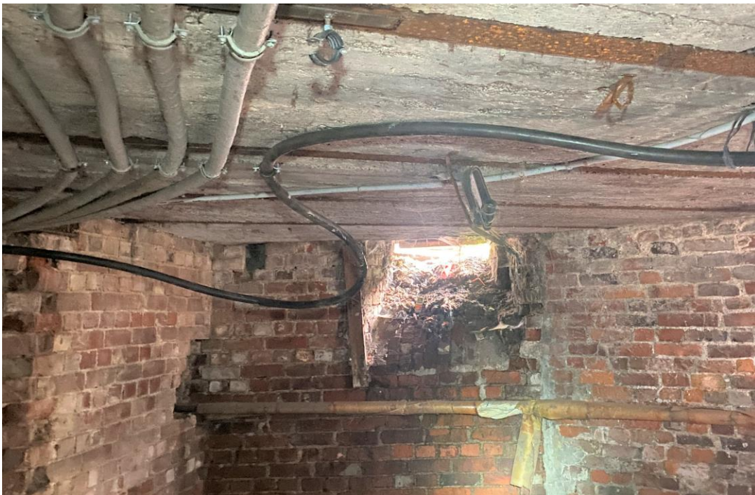
Фото 4. Подвал. Расположение кабеля питания от щитов по перекрытию. Фото 11.04.2022 г. Автор: Куваева Ю.П.
