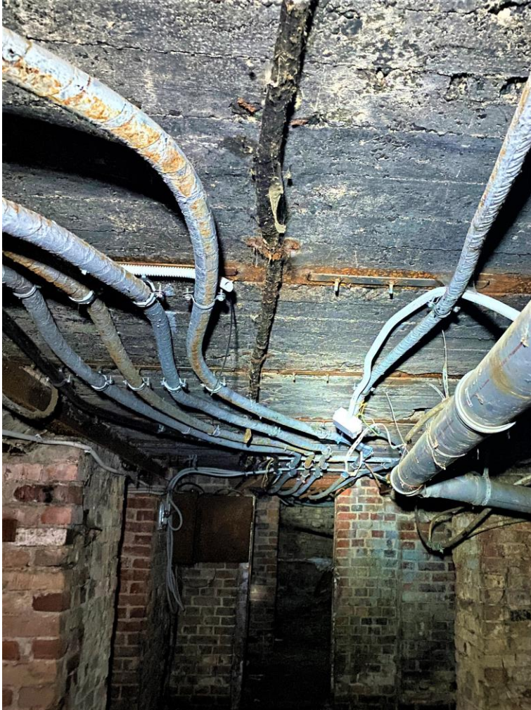
Фото 3. Подвал. Расположение кабеля питания от щитов по перекрытию. Фото 11.04.2022 г. Автор: Куваева Ю.П.
