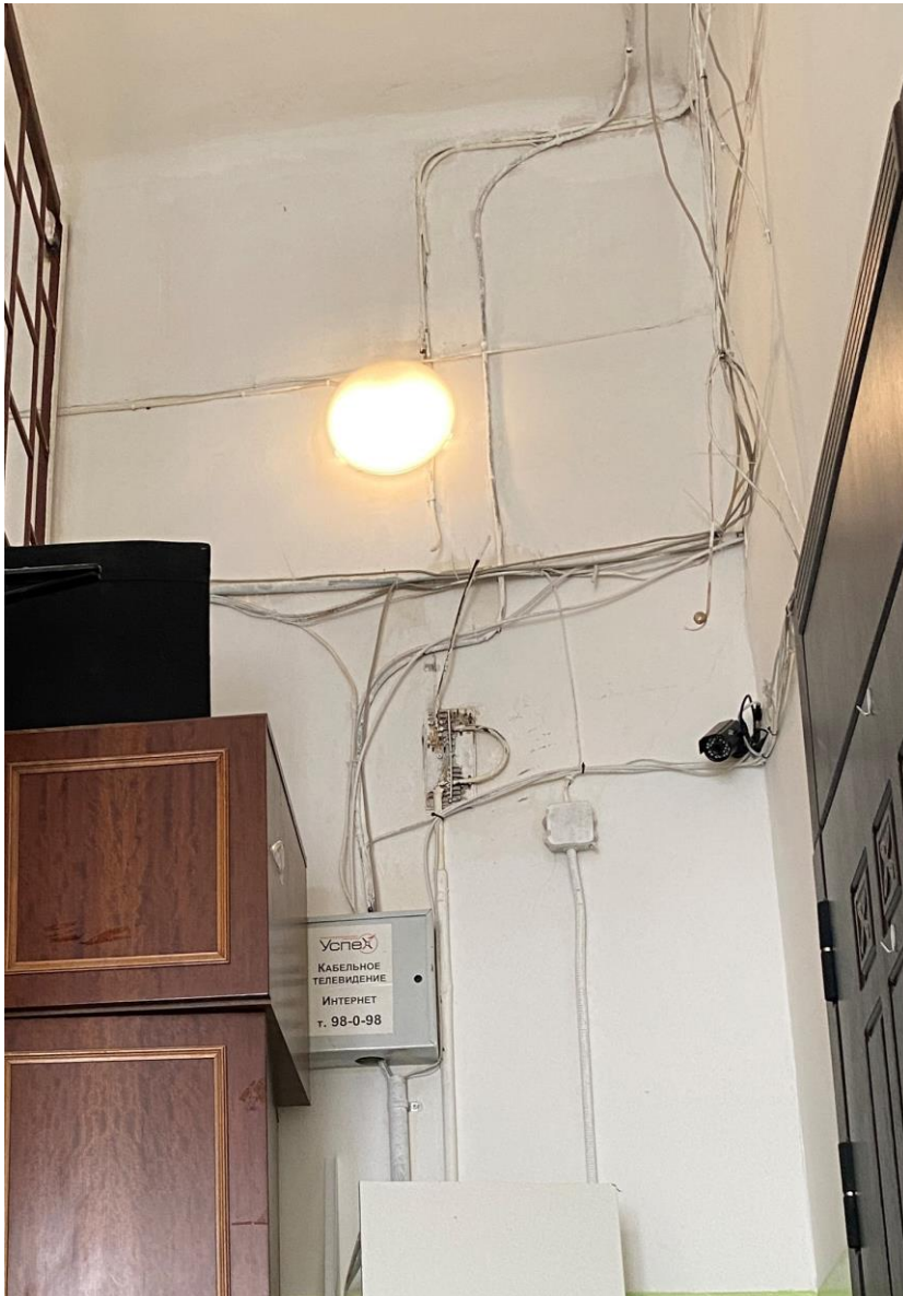
Фото 6. 4-ый этаж лестничной клетки (вход в ул. Ленинградского шоссе). Расположение прокладки электропроводов (частично в гофрированных трубах). Фото 11.04.2022 г. Автор: Куваева Ю.П.
