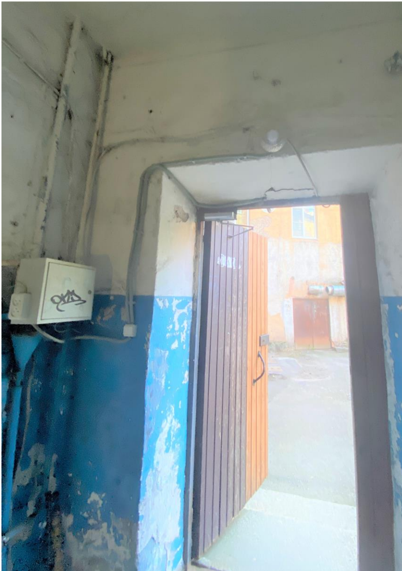
Фото 7. 1-ый этаж лестничной клетки (вход со стороны двора в уличный объем). Расположение электропроводки в гофре по стенам. Фото 11.04.2022 г. Автор: Куваева Ю.П.
