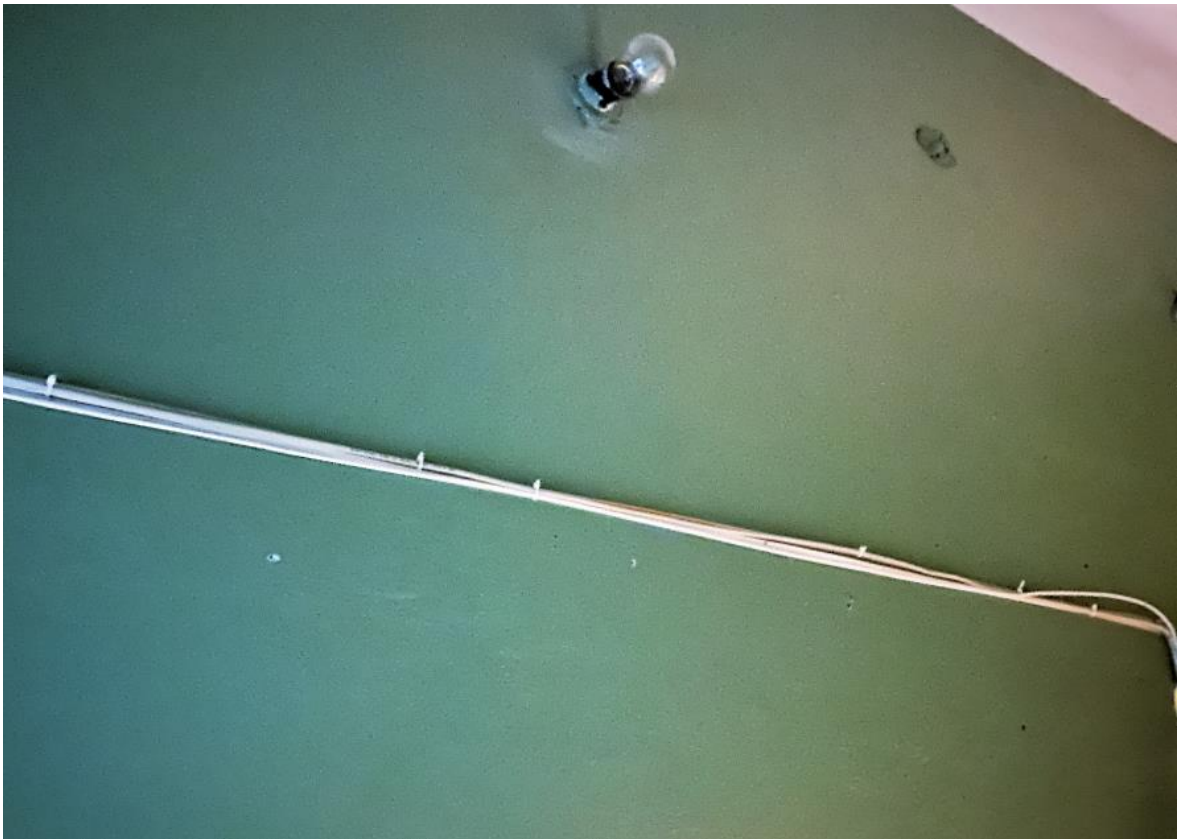
Фото 15. Коридор 2-го этажа. Отсутствует плафон светильника. Дата съемки: 11.04.2022 г. Автор: Прокофьев М.Ф.
