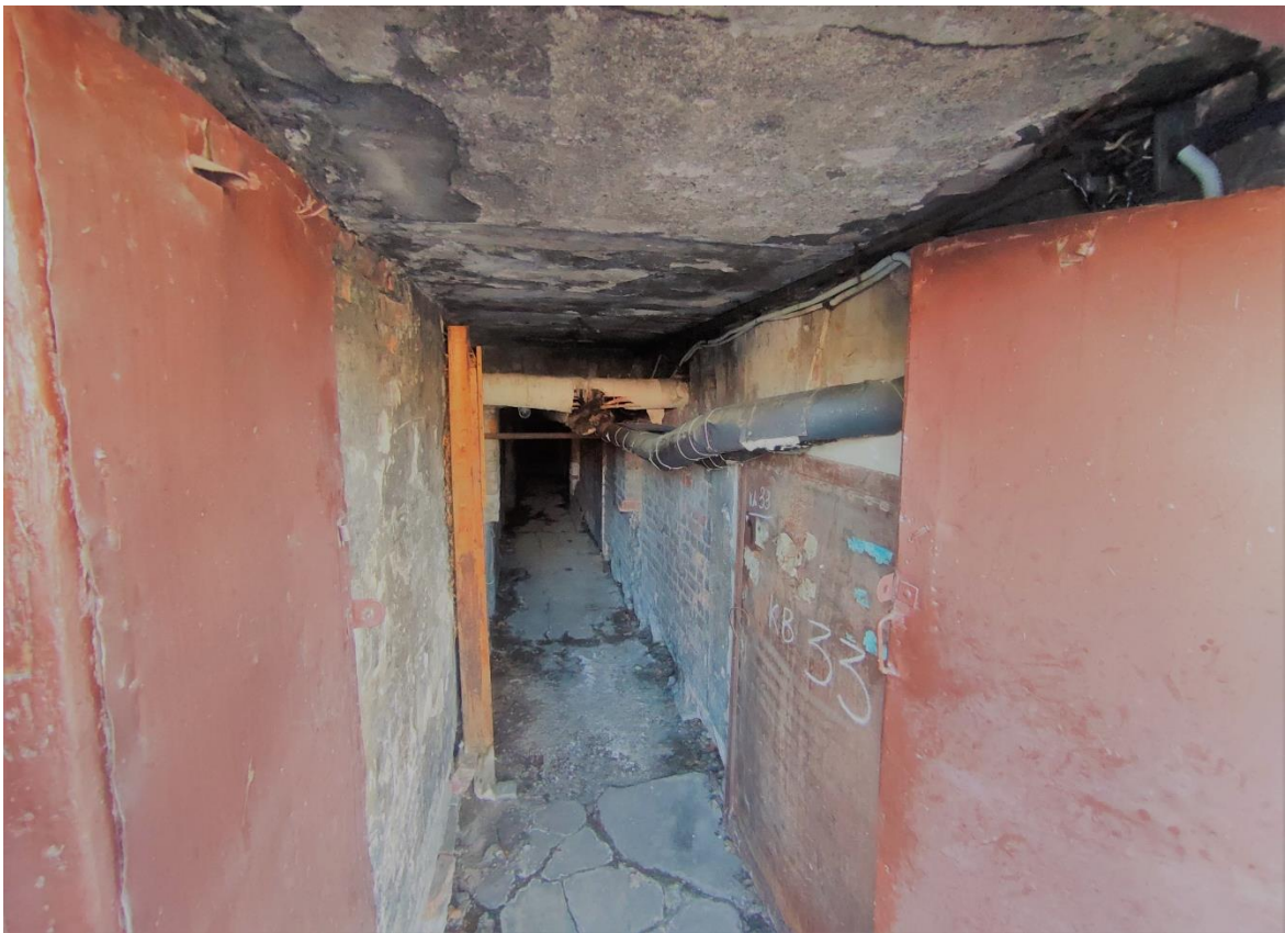
Фото 10. Вход в подвальные помещения. Вскрыта распределительная коробка.
