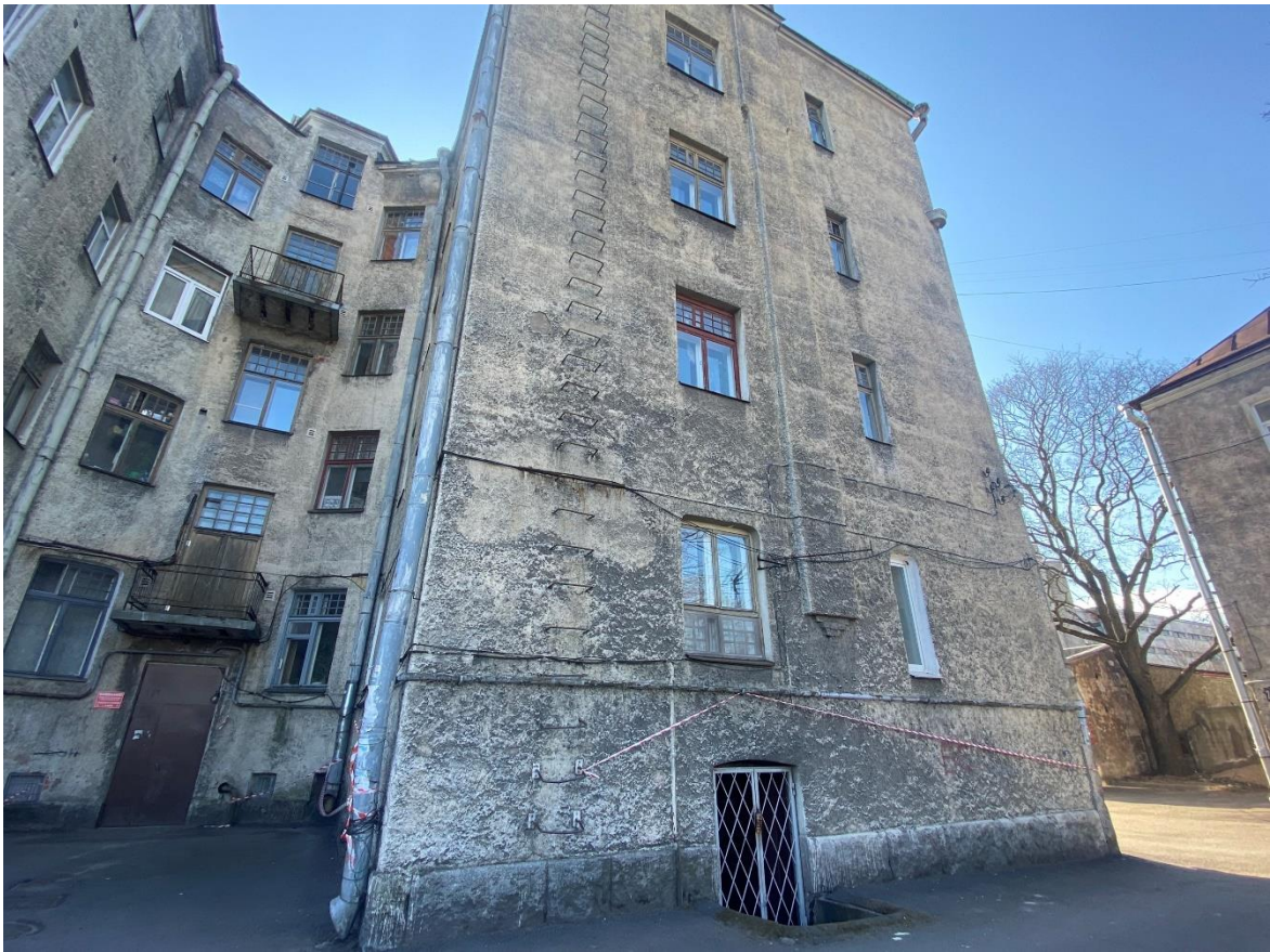
Фото 5. Фрагмент дворового фасада здания. Вид с северо-востока. Дата съемки: 11.04.2022 г. Автор: Прокофьев М.Ф.
