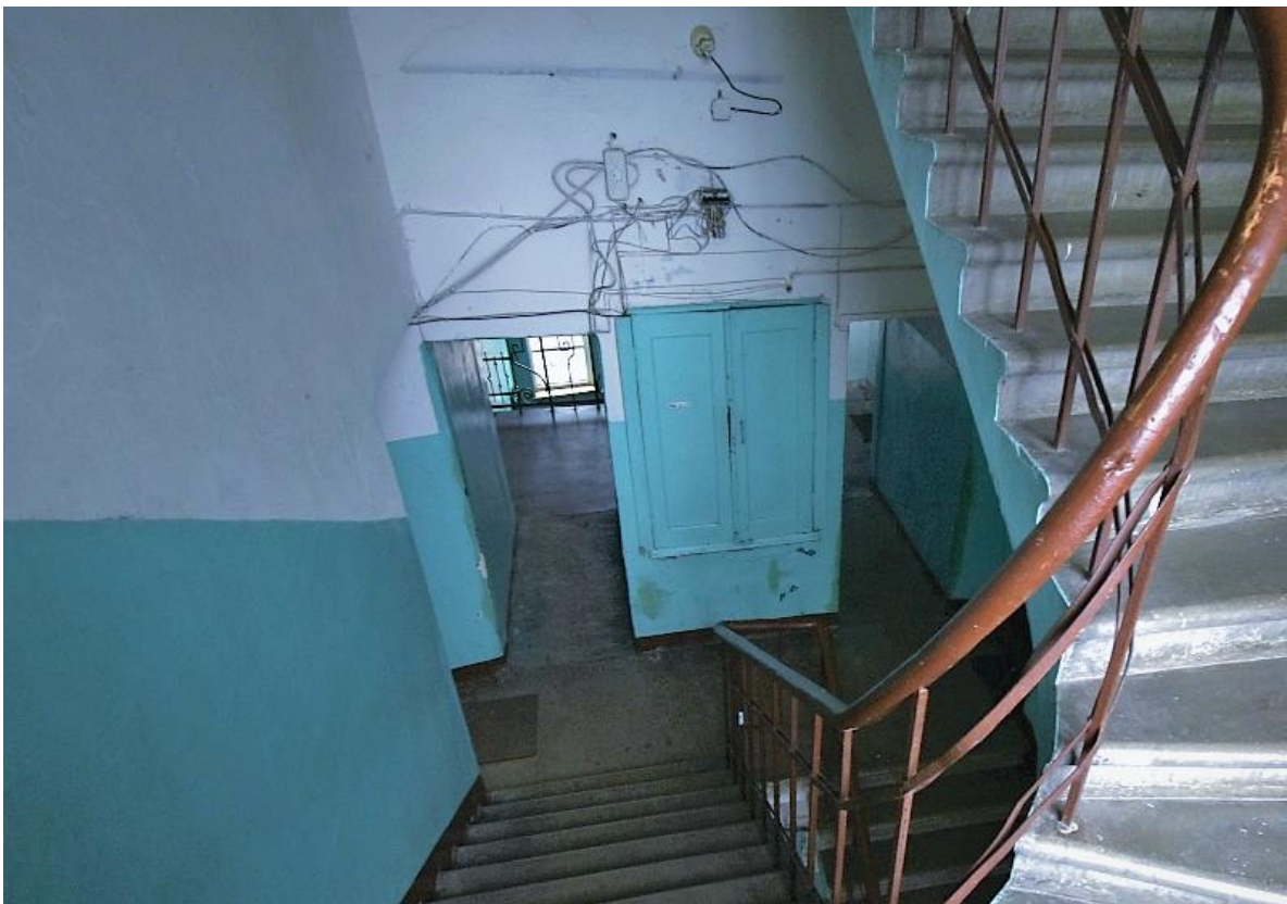
Фото 14. 2-ой этаж служебной лестницы. Расположение электропроводки по стенам с нарушением способа прокладки. Дата съемки: 11.04.2022 г. Автор: Прокофьев М.Ф.
