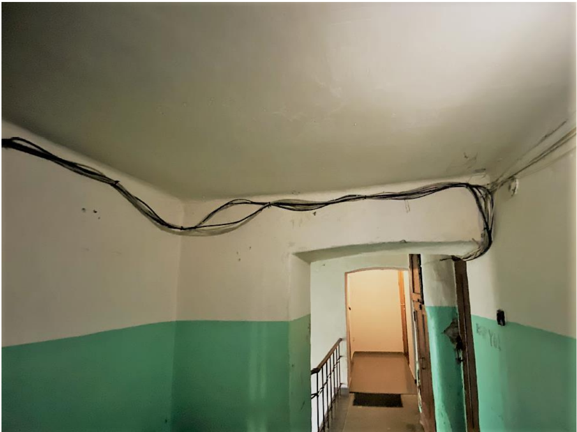
Фото 19. Коридор 5-го этажа. Расположение электропроводки по стенам с нарушением способа прокладки. Дата съемки: 11.04.2022 г. Автор: Прокофьев М.Ф.
