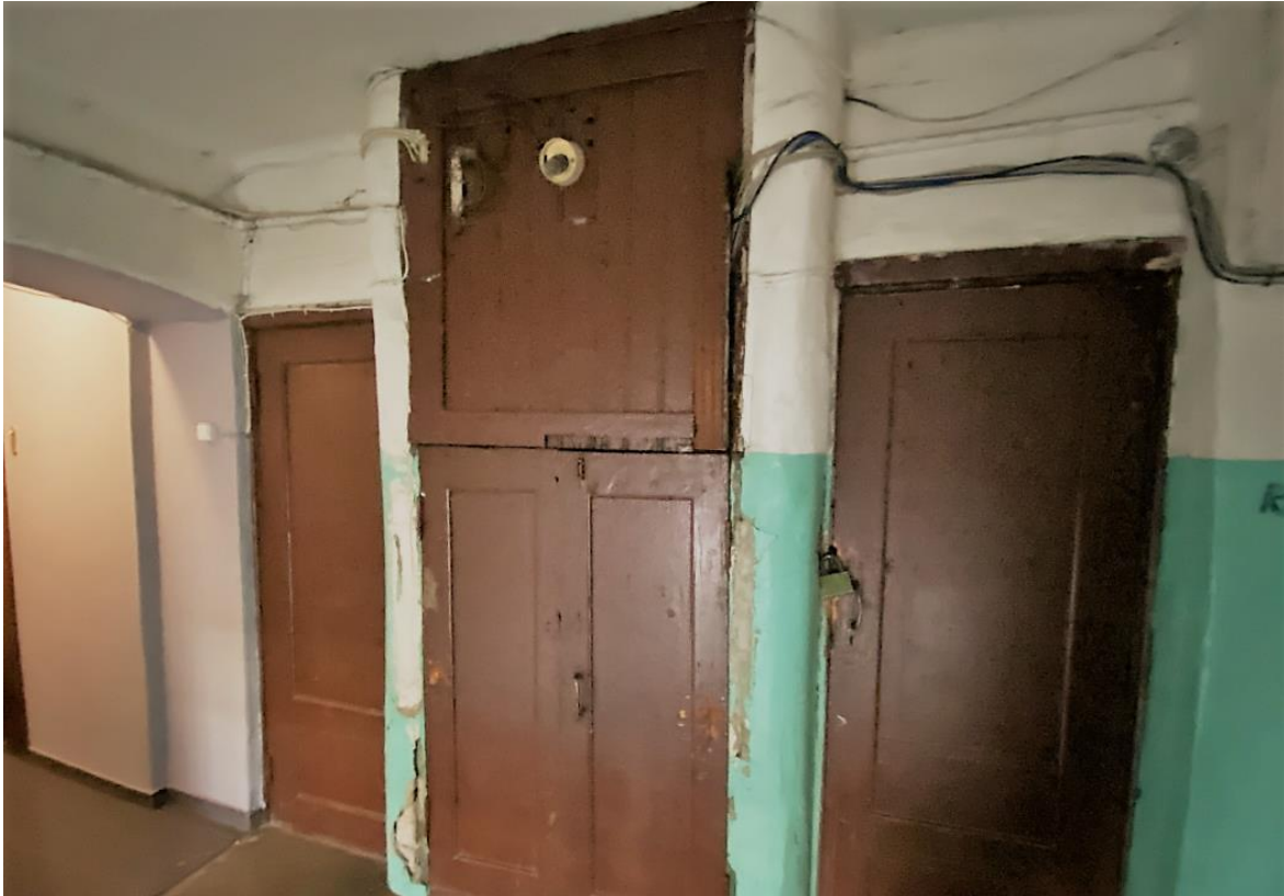
Фото 18. Общий вид верхней площадки служебной лестницы в уровне 5-го этажа. Расположение электропроводки по стенам с нарушением способа прокладки. Отсутствует плафон светильника. Дата съемки: 11.04.2022 г. Автор: Прокофьев М.Ф.
