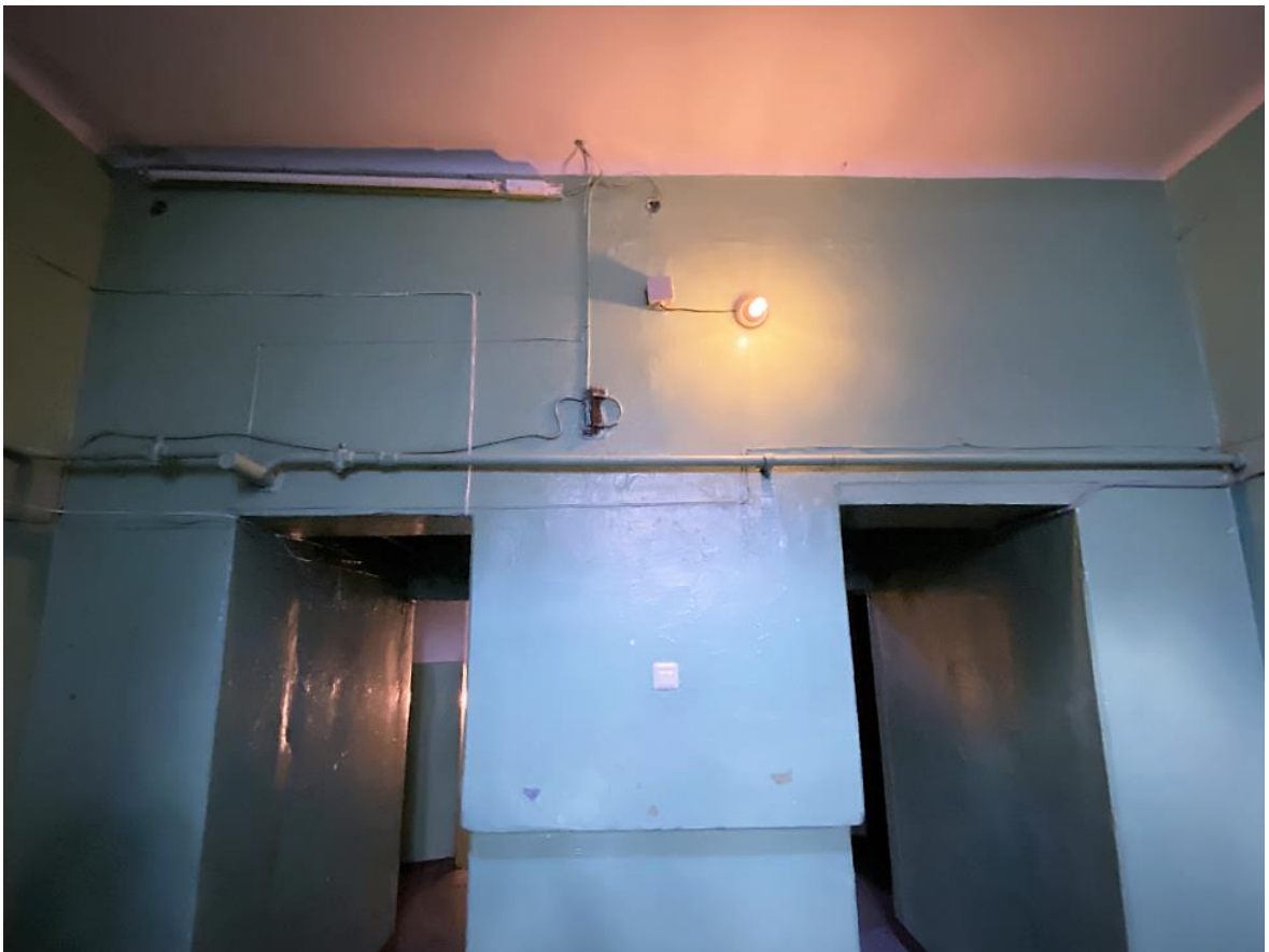
Фото 12. 1-ый этаж парадной лестницы. Отсутствуют плафон светильника и аварийное освещение. Дата съемки: 11.04.2022 г. Автор: Прокофьев М.Ф.
