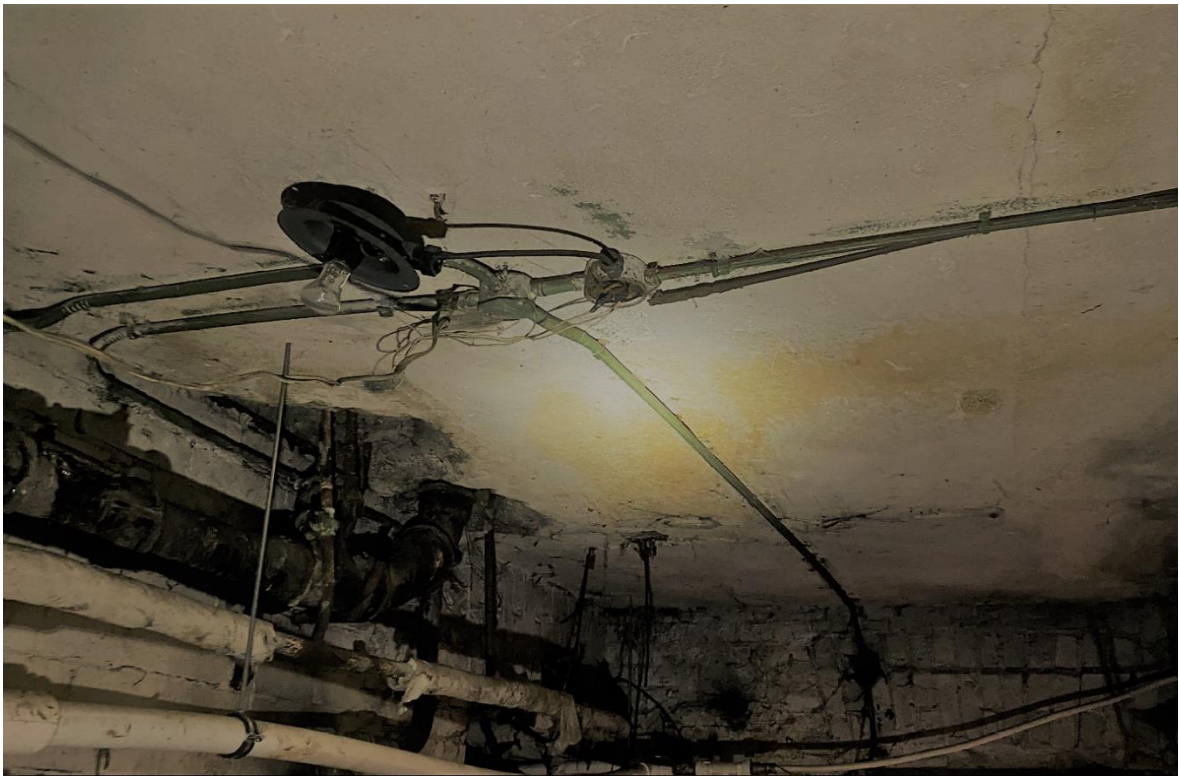
Фото 11. Подвал. Металлические трубы поражены коррозией. Вскрыта распределительная коробка, отсутствует плафон светильника. Дата съемки: 11.04.2022 г. Автор: Прокофьев М.Ф.
