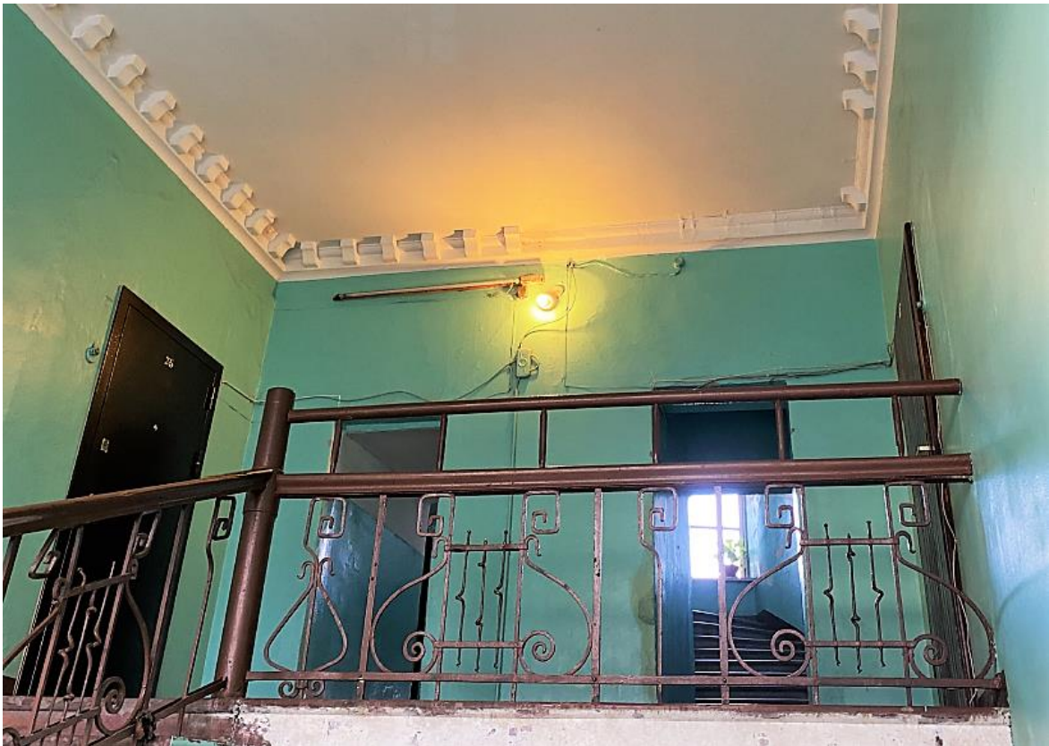
Фото 17. Общий вид верхней площадки парадной лестницы в уровне 4-го этажа. Расположение электропроводки по стенам с нарушением способа прокладки. Отсутствует плафон светильника. Дата съемки: 11.04.2022 г. Автор: Прокофьев М.Ф.
