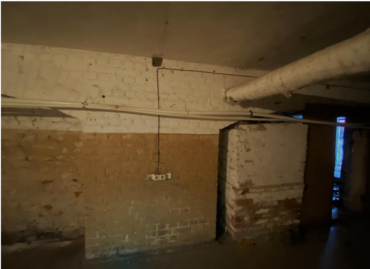
Фото 9. Подвал. Расположение электропроводки по стенам с нарушением способа прокладки.
