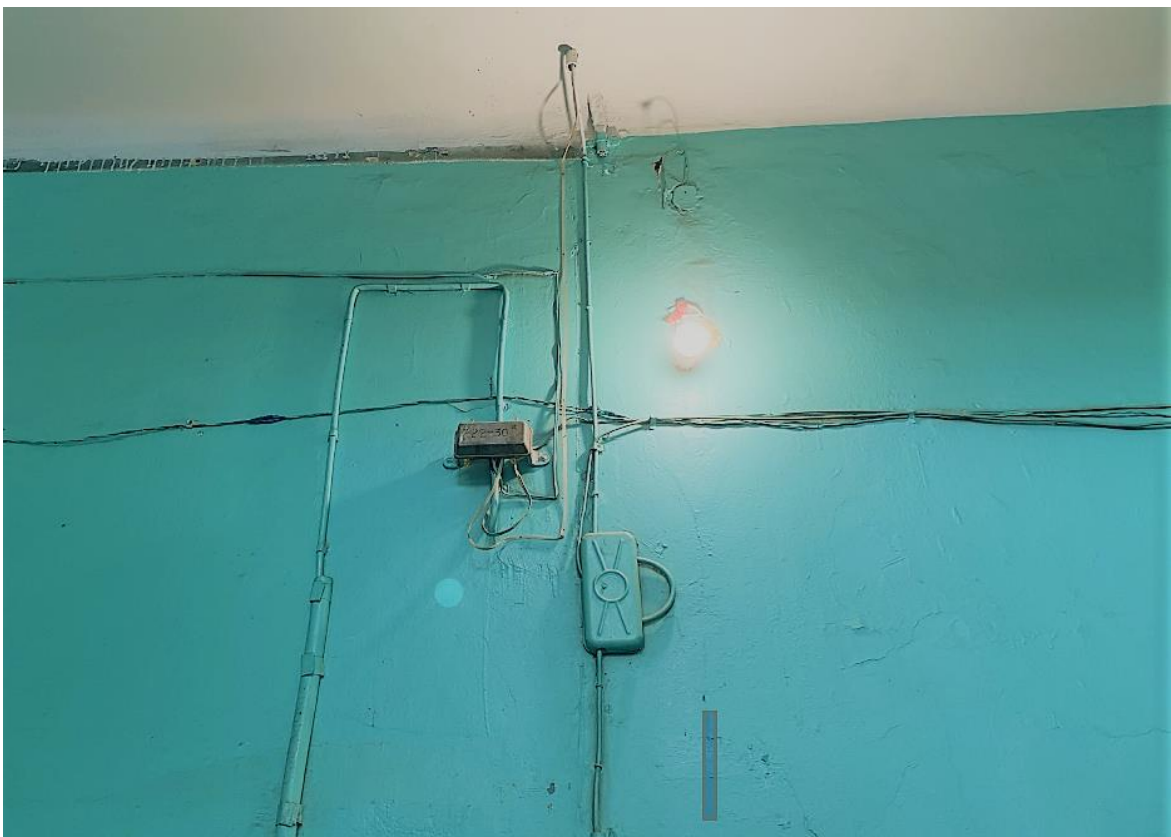
Фото 16. 3-ый этаж парадной лестницы. Расположение электропроводки по стенам с нарушением способа прокладки. Отсутствует плафон светильника. Дата съемки: 11.04.2022 г. Автор: Прокофьев М.Ф.
